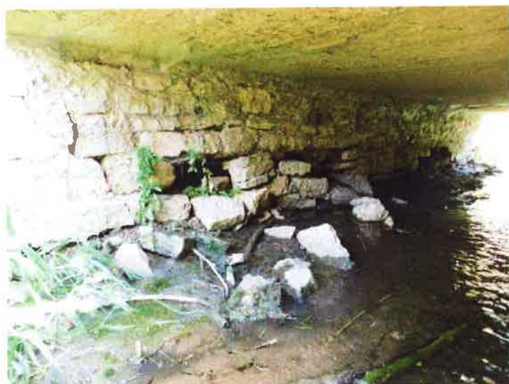
Opěra 1 - silně narušené zdivo, kaverny hl. > 0,6 m.
