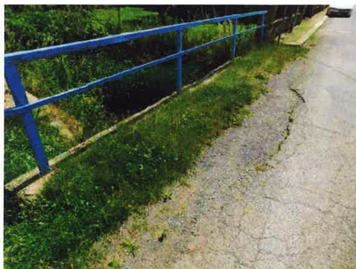
Trhliny ve vozovce. Degradace živичného krytu. Vegetace podél římsy.
