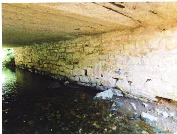
Pohled na opěru 2. Lokálně vypadané kameny. Plošně vydrolené spárování.
