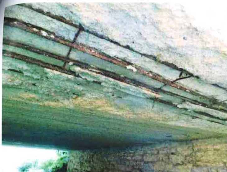
Obnažená korodující výztuž nosné konstrukce vpravo.
