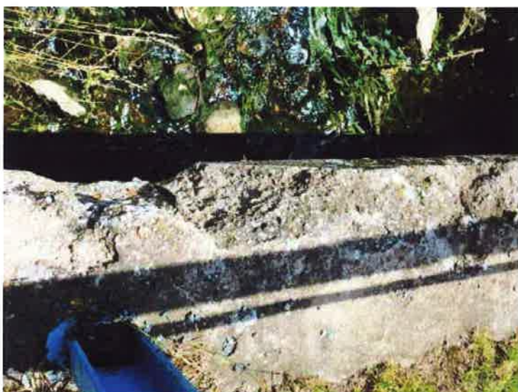
Degradace betonu římsy.
