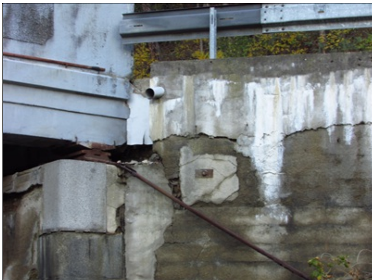
Pravé křídlo OP4 je vykloněné, zajištěné kotvou. Hlubková degradace betonu
