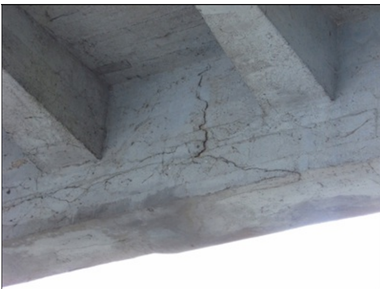
Spodní líc nosné konstrukce, trhliny
