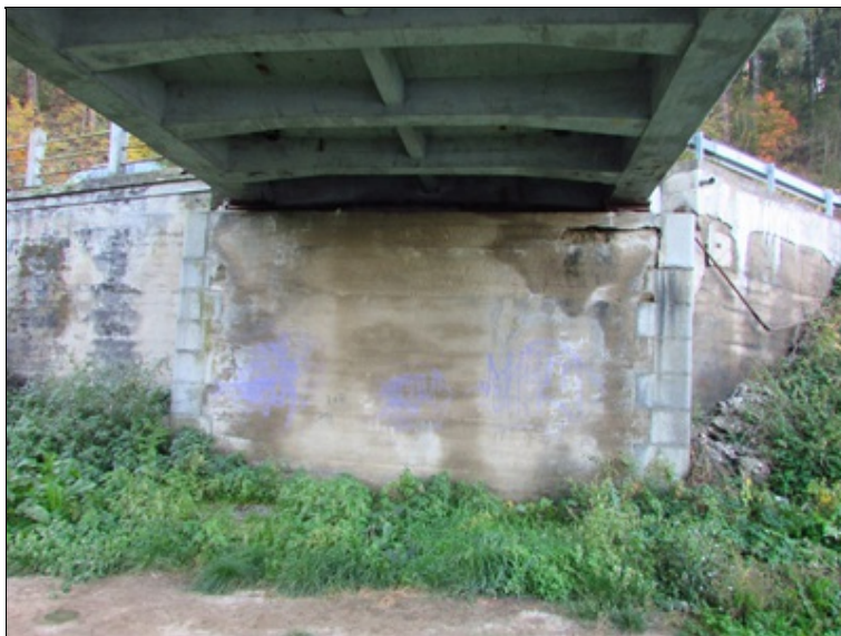
Pohled na OP4, hloubkově degradovaný beton
