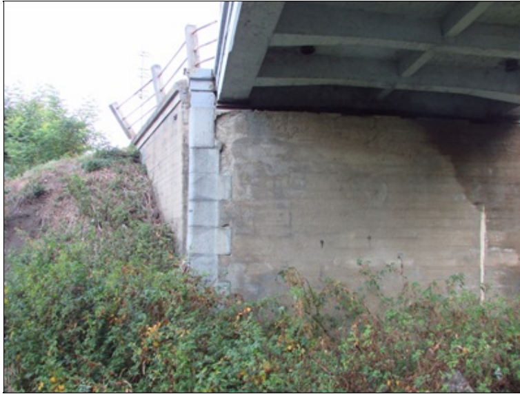
Pravé křídlo OP1 je vykloněné
