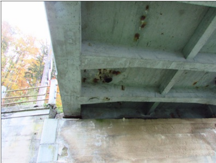
Spodní líc nosné konstrukce, 3. pole. nad korodující výztuží odšťeluje krycí vrstva betonu
