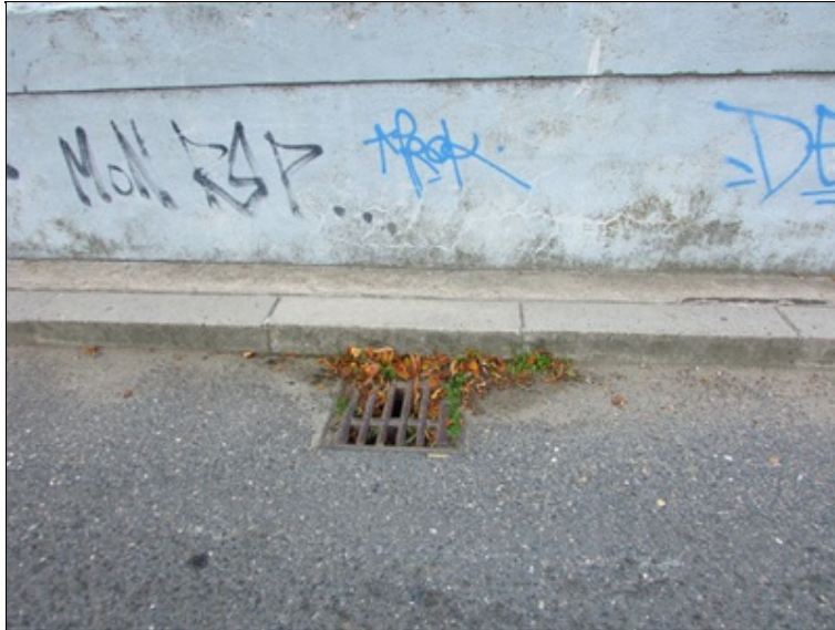
Odvodňovače jsou zanesené
