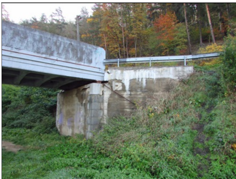
Pravé křídlo OP4. Hlubková degradace betonu
