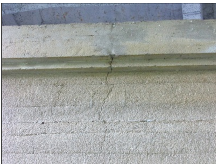
P2'3, svislá trhlina
