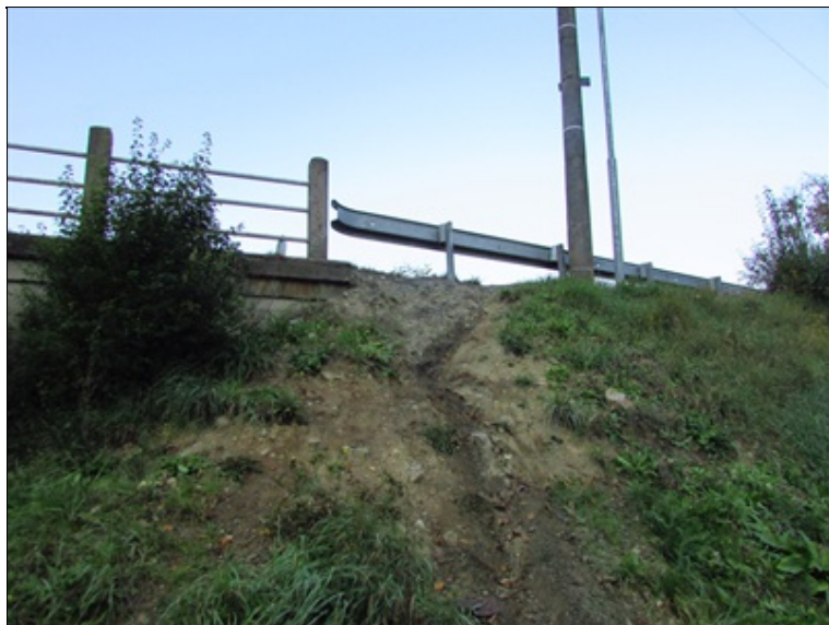
Před OP1 vlevo eroze zeminy násypu komunikace
