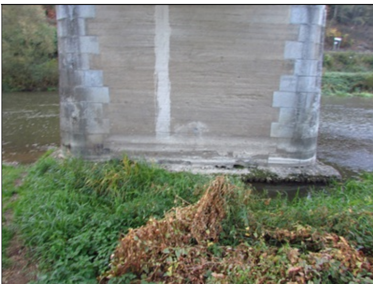
Základ P2, rozpadlý beton
