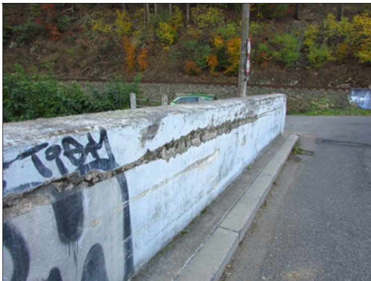
Porušený beton parapetního nosníku
