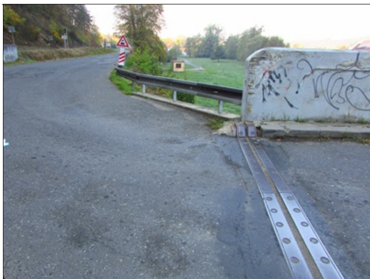
Deformace vozovky za OP4
