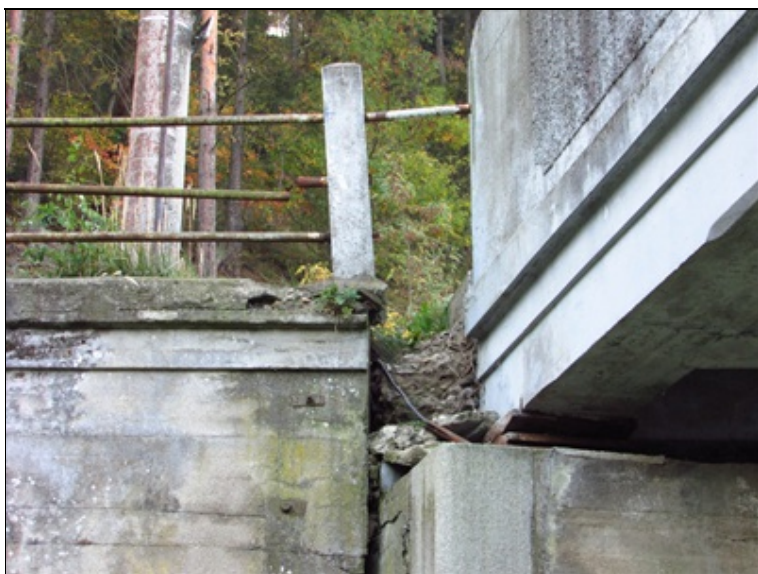
Levé křídlo OP4 je vykloněné. Rozpadlý beton závěrné zídky.
