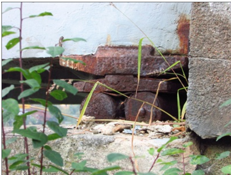
OP1, vrstevnatá koroze ložisek
