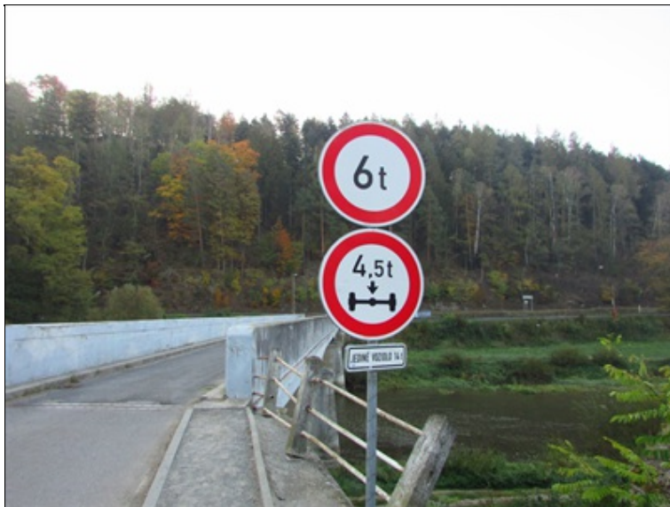
Před mostem vpravo zábradlí deformované od nárazu vozidla
