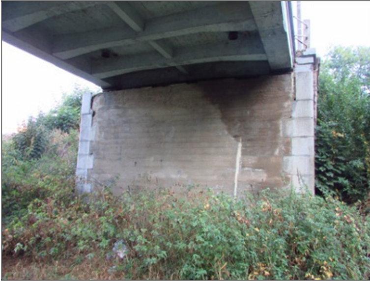
Pohled na OP1, na horní líc úložného prahu protéká voda
