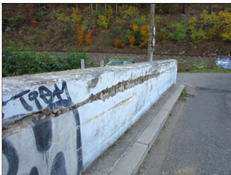
Hlavní parapetní nosník : v místě vodorovné spáry degradovaný beton.
