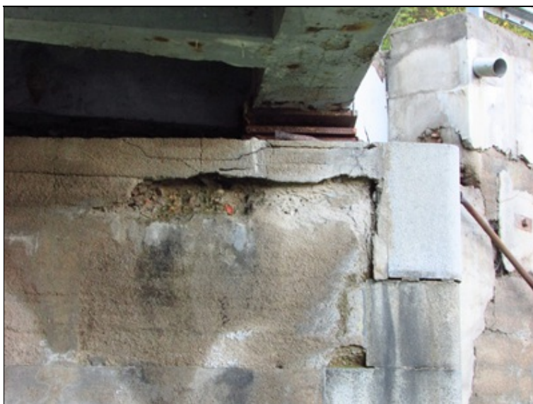
OP4 : hloubkově degradovaný beton, vrstevnatá koroze ložiska
