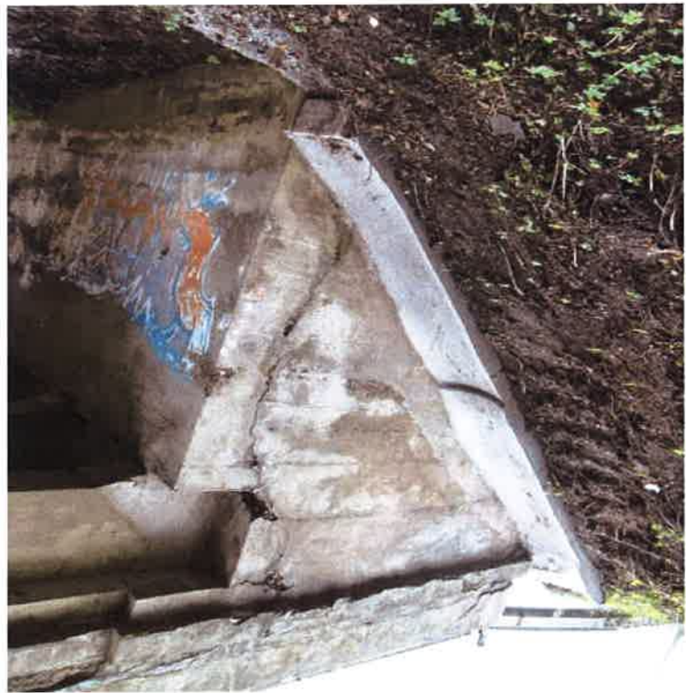
OP1 L - trhlna na boku, degradace betonu.
