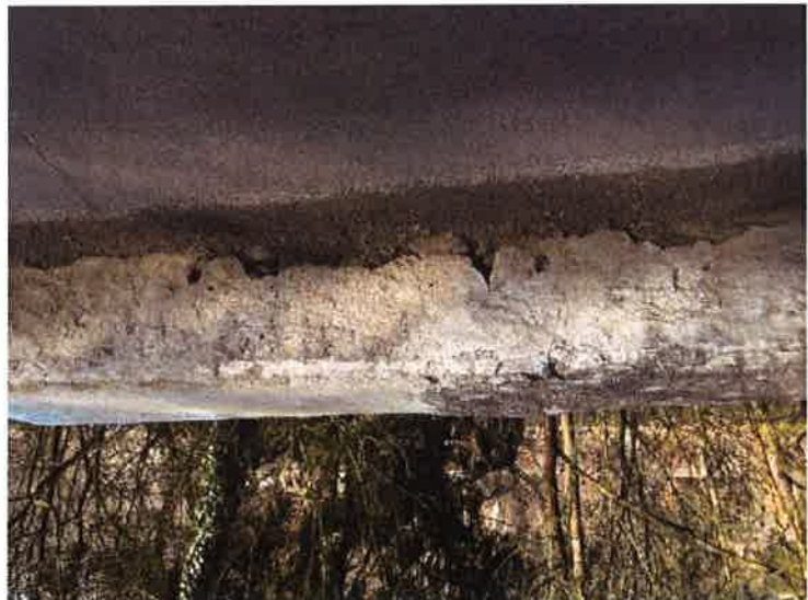
stav a poškození levé parapetní zídky
