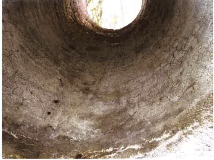
podhled NK, síť trhlin v torcretu, lokální průsaky a stopy rzi
