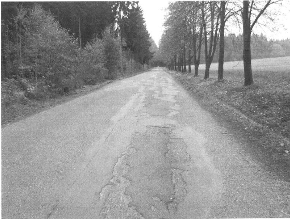
Deformace krajnic, vysprávkky
