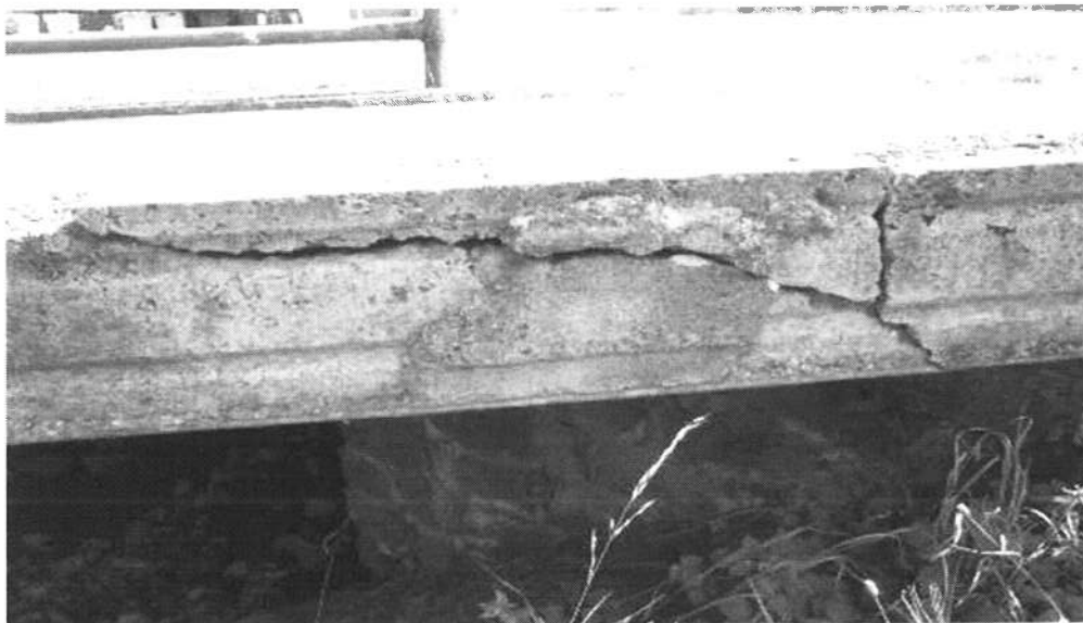
Lávka – detail smykové trhliny na nosné konstrukci
