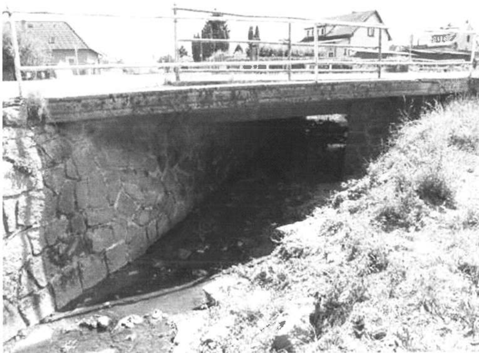
Most 191-002 – nevyhovující stav zábradlí a koryta
