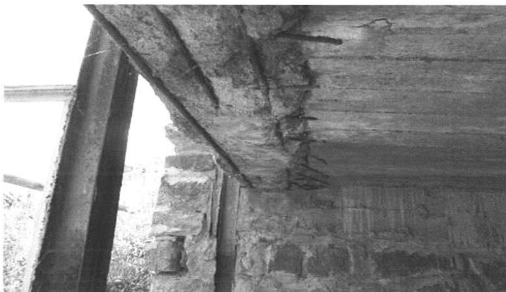
Most 191-002 – degradace mostovky
