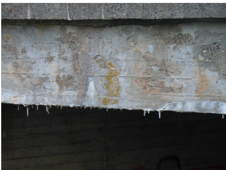
Most 337-005 Křesetice – zatékání do NK
