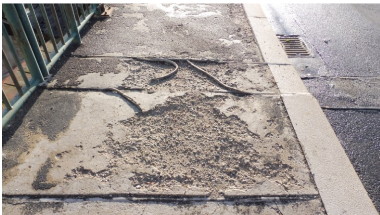
503-001 Nymburk přes ČD Detail poruchy na chodníku
