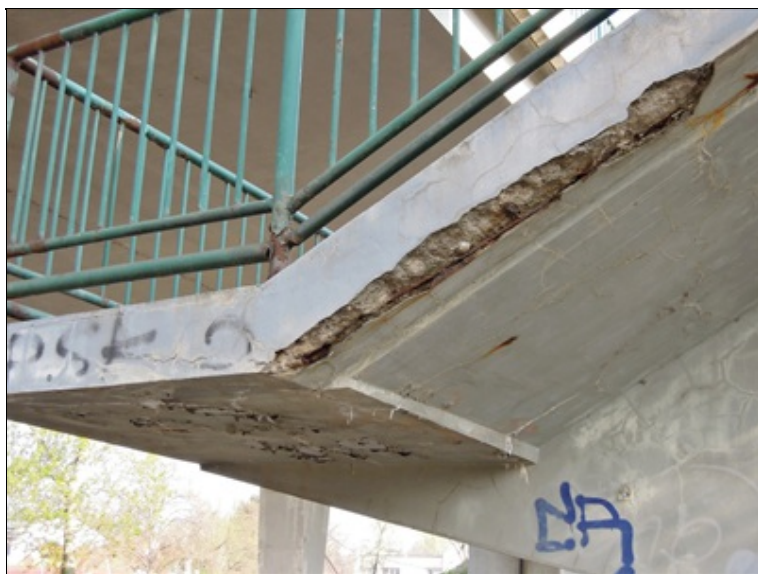
výrazné poruchy na rameni i podestě schodiště
