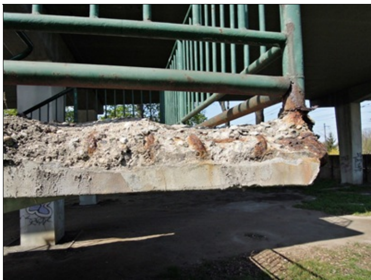
rozpad betonu podesty schodiště, koroze výztuže
