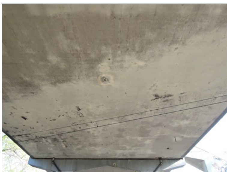
podhled 3.pole (monolit) - stopy po průsacích
