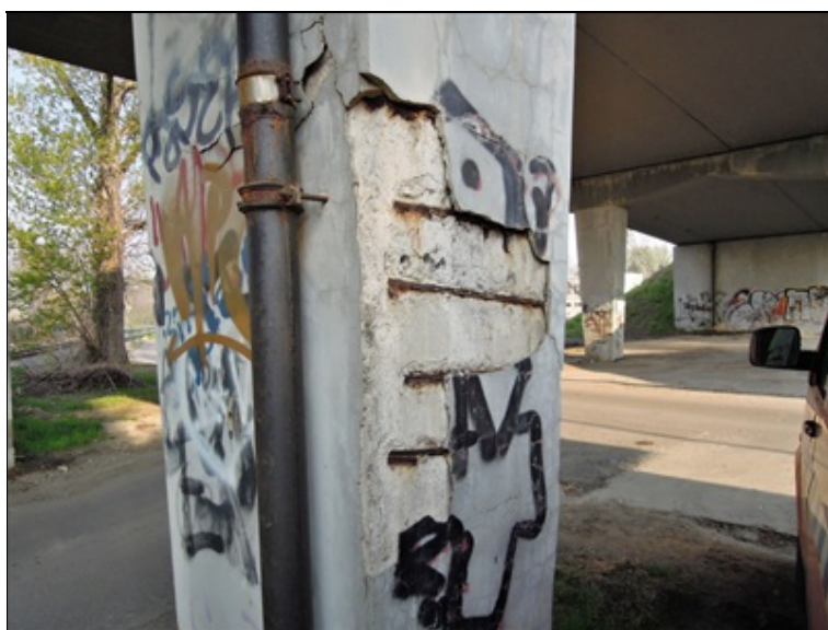
dtto na sloupu - opadávající sanace
