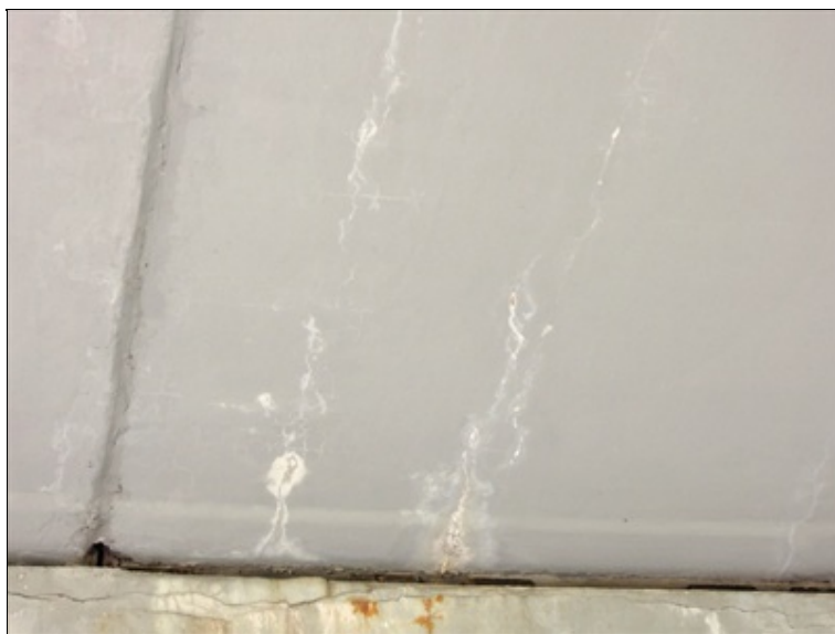
výluhy v podélné trhlině na sponím líci nosníku KA a také ve spáře mezi nosníky (opakující se závada)
