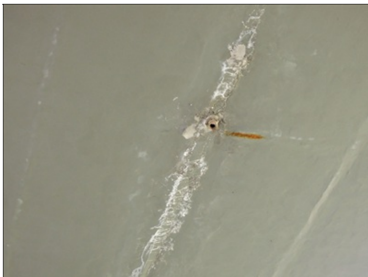
výrazné výluhy ve spáře mezi nosníky
