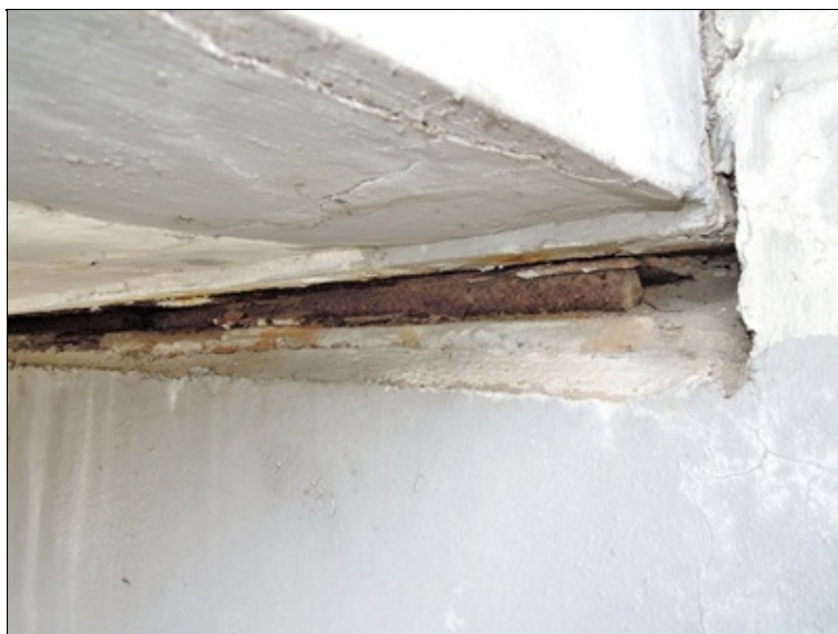
korodující válečkové ložisko
