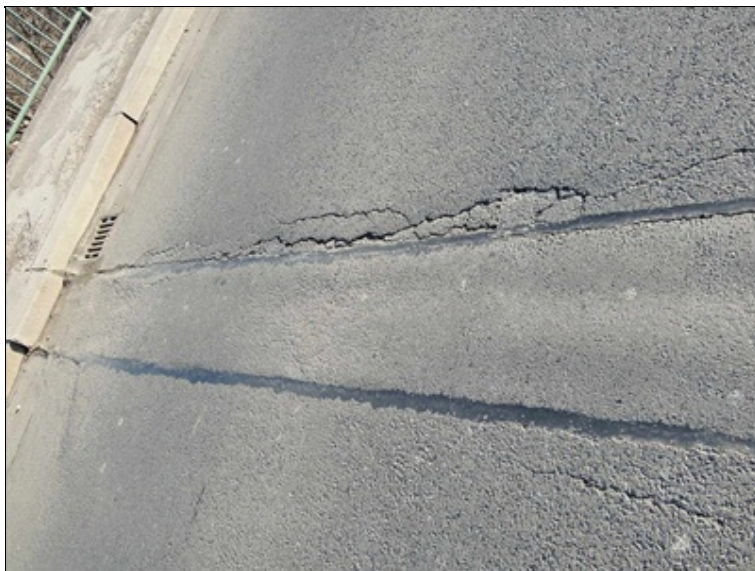
porucha mostního závěru
