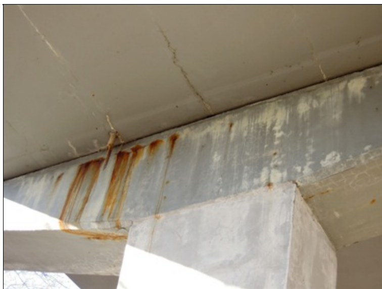
dtto - výrazné topy rzi od korodující výztuže
