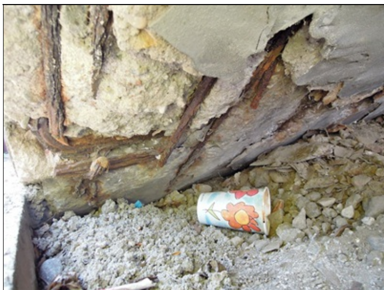
dtto - detail koroze výztuže na spodním líci ramene schodiště
