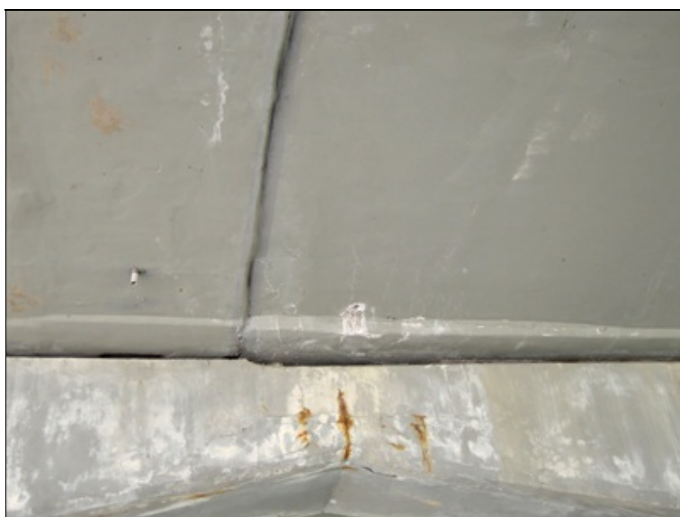
stopy po zatékání na pilíř
