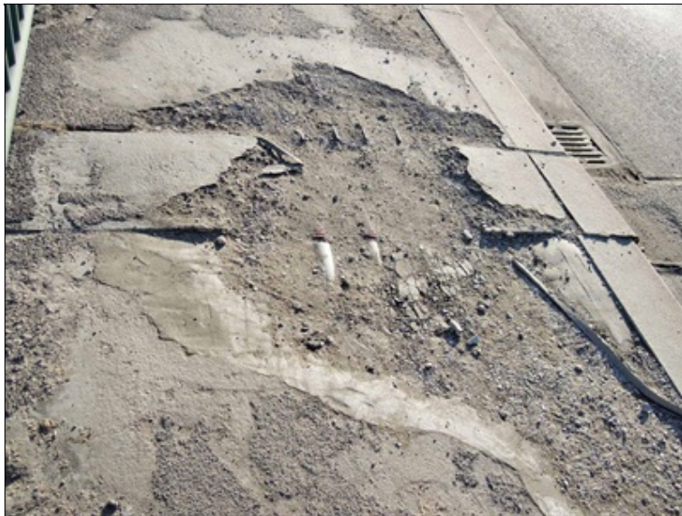
rozpad chodníku v místě dilatační spáry
