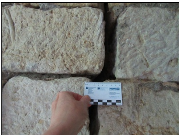
Horní otvor LS pohled směrem k OP2 Průběžná trhlina rozevřená za obetonováním portálu Měření š. trhliny
