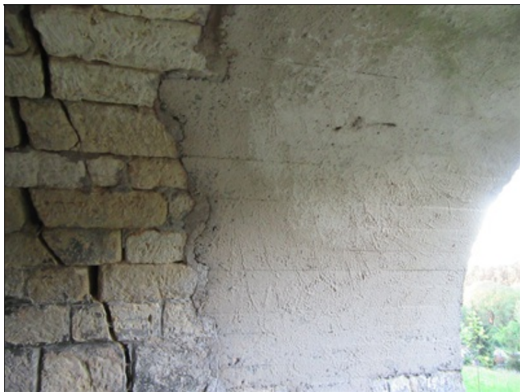
Horní otvor LS pohled směrem k OP1 Průběžná trhlina rozevřená za obetonováním portálu
