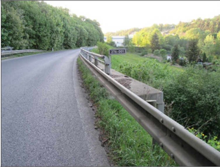
Pohled na levou římsu, porosty mechů na povrchu
