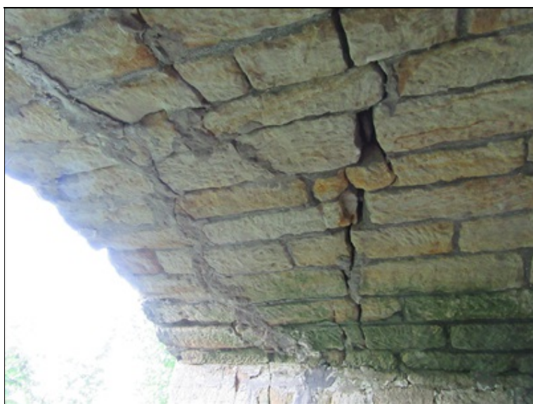
LS Pohled na směrem k OP2 pokračování trhlin do stropní části- zde široce rozevřené
