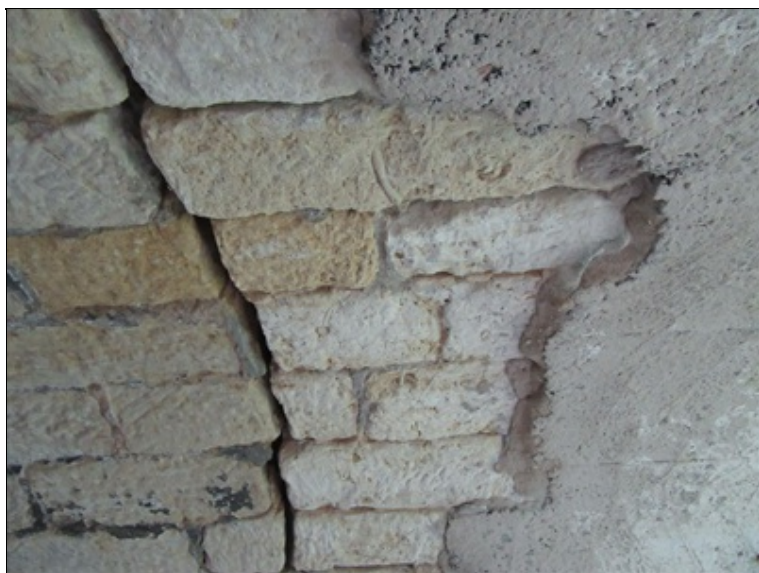
Horní otvor LS pohled směrem k OP1 Průběžná trhlina rozevřená za obetonováním portálu
