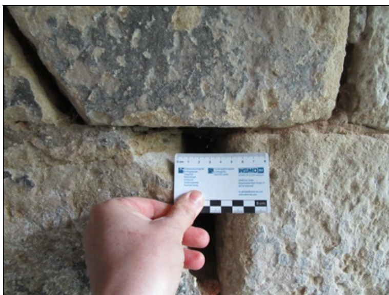
Horní otvor LS pohled směrem k OP1 Průběžná trhlina rozevřená za obetonováním portálu Měření š. trhliny
