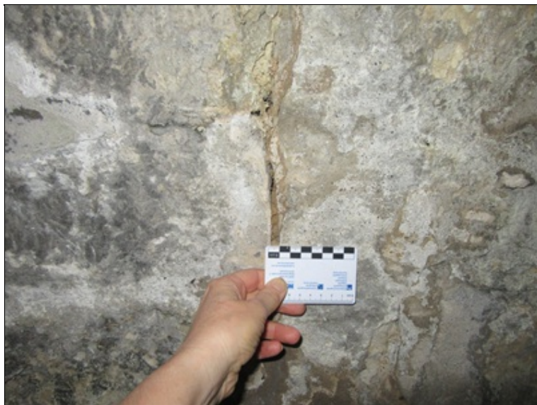
Horní otvor PS pohled směrem k OP2 Průběžná trhlina rozevřená za obetonováním portálu Měření š. trhliny
