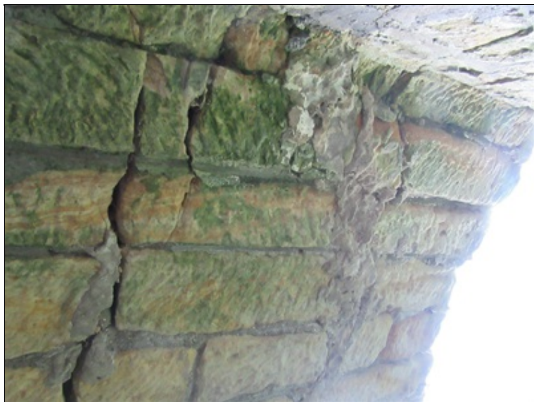
Pohled na OP1 rozevřené trhliny v opěře
