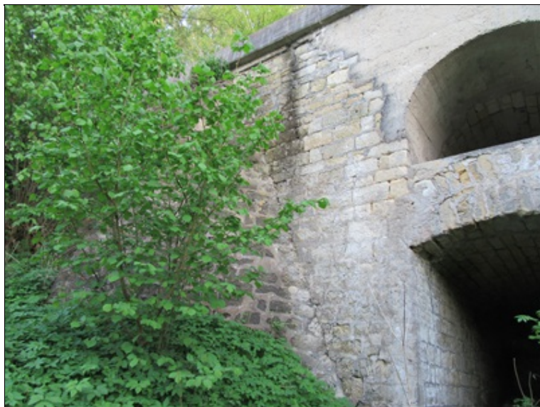
LS pohled na OP2 průsaky pod římsou
