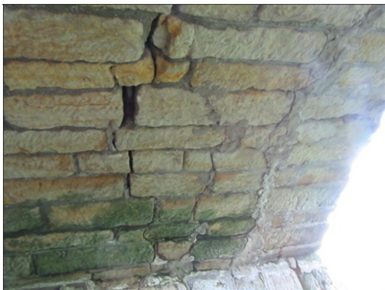
Pohled na OP1 pokračování trhlin do stropní části
