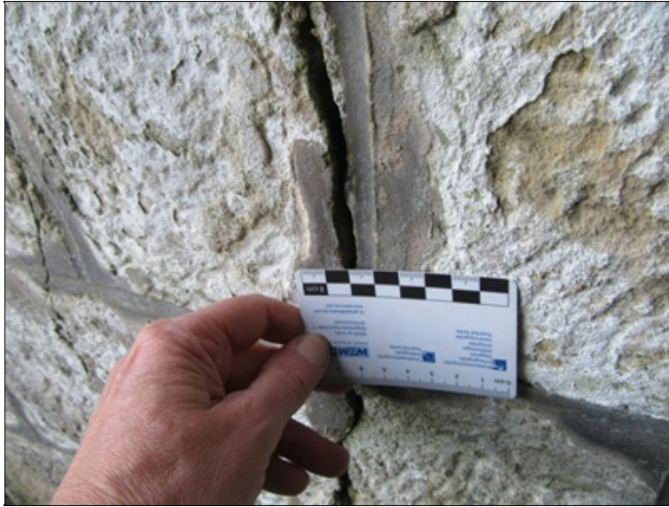
Měření š. rozevření v opěře OP2
