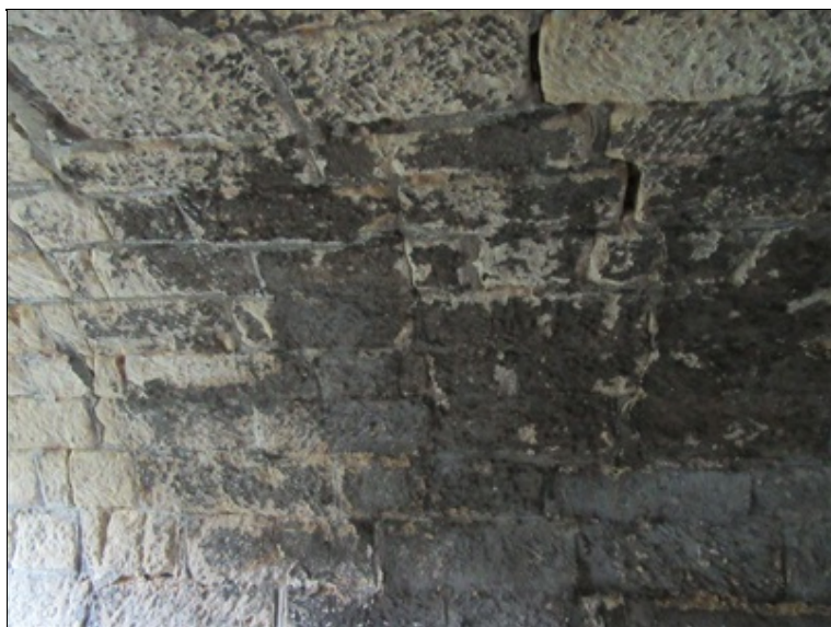
Horní otvor LS pohled směrem k OP2 Průběžná trhlina rozevřená uvnitř tubusu
