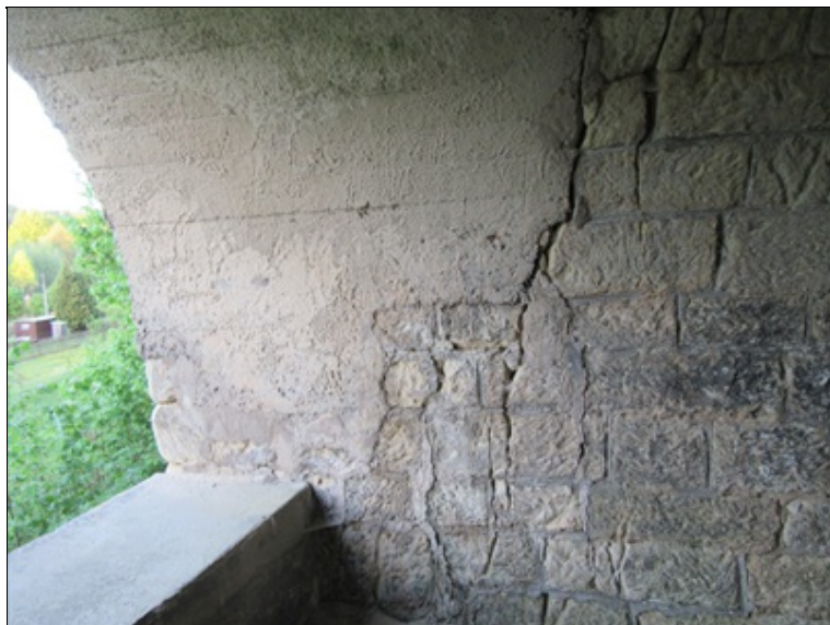
Horní otvor LS pohled směrem k OP2 Průběžná trhlina rozevřená za obetonováním portálu
