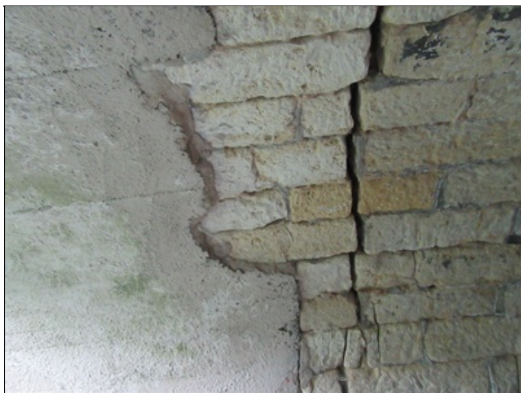
Horní otvor LS pohled na strop Průběžná trhlina rozevřená za obetonováním portálu
