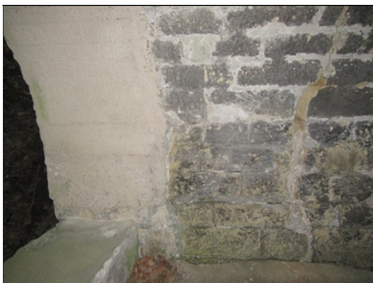
Horní otvor PS pohled směrem k OP1 Průběžná trhlina rozevřená za obetonováním portálu
