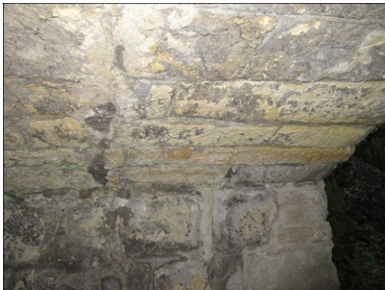
PS pohled na stropní část směrem k OP2 patrné trhliny
