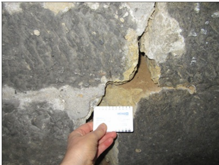
Horní otvor PS pohled směrem k OP1 Měření š. trhliny
