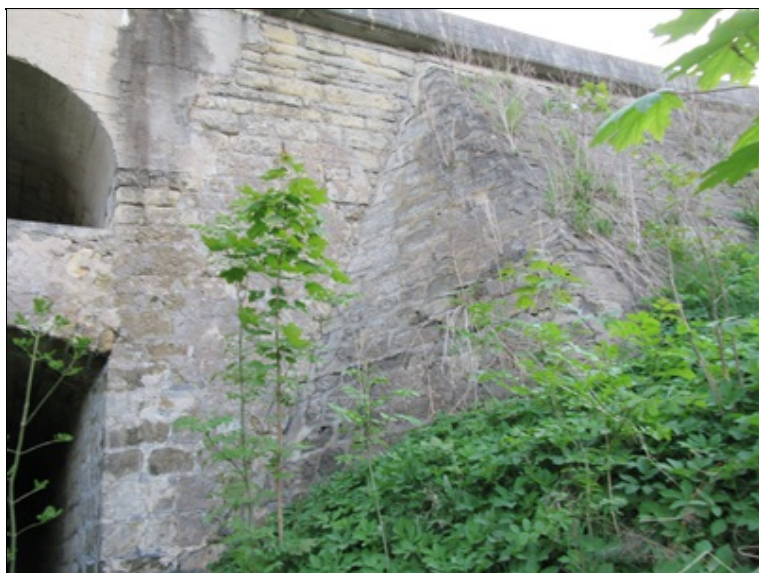
LS pohled na OP2 silné zatékání pod římsou, výluhy pojava
