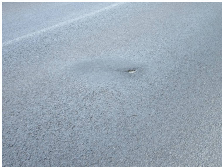
Pohled na pravý jízdní pruh - nerovnosti, prohlubeň s výtlukem,
