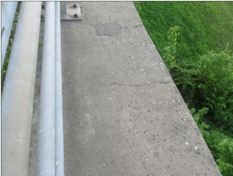
Pohled na levou římsu, příčné trhliny
