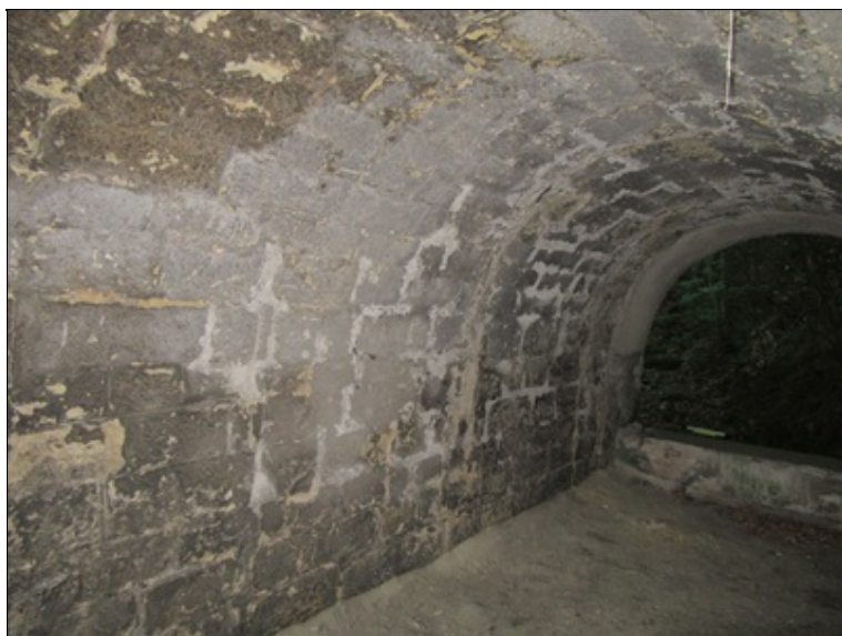
Horní otvor PS pohled směrem k OP2 Průběžné trhliny uvnitř tubusu
