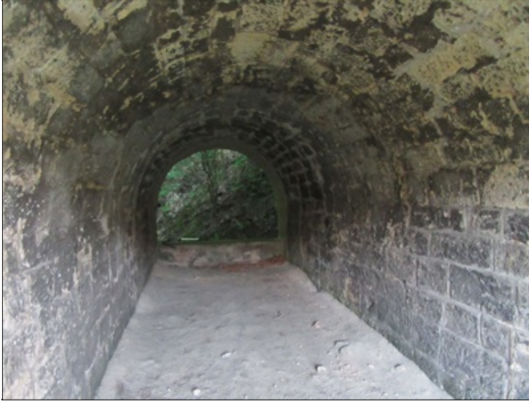
Horní otvor pohled směrem k PS Průběžná trhlina uvnitř tubusu
