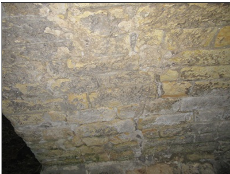
PS pohled na stropní část směrem k OP1 patrné trhliny
