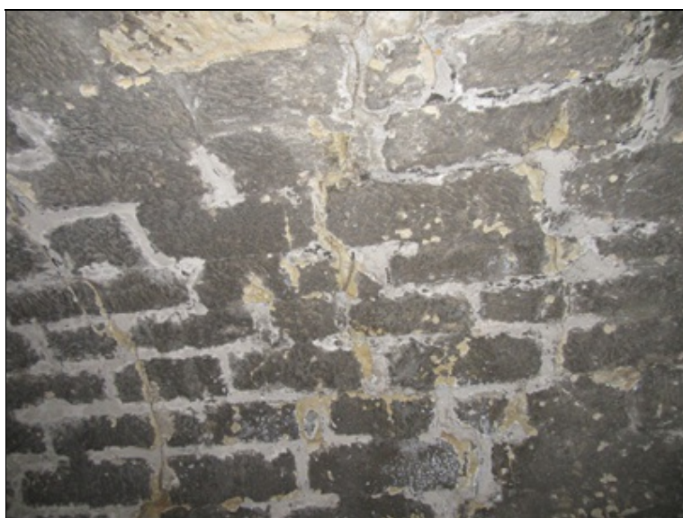
Horní otvor PS pohled směrem k OP2 Průběžná trhlina rozevřená za obetonováním portálu
