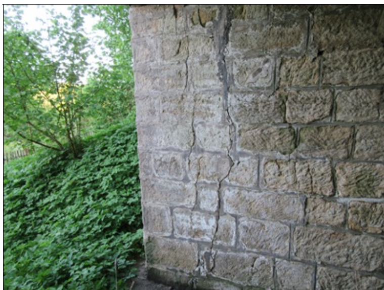
Pohled na OP2 zleva Svislá trhlina od paty po horní část opěry
