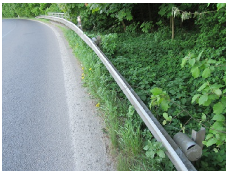
PS předpolí mostu poškozené svodidlo od nárazu
