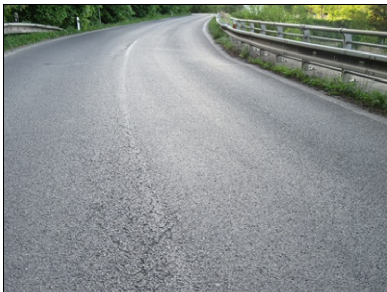
Pohled proti směru staničení síťový rozpad podél středové spáry
