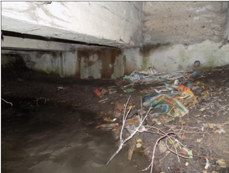
Zatékání na úložné prahy opěr.
