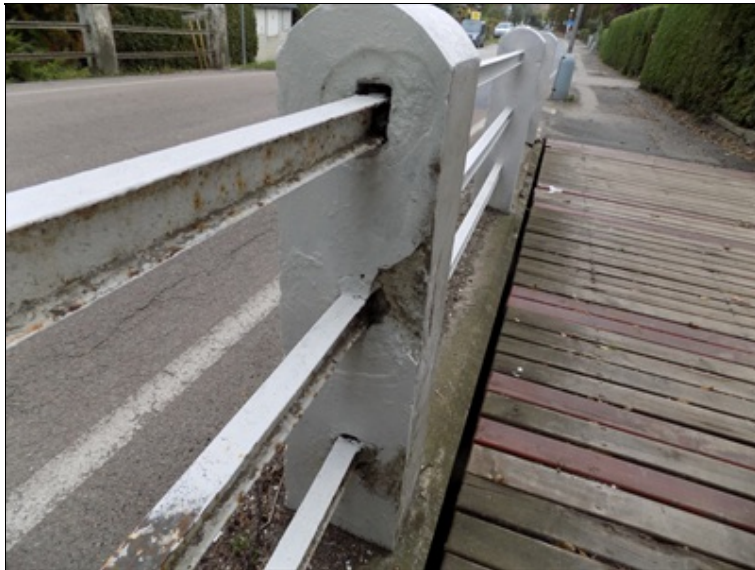
Poškozený sloupek zábradlí.
