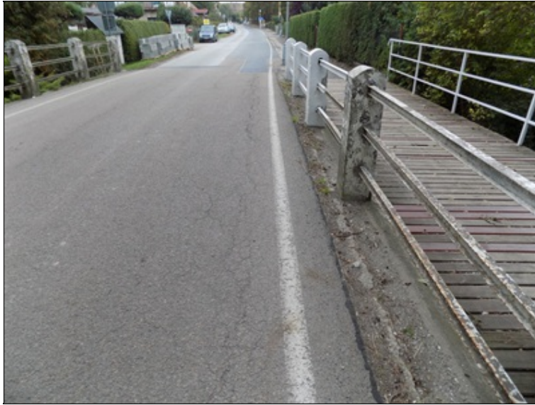
Podélné trhliny ve vozovce u levé krajnice.
