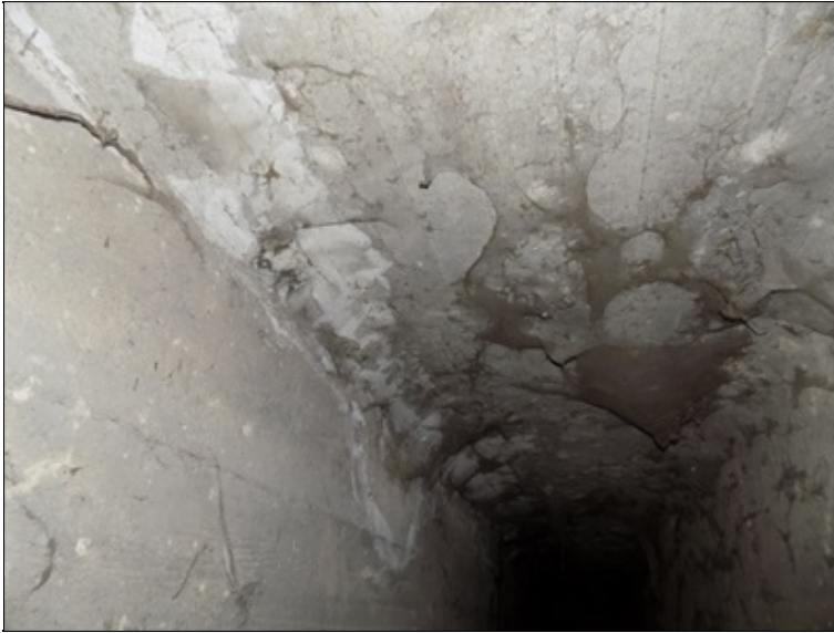
Průsak u spáry mezi pravým nosníkem a deskou mostovky.
