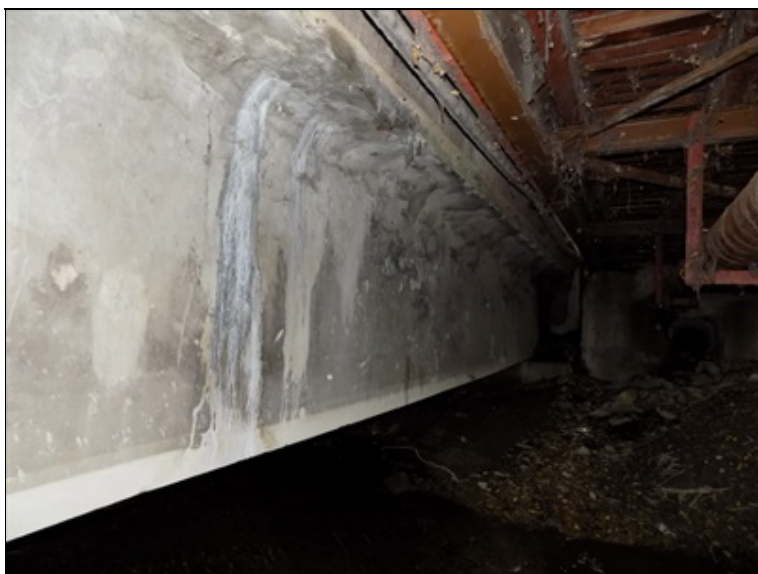
Průsak s výluhem na levém nosníku.
