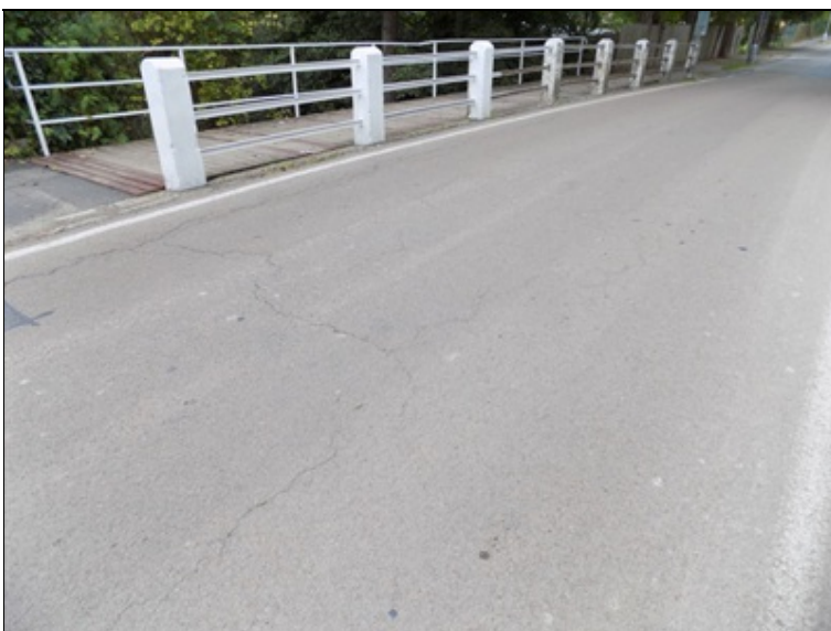
Příčné trhliny ve vozovce na předmostí O1.
