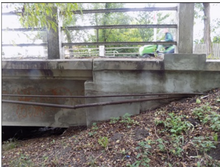
Poškozené upevnění a chráničky inž. sítí.
