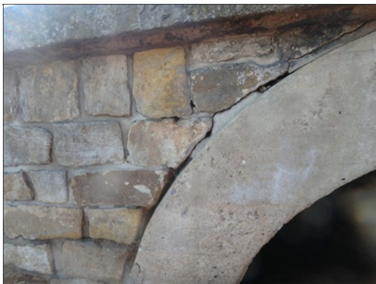
Degradace spárové malty čela.
