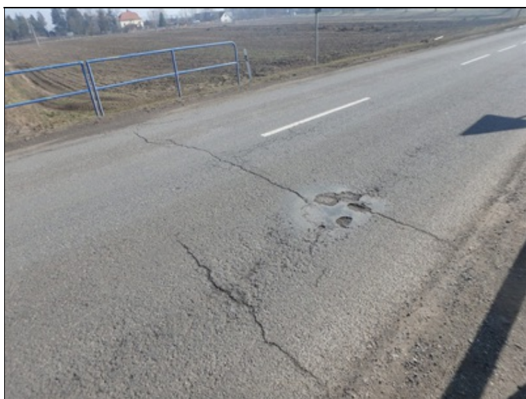
Trhliny a výtluky v krytu vozovky.
