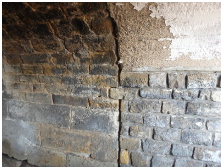
Degradace klenby - kamenů i betonu.
