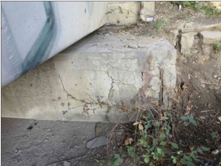
rozpad betonu na levém boku O1
