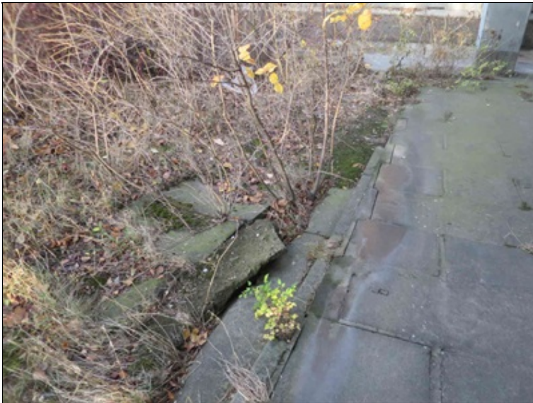
rozpad odvodňovacích skluzů
