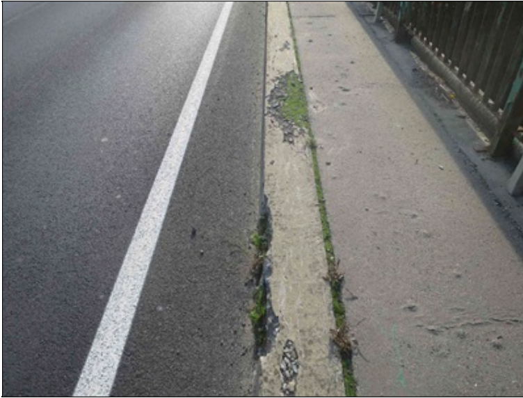
rozpad betonu obruby
