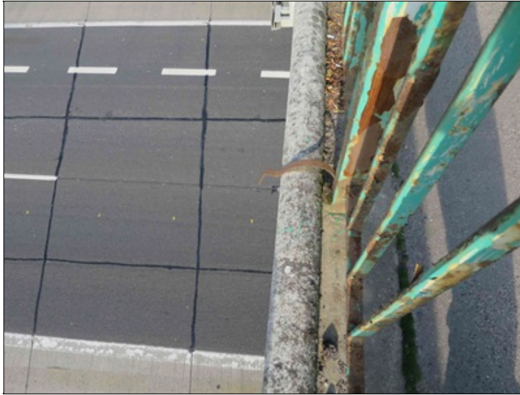
uvolněné kotvení chráničky
