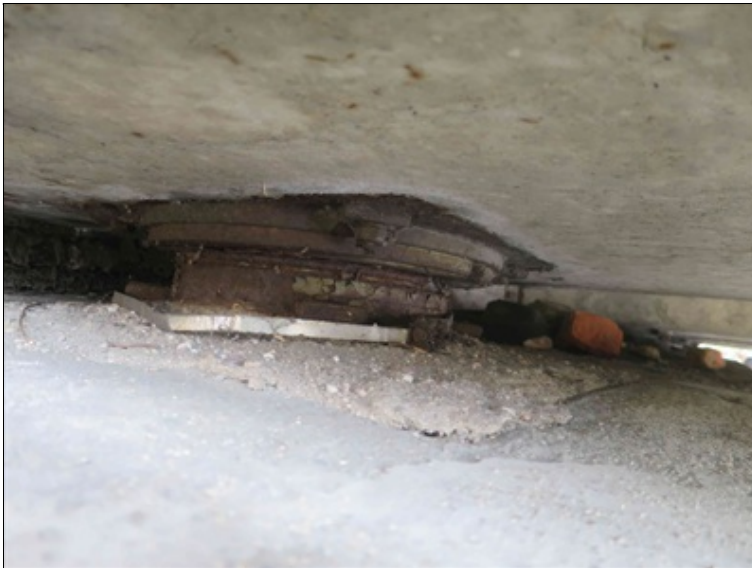
totální koroze ložiska na O1
