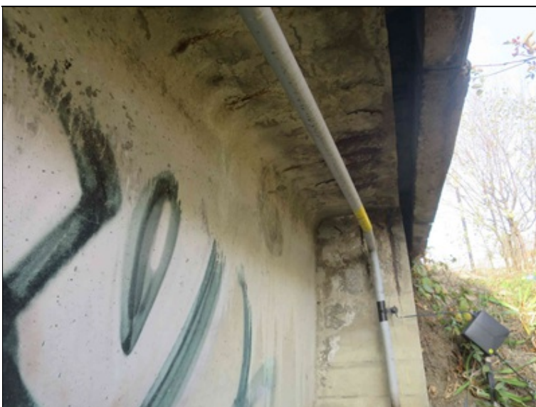
pod levou konzolou je převáděna IS degradace betonu levé konzoly NK
