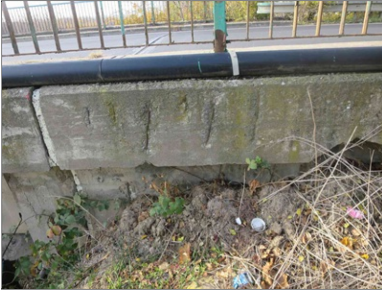
degradace betonu římsy, koroze obnažené výztuže
