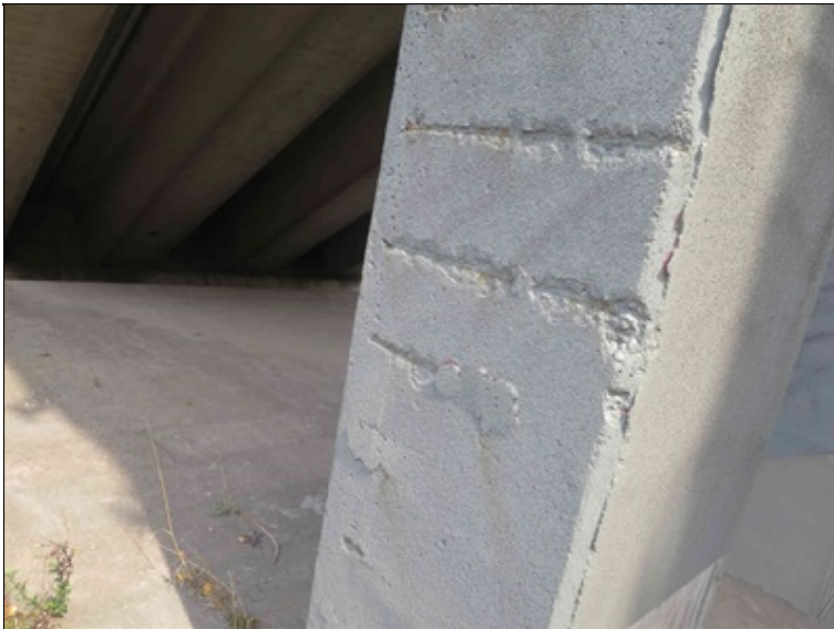
nekvalitně provedená sanace vrypěry v místě obnažené korodující smykové výztuže
