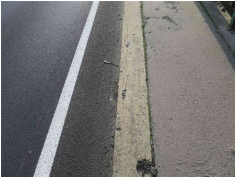
trhliny v obrubě jsou způsobeny mrazovým rozpadem
