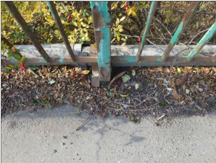
totální koroze sloupku zábradlí v místě kotvení do římsy
