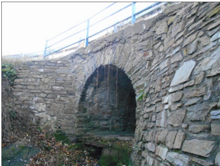
Pohled na pravý bok mostu -v klenbě stopy zatékání, římsa polorozpadlá .JPG
