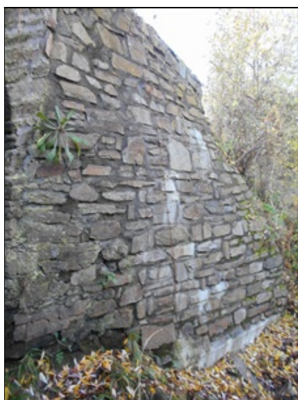
Pravé křídlo O2-svislá trhлина ve zdivu, porucha zdiva v úrovni terénu.JPG
