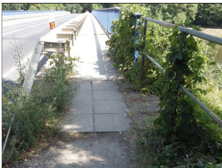
Výrazně vzrostlá vegetace na předmostí opěry OP1.
