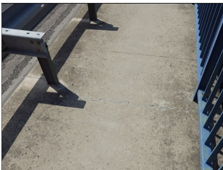
Chodník/římsa - příčná trhlina zatěsněna tmelem
