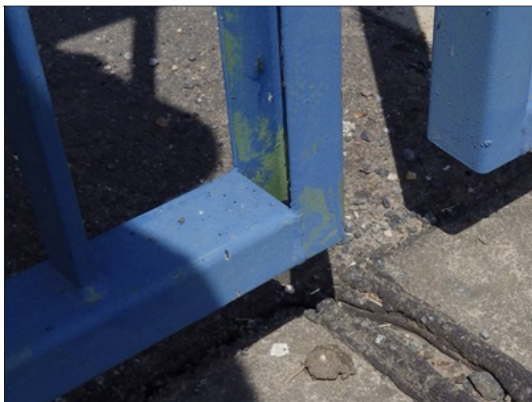
Zábradlí - lokální odlupování vrchní vrstvy PKO.
