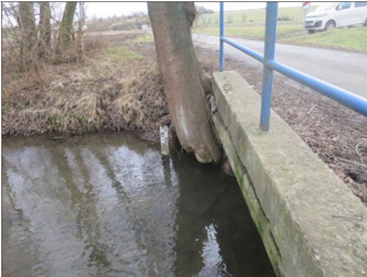
strom vlevo u O2 je příčinou posunu římsy
