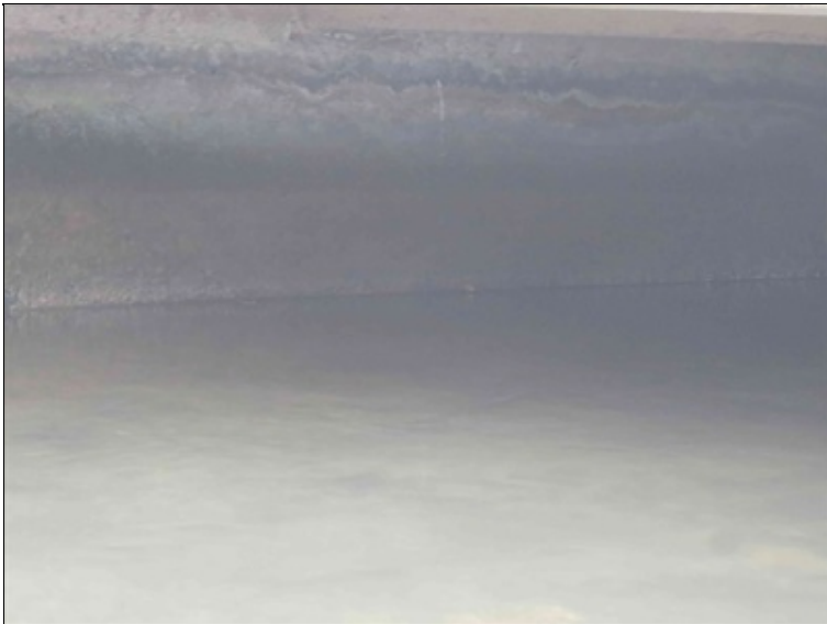
degradace betonu O1
