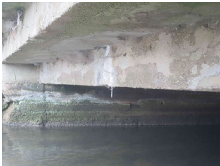
levý bok NK, stopy po průsacích, degradace betonu O2
