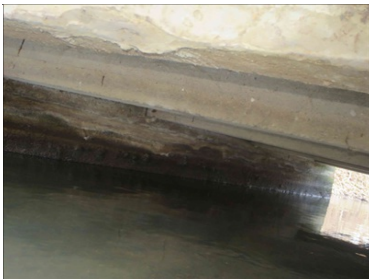
výrazné stopy po průsacích na líci O2, lokální koroze obnažené konstrukční výztuže trémového roštu
