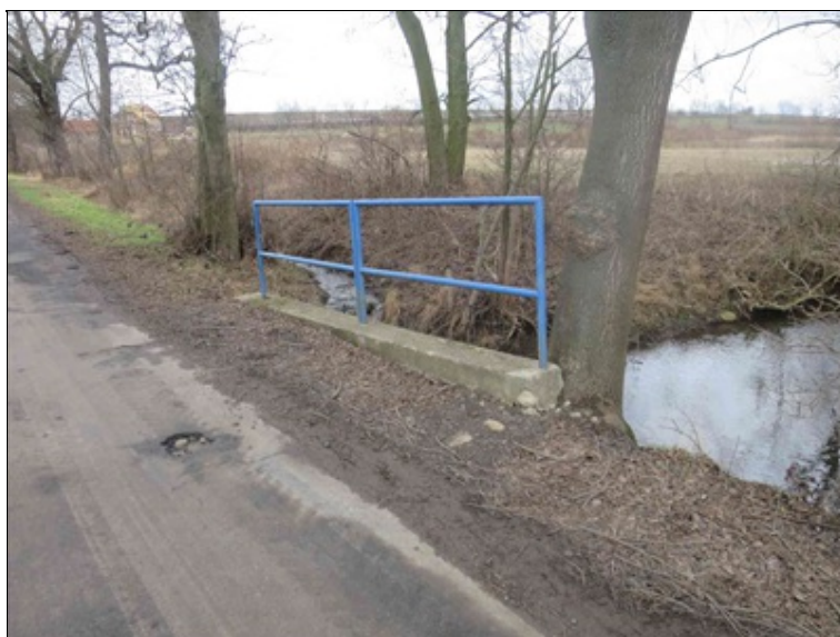
levé zábradlí a výtluk ve vozovce
