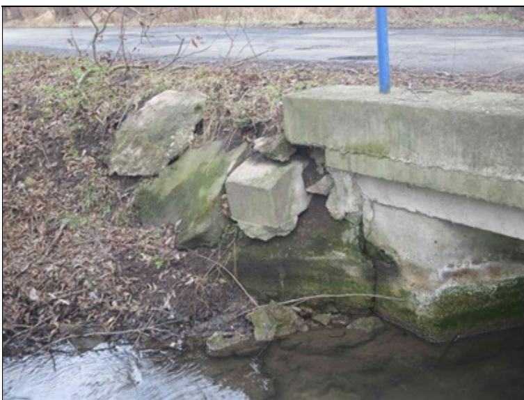
rozpad pravého křídla O1
