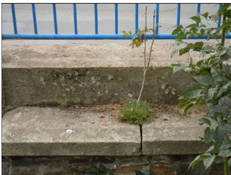
Římsa nad opěrou 3 , vegetace
