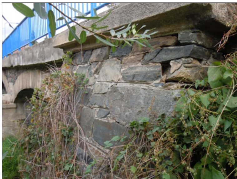
Rozvolněné zdivo křídla opěry 3
