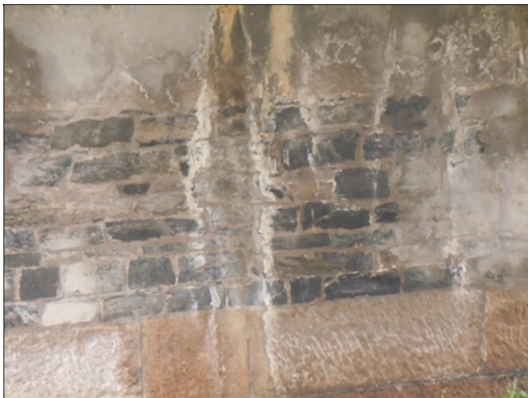
Výluhy na dřívku pilíře z pole 2
