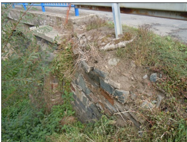
Degradace křídla opěry 3 vpravo
