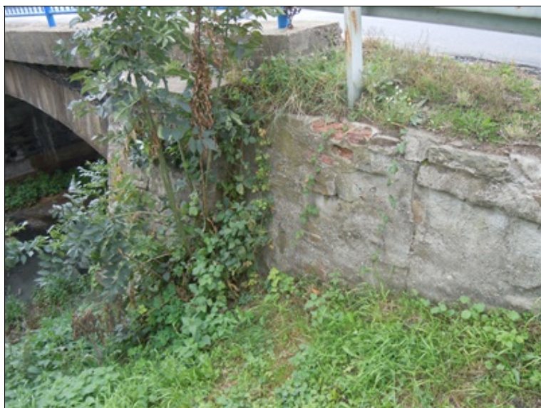
Křídlo opěry 3 vpravo, vegetace
