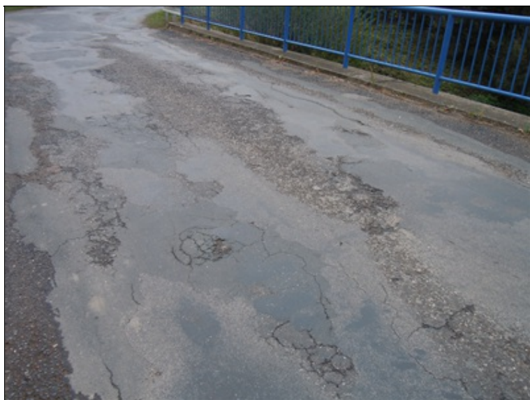
Výtluky a nerovnosti ve vozovce
