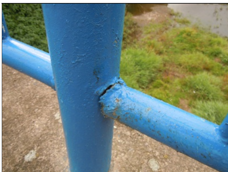
Utržené spodní madlo zábradlí
