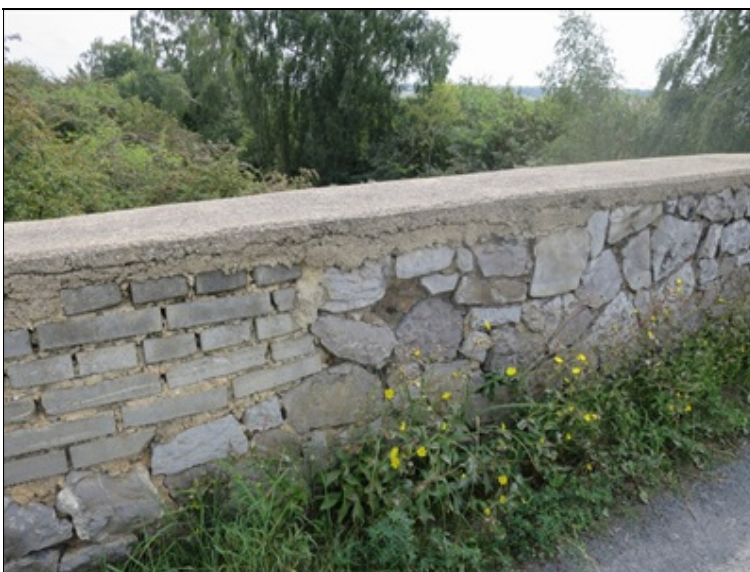
poruchy zdiva parapetní zídky, vegetace na vozovce podél zídky
