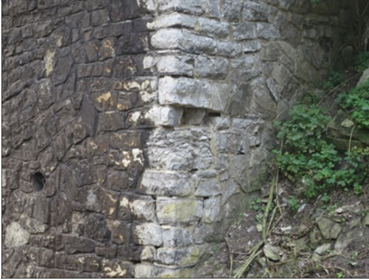
poruchy zdiva v levé hraně O1
