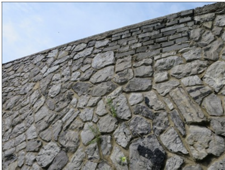
detail stavu zdiva pravé parapetní zdi
