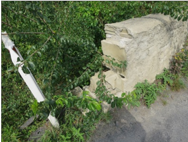
detail rozpadu čela levé parapetní zídky před O1
