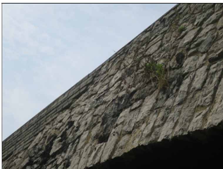
v obtížně přístupných místech pravého boku klenbového pasu a pravé poprsní zdi jsou výrazné poruchy (vyplavené spárování, uvolněné kameny, uchycená vegetace).
