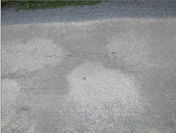
trhliny v krytu vozovky
