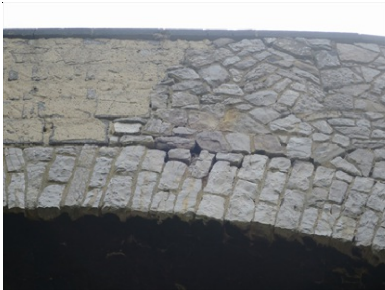
v oblasti navázání levé poprsní zdi na klenbový pás jsou významné poruchy (vyplavené spárování, dochází k uvolňování kamenů ze zdiva)
