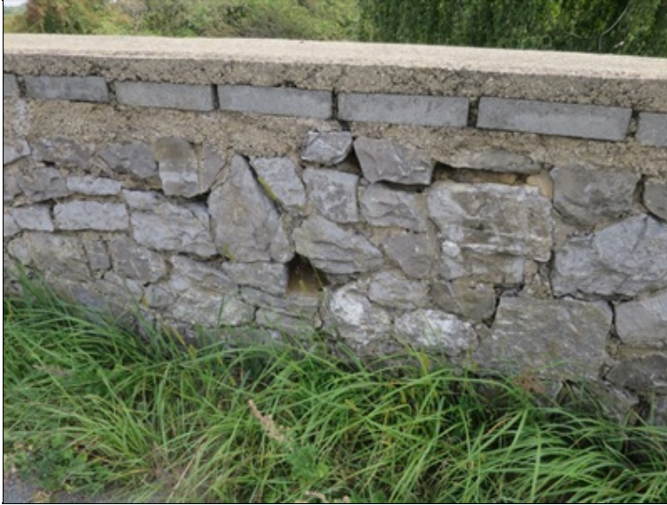
poruchy pravé parapetní zídky jsou intenzivní v celé její délce
