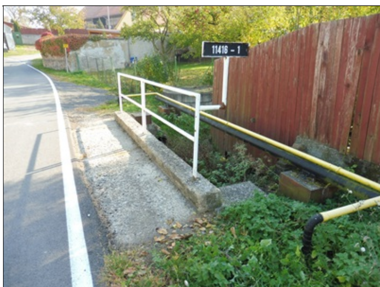
Na chrániče na pravé římse koroze.
