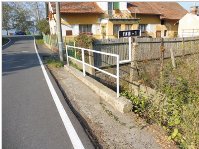
Na chrániče na pravé římse koroze.
