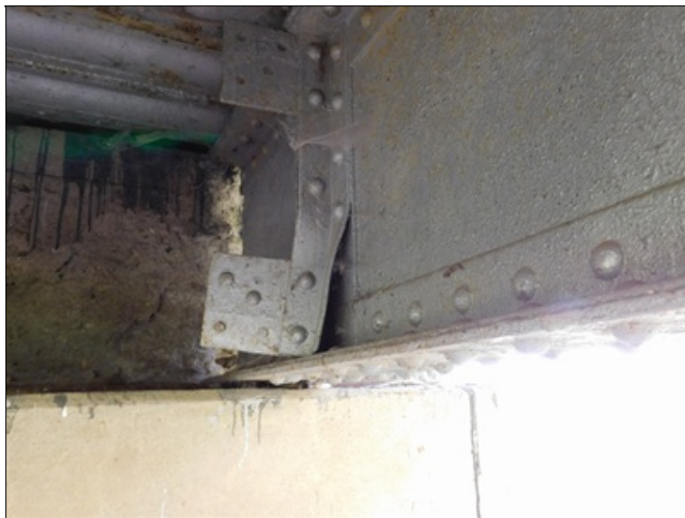
Deformace z doby výstavby
