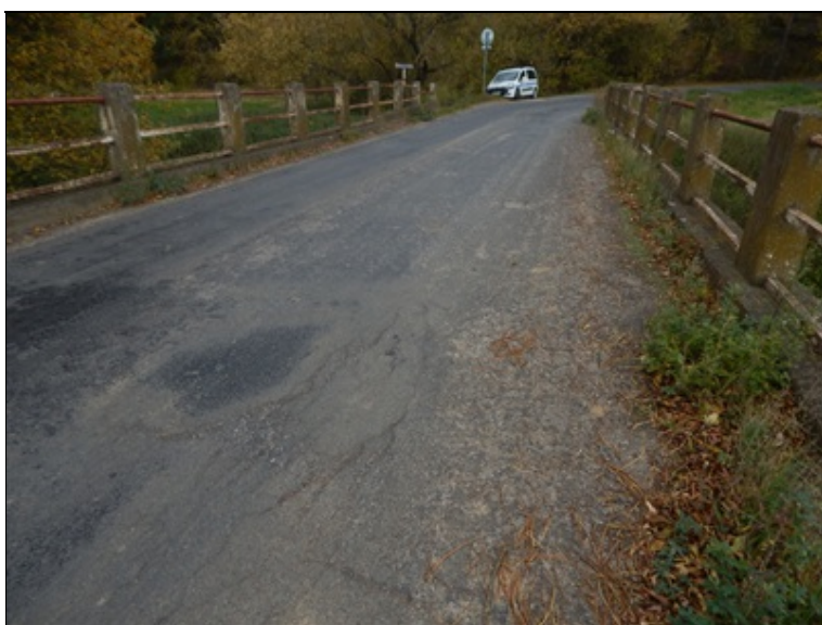
Stav vozovky - vyjeté koleje, trhliny
