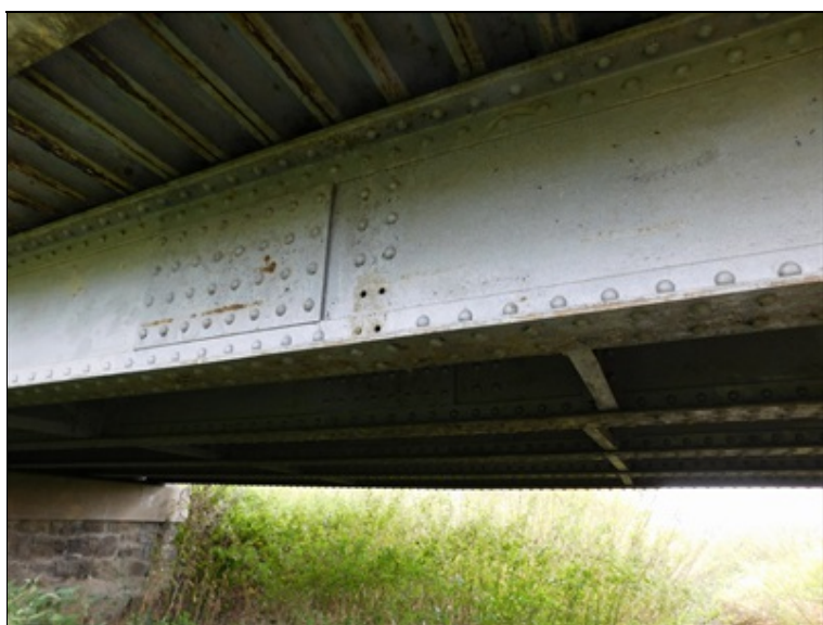
Bok krajního ocelového nosníku, nevyužitá otvory pro nýty v místě ztužidla
