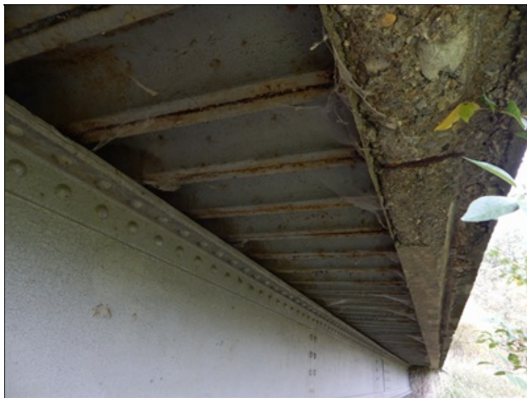
Podhled pravé konzoly, odpadlá krycí vrstva betonového římsového trámu
