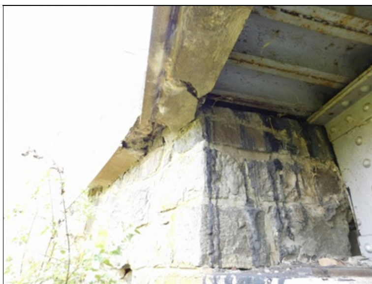
Stav levé římsy nad opěrou 2, trhliny v závěmě zídce
