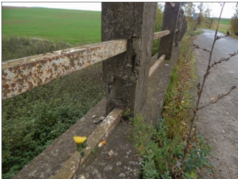
Rozpadlé sloupky na pravé straně, koroze madel, vegetace na krajnici.
