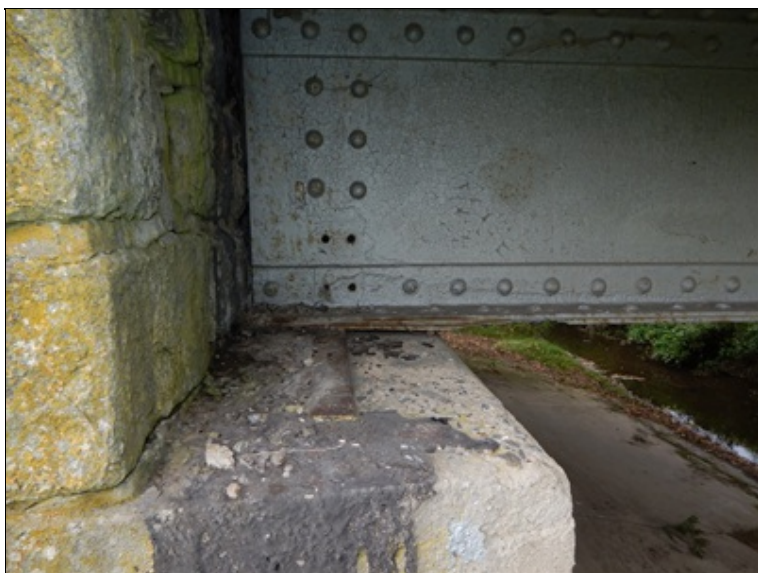
Úložný práh opěry 1, oslabená dolní pásnice pravého nosníku
