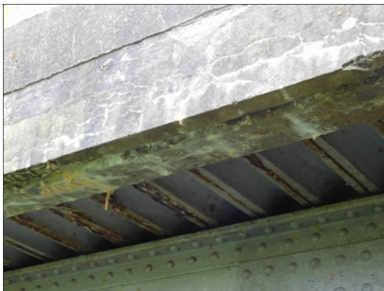
Podhled levé konzoly, výluhy na spodním líci betonové římsy
