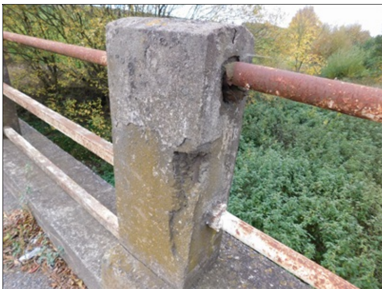
Odražená hrana sloupku, přezlé a uvolněné horní madlo
