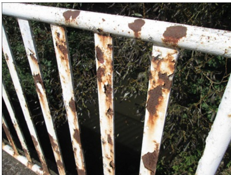
IMG_8759.JPG Koroze zábradlí
