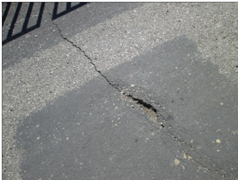
IMG_8758.JPG Trhlina ve vozovce
