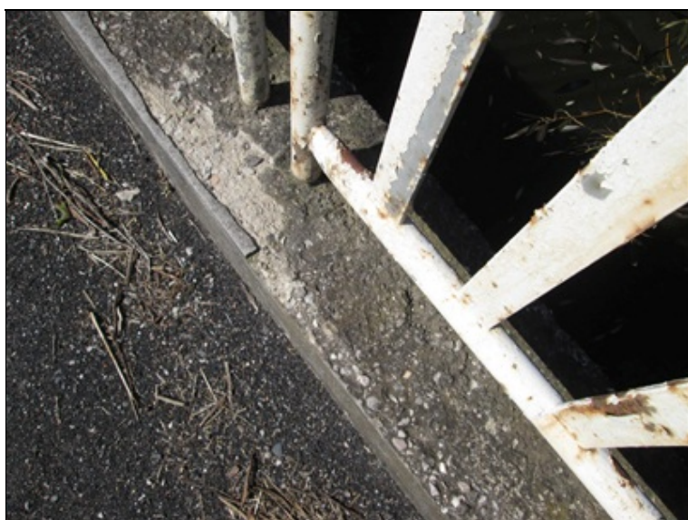
IMG_8760.JPG Degradace betonu římsy.
