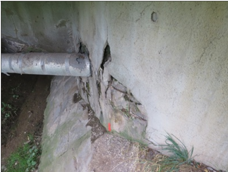
stopy po průsacích dřikem opěry 3 v místě průchodu chráničky IS
