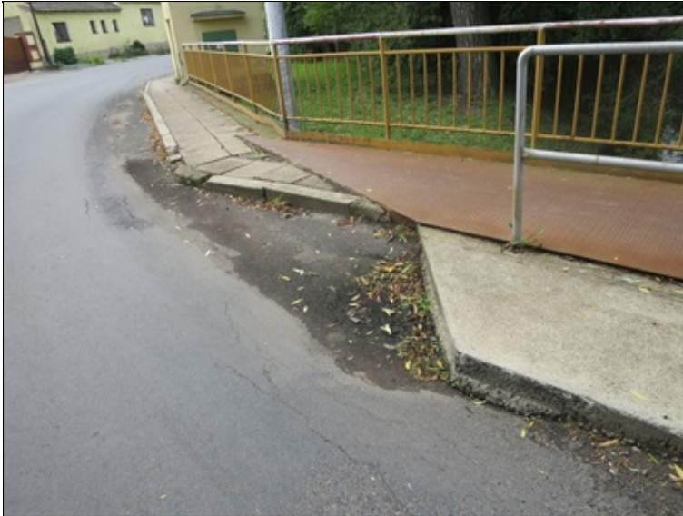
za čelem pravé římsy dochází k zadržení vody
