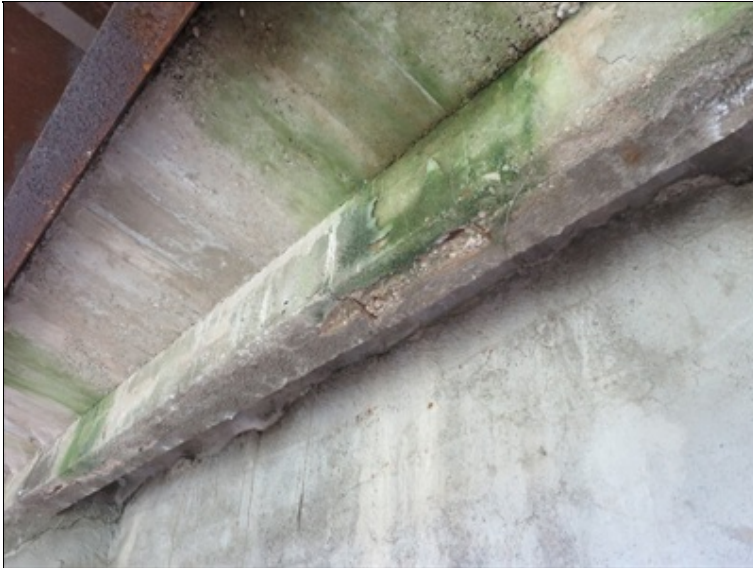
DTTO - separace krycí vrstvy nad korodující výztuží, lokální hloubková degradace betonu
