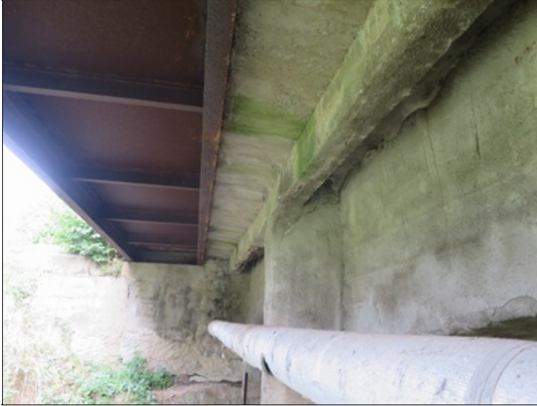
stopy po průsacích na spodním líci pravé římsy
