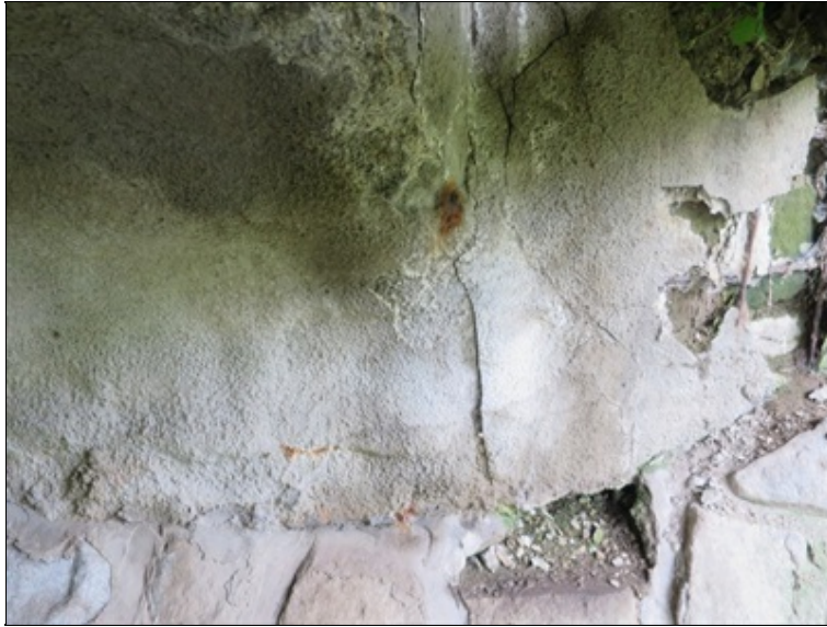
stopy po průsacích a trhliny v torkretu na líci O3
