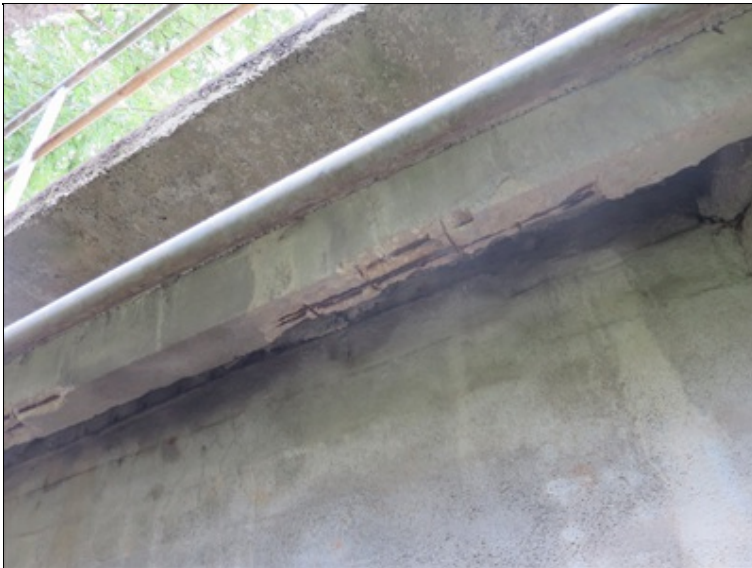
koroze výztuže, degradace betonu a separace krycí vrstvy na spodním líci levé římsy
