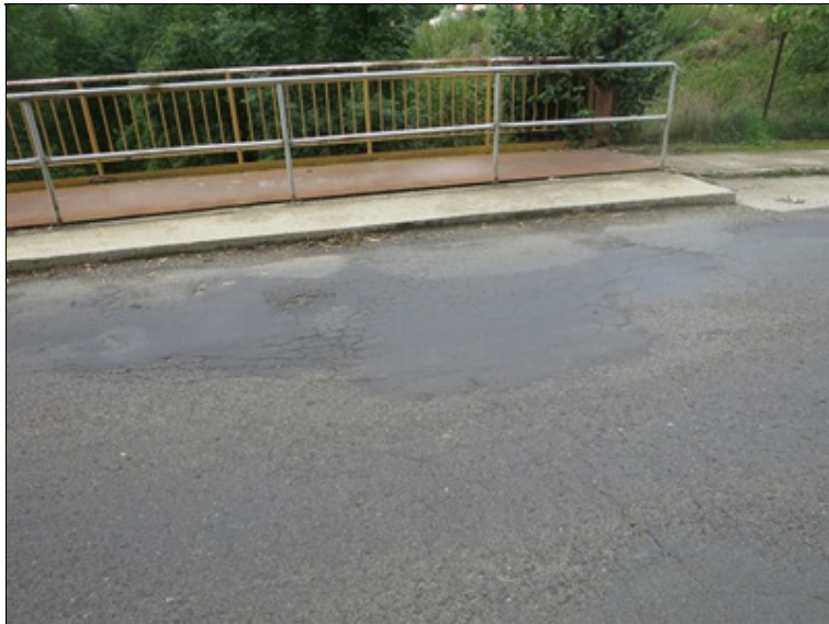
deformace krytu vozovky
