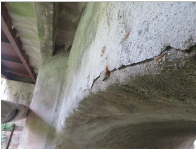
trhlina v torcretu v pravé hraně klenbového pasu ve 2. poli
