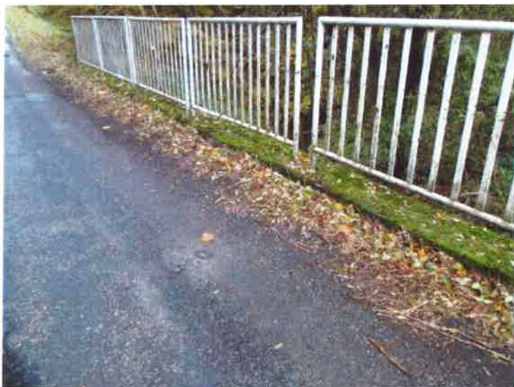
P strana mostu, nánosy a vegetace na krajnici. Mech na římse.
