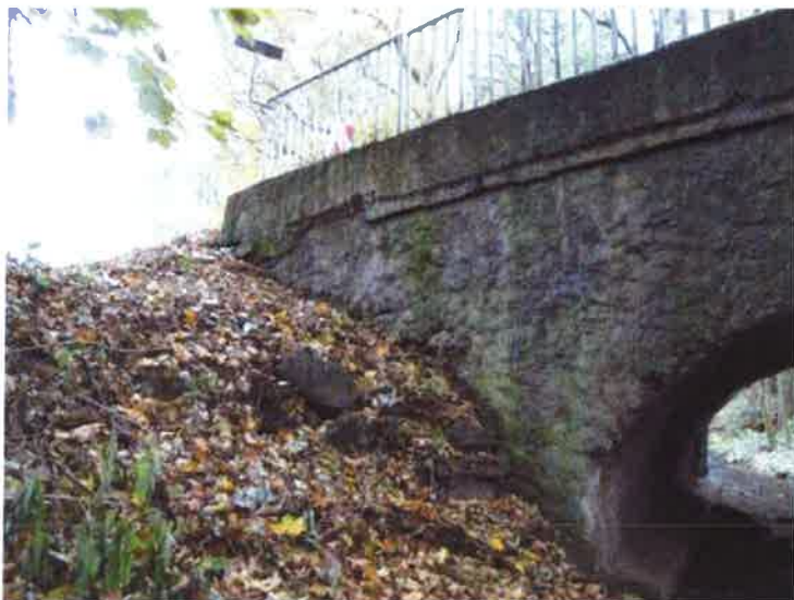
L křídlo OP2. Lokálně biologické napadení.
