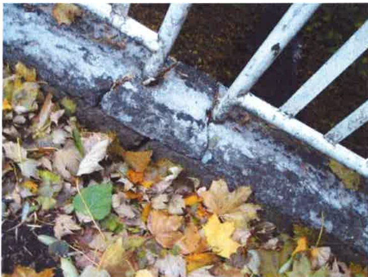
Trhliny v římse.
