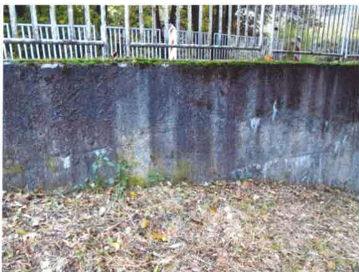
P křídlo OP1. Trhliny s výluhy.
