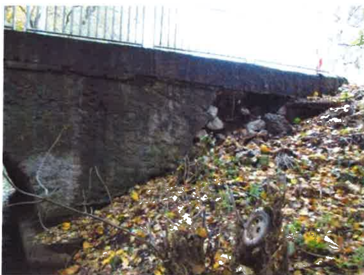
L křídlo OP1. Lokálně biologické napadení, částečně spadlé křídlo.
