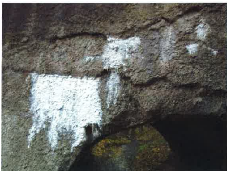
P čelní zídka. Trhliny s výluhy.
