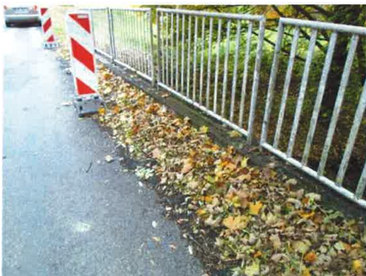
L strana mostu. Nánosy a vegetace na krajnici. Dopravní opatření.
