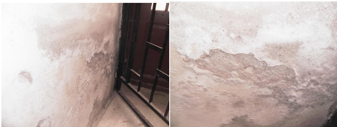
Pohled na zavlhčení zdi v interiéru 1NP druhé přístavby
