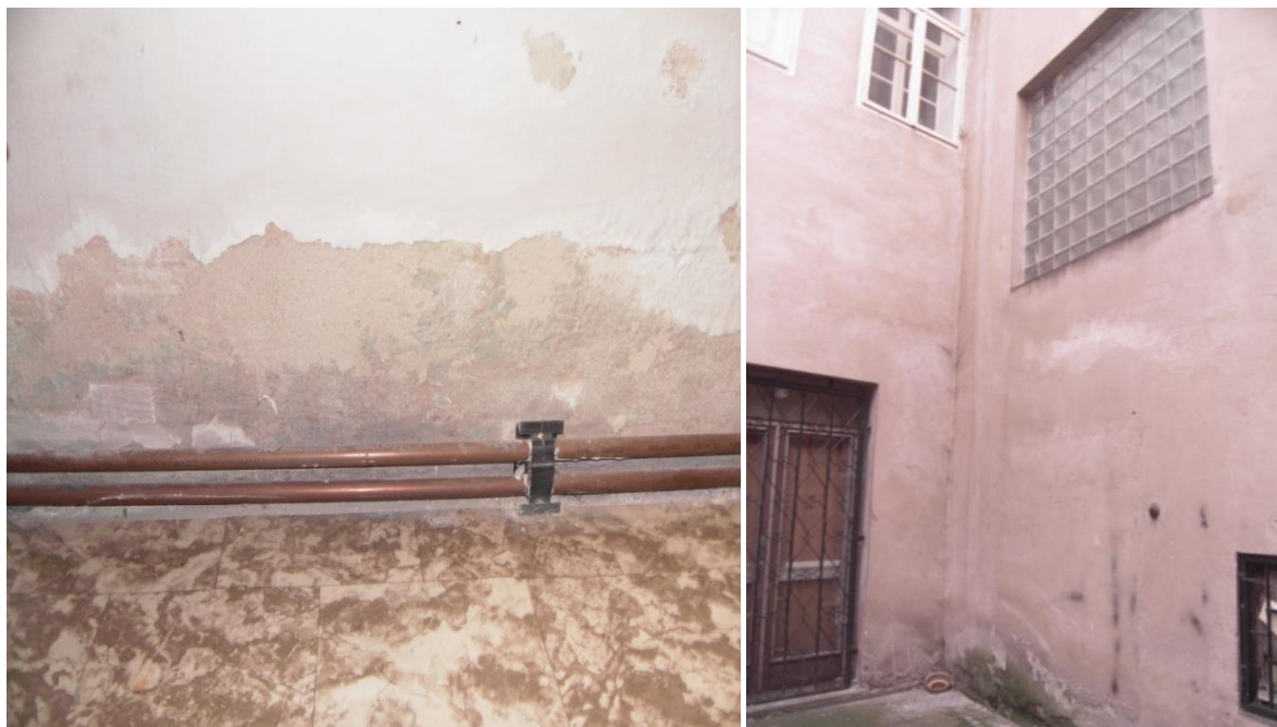
Pohled na obvodové zdivo druhé přístavby v interiéru v INP Pohled na vlhké vnější zdivo vnitřního dvorku
