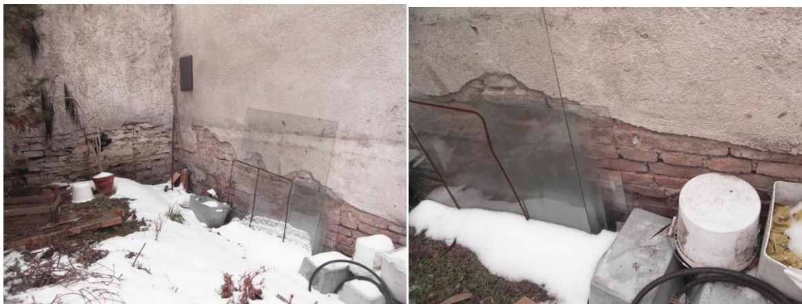
Pohled na vnější opadané, vlhké zdivo západní obvodové zdi druhé přístavby
