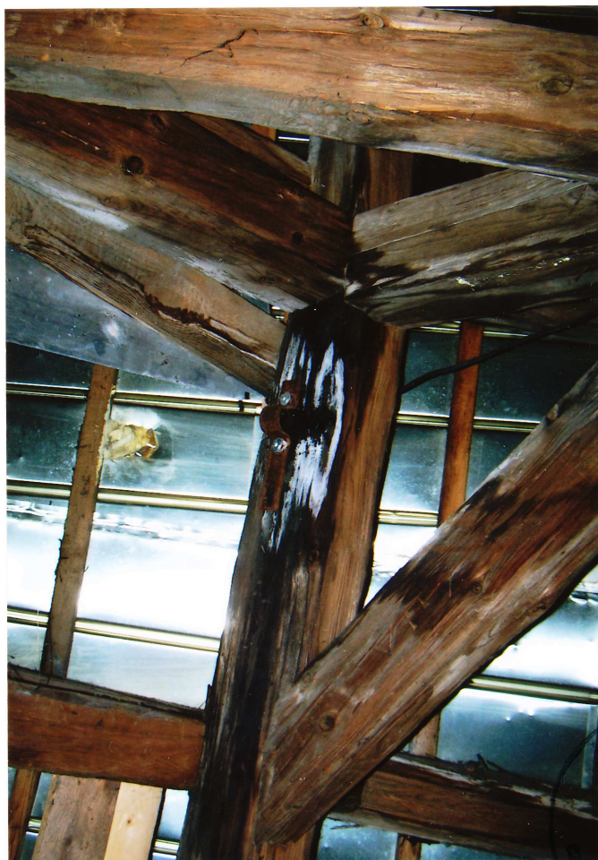
foto č. 3-poškození částí trámů Dřevomorkou domácí
