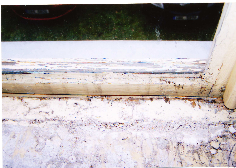
foto č. 12 – popraskaný spodní, vodorovný profil vnějšího okna ve 2.NP
