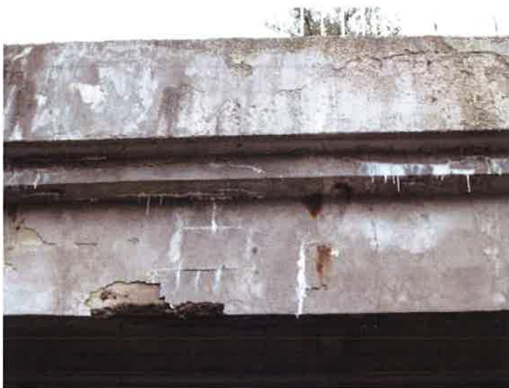
L bok NK - trhliny, výluhy, odpadlé krytí + koroze výztuže na spodním líci trámu.
