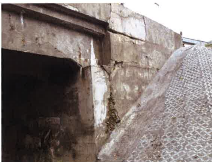
OP1 L - degradace betonu ve spáře, odpadá omítka, trhliny, graffiti. NK - trhliny s výluhy.
