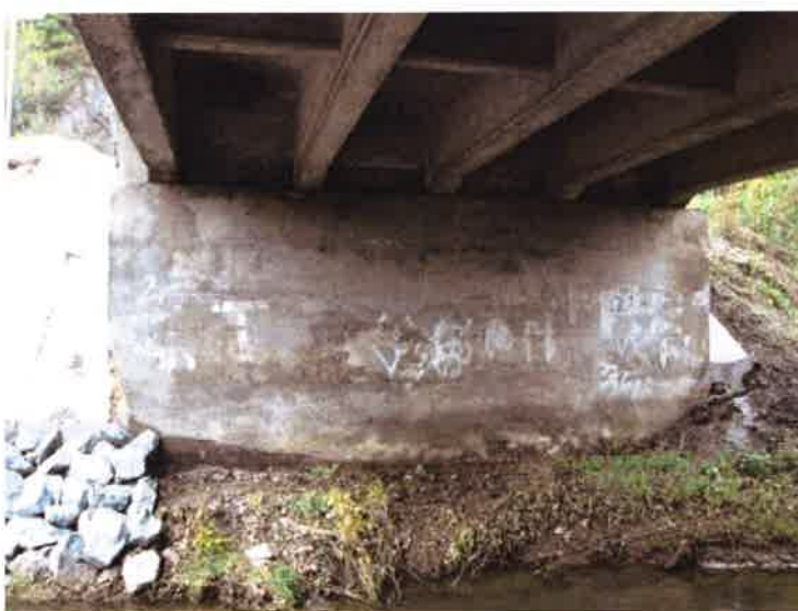
OP2 - trhliny s výluhy, graffiti.
