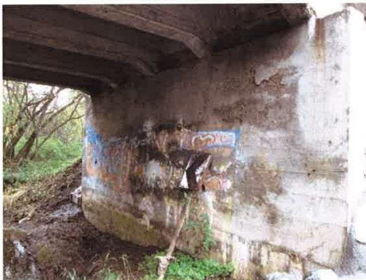
OP1 průsaky, výluhy, graffiti.
