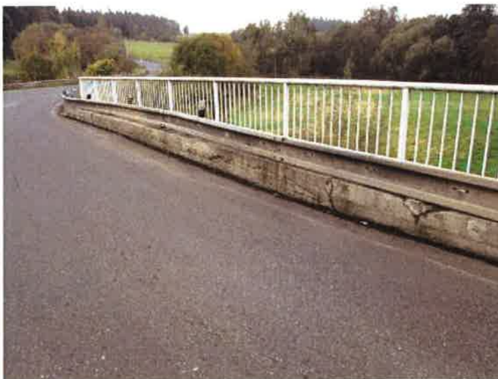
L strana mostu. Trhliny v římsě a degradace betonu. Deformace svodnice.
