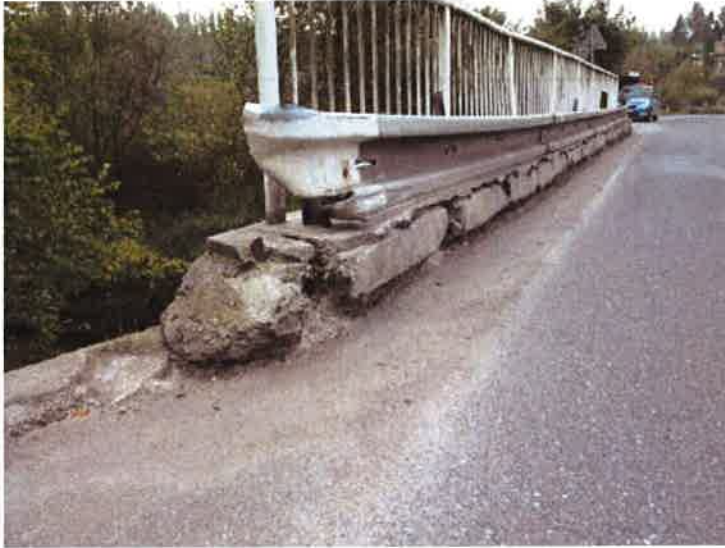
Degradace až rozpad konce P římsy, deformace konce svodidla.
