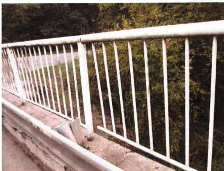
P zábradlí - uvolněné madlo, koroze.
