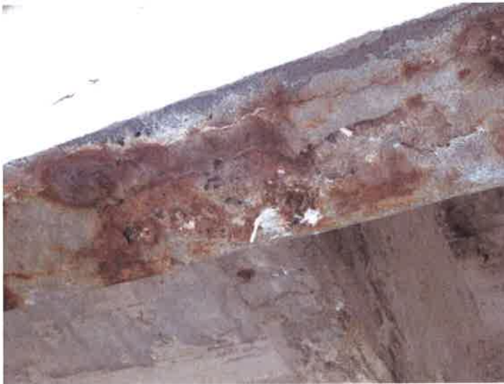
L trám NK - trhliny, výluhy.
