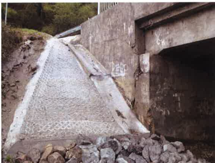
OP2 L - trhliny, degradace betonu.
