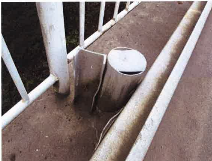
Deformace sloupku svodidla.
