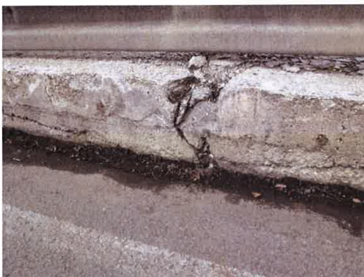
L římsa - degradace prac. spáry.
