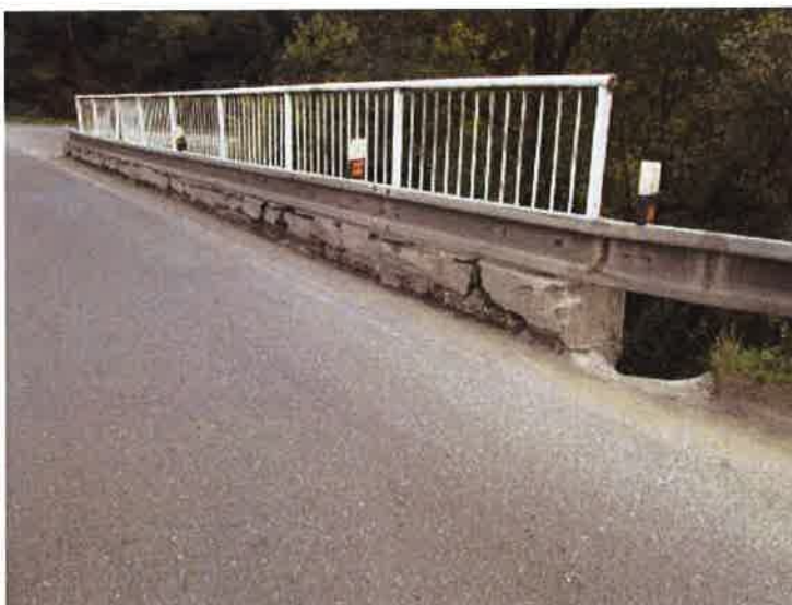
P strana mostu. Degradace betonu římsy.
