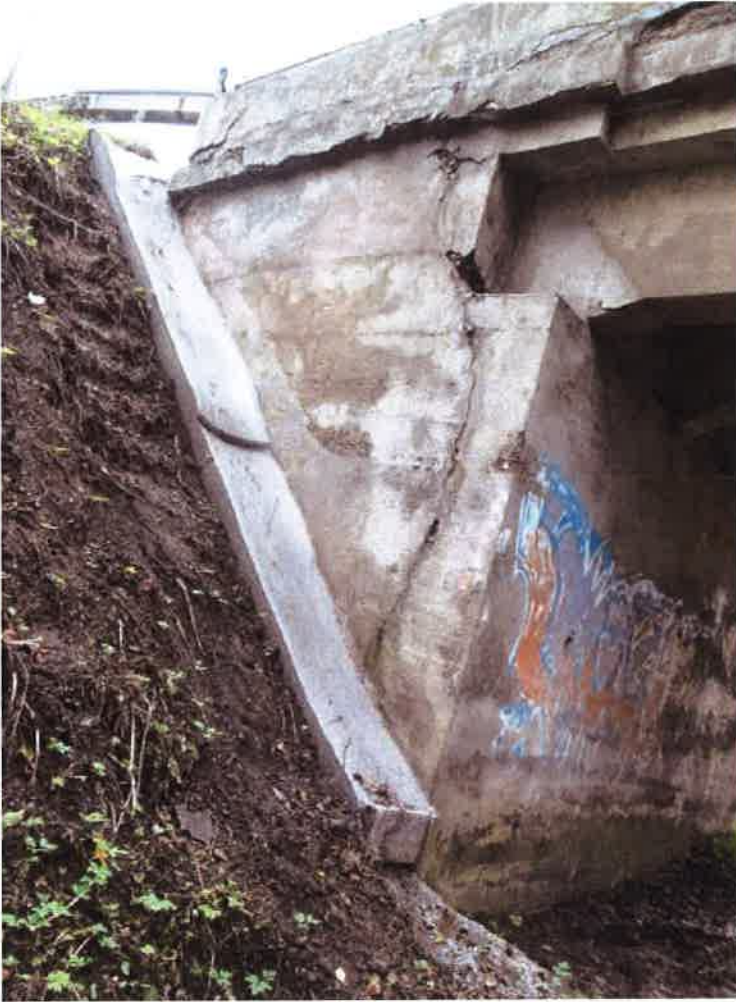
OP1 L - trhlna na boku, degradace betonu.
