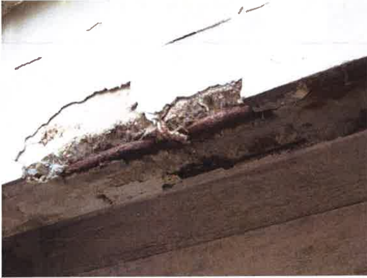
L trám NK - odpadlé krytí + koroze výztuže.
