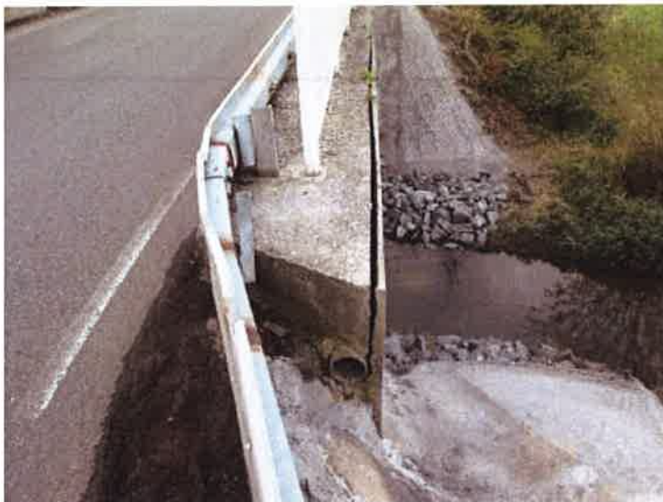
L římsa na OP2 - separovaná omítka. Degradace horního povrchu římsy. Koroze svodnice a ŠR, deformace deformačního hrnce zábradlí.
