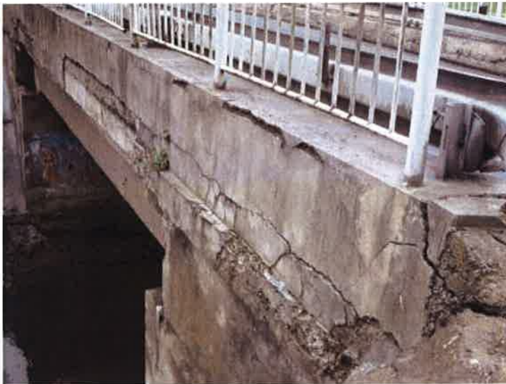
OP2 P - trhliny, výluhy, degradace betonu, odpadá omítka.
