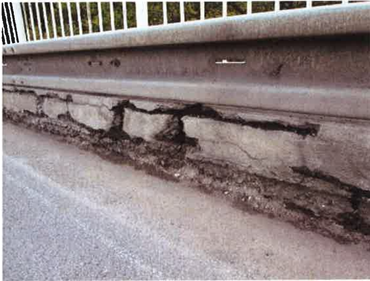
P římsa - degradace u vozovky, trhliny.
