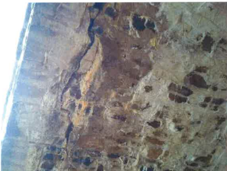
Trhlina v NK
