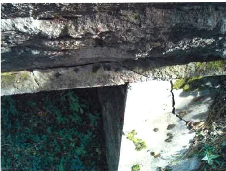
Trhlina na rozhraní pískovcového zdiva NK a opěře
