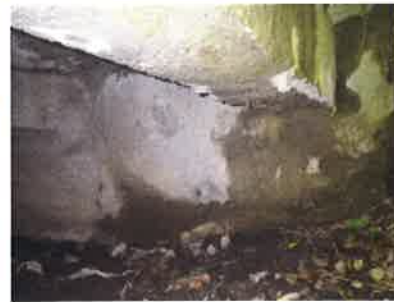
Podhled trámového nosníku, viditelné průsaky
