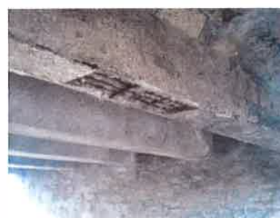
Odpad krycí vrstvy a koroze odhalené výztuže na podhledu NK
