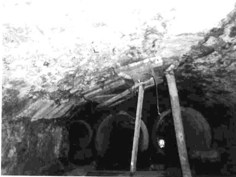
Provizorní zajištění spodního líce klenby na levé straně. Pod chodníkem navazují bet.trouby rozšíření konstrukce, vlevo je zaústění uliční vpusti. V korytě leží kameny z klenby.
