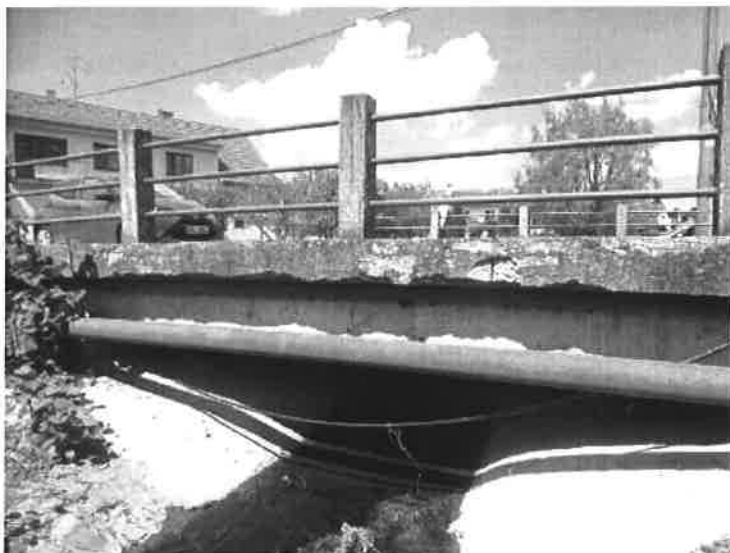
Pohled na levý bok mostu. Pod ocelovou chráničkou je volně vyvěšený kabel.
