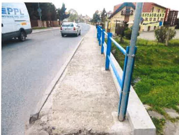
Povrchová degradace chodníku na pravé straně.
