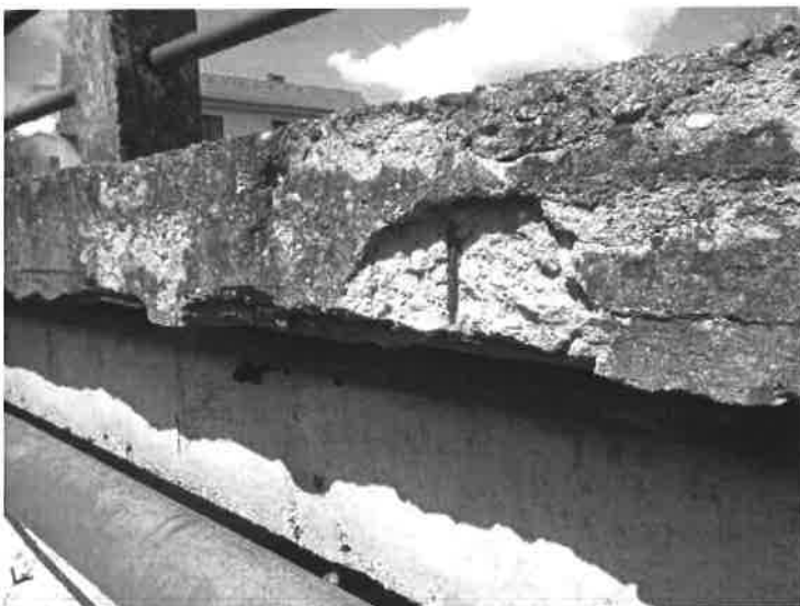
Rozpad boku železobetonové římsy.
