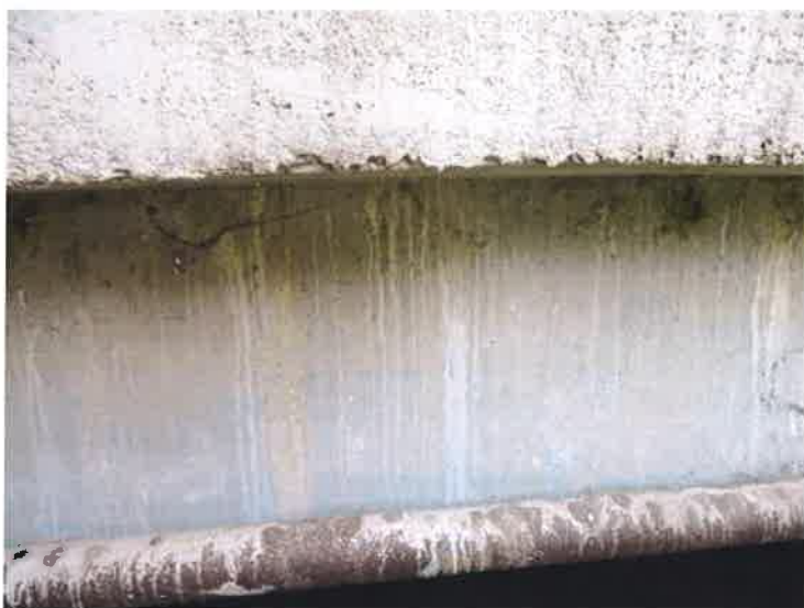
Stopy po průsacích pod římsou.
