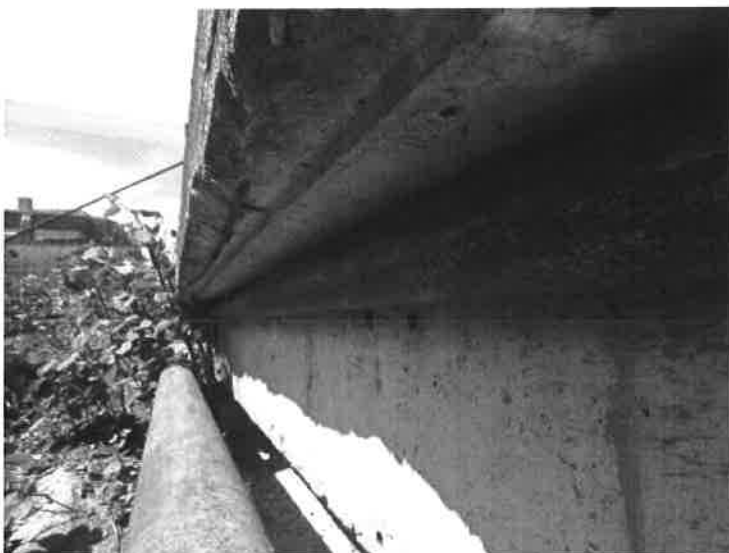
Povrchová koroze ocelových chrániček.
