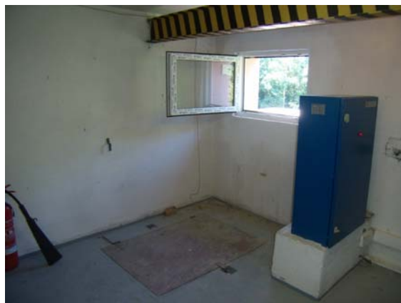
montážní nosník, poklop a větrání ve strojovně
