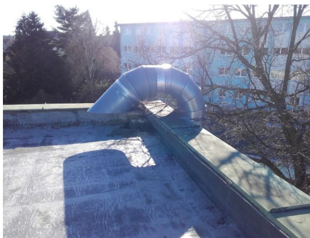
Vyústka VZT na střechu
