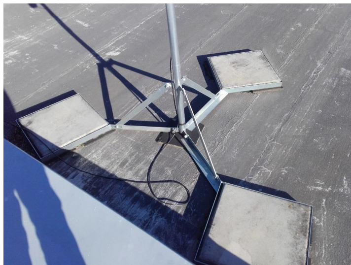
Anténa položená na střeše
