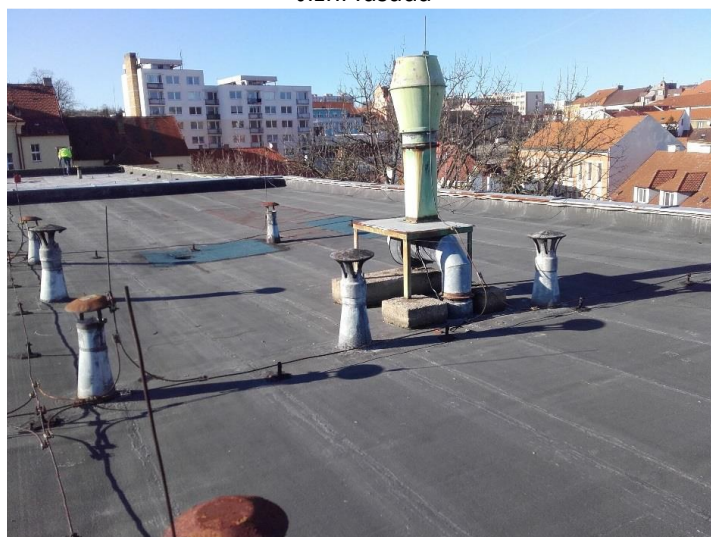
VZT ventilátor na střeše
