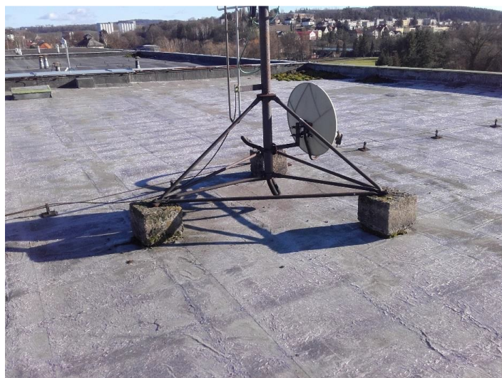
Anténa položená na střeše
