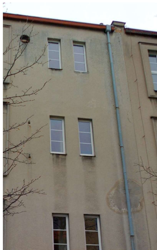
obr.5 znečištění a poškození vlivem zatékání
