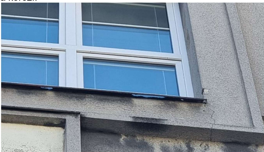
obr.8 koroze parapetů (severní fasáda)
