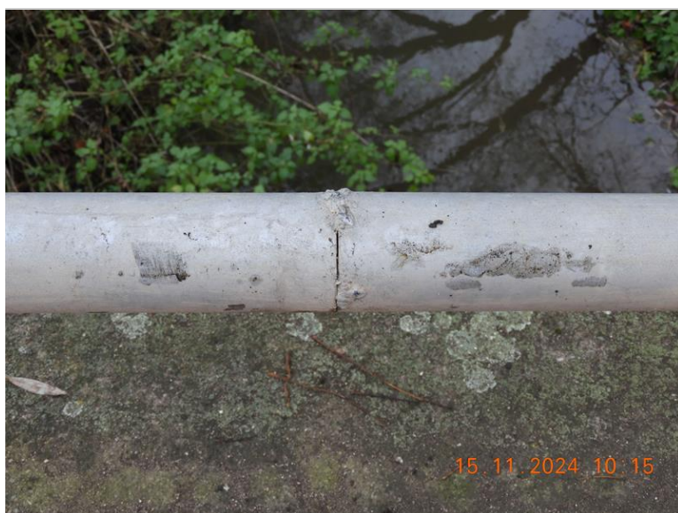
035_Levé zábradlí detail - nevyhovující svarový spoj.jpg
