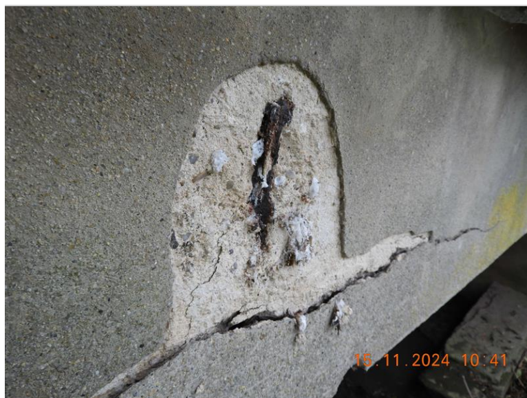
009_Pohled na levou stranu NK detail - degradace krycí vrstvy koroze výztuže vodorovná trhlina.jpg
