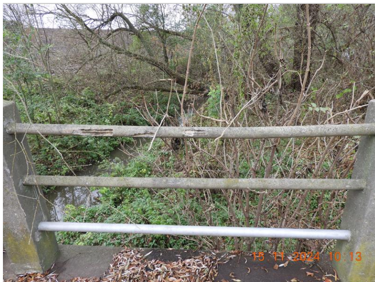
034_Levé zábradlí detail - deformace a degradace madla.jpg
