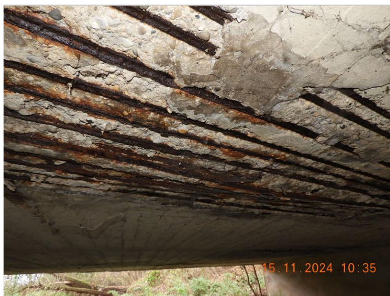
014_Podhled NK vpravo detail - degradace krycí vrstvy silná koroze výztuže.jpg
