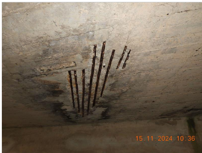
015_Podhled NK u OP2 střed detail - degradace krycí vrstvy silná koroze výztuže.jpg
