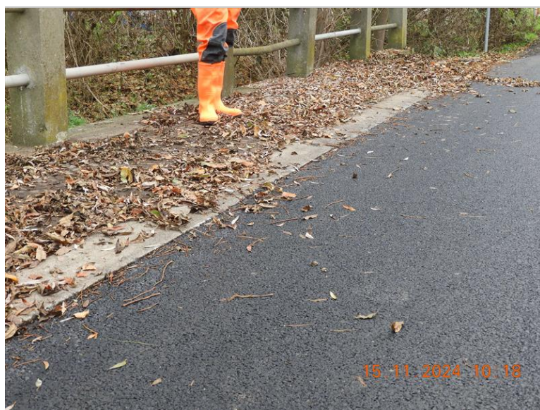
026_Chodníkové římsy typický stav po opravě - nevyhovující výška obrubníku.jpg
