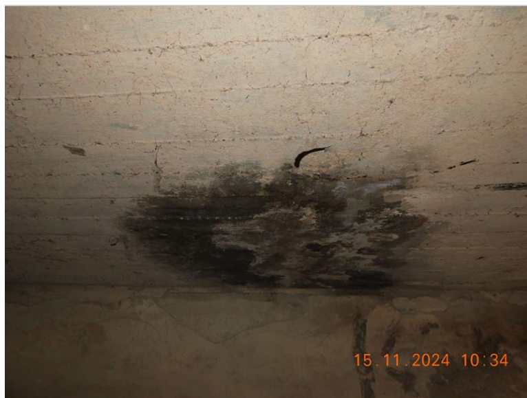
012_Podhled NK u OP1 vlevo detail - aktivní stopy po zatékání .jpg
