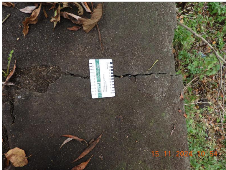
030_Levá římša u OP2 typický stav nad opěrami - příčná trhlina.jpg
