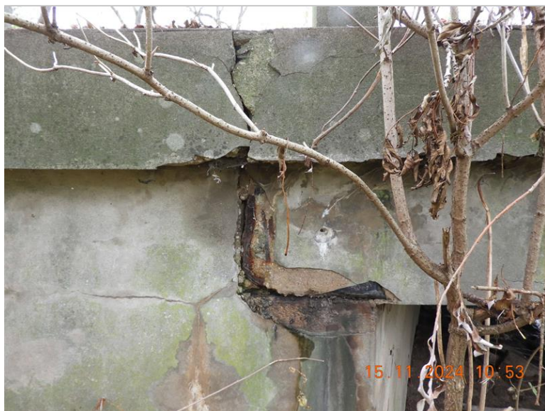
018_Detail uložení NK na opěru OP2 - aktivní stopy po zatékání.jpg
