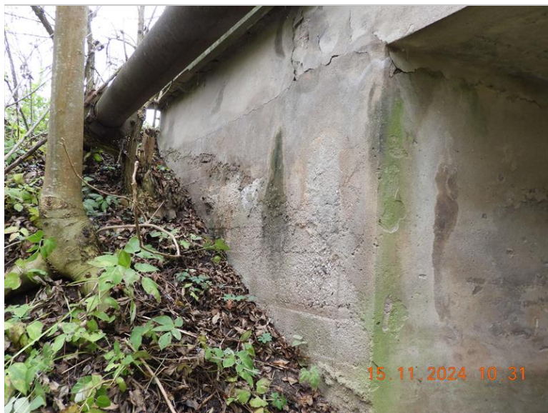
008_Pohled na pravé křídlo OP1 - trhliny v sanační omítky stopy po zatékání výluhy.jpg
