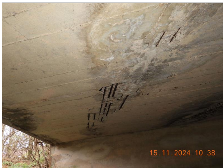
016_Podhled NK vlevo detail - degradace krycí vrstvy silná koroze výztuže stopy po zatékání.jpg
