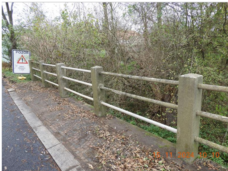
031_Typický stav zábradlí - lokální oprava výplní.jpg
