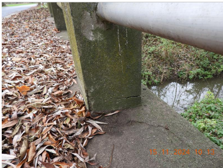
032_Levé zábradlí detail - vodorovná trhlina ve sloupku.jpg
