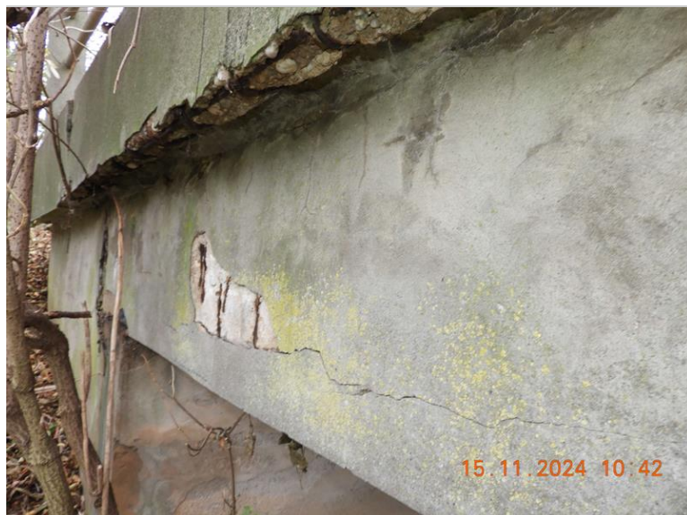
010_Pohled na levou stranu NK u OP2 detail - degradace krycí vrstvy koroze výztuže vodorovná trhlina.jpg
