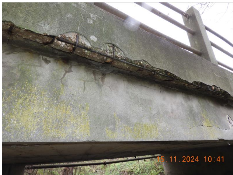
028_Levá římsa detail - porucha krycí vrstvy koroze výztuže.jpg
