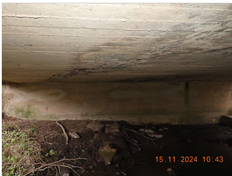
020_Pohled na opěru OP2 - stopy po zatékání.jpg
