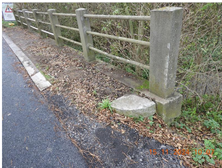
027_Typický stav římsových chodníků - postupná degradace rozvolněná dlažba.jpg
