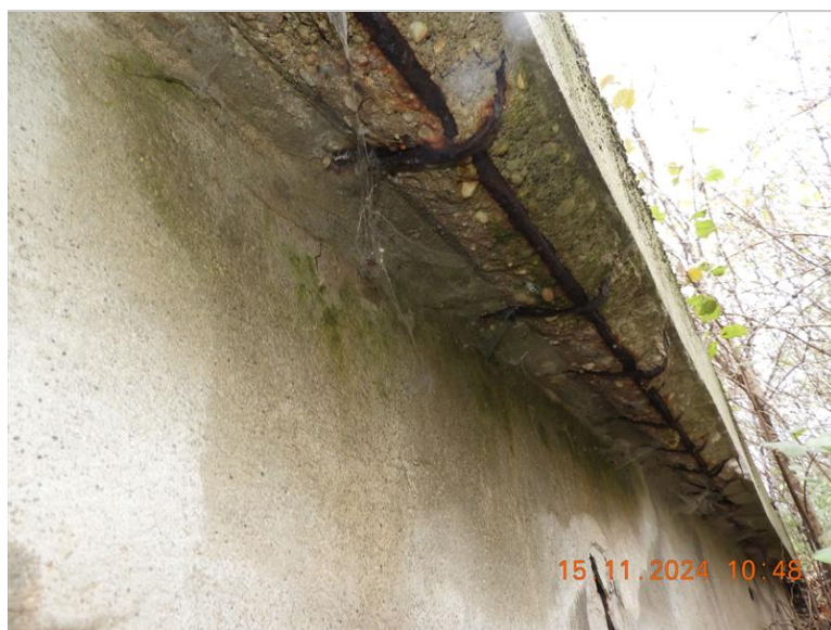
029_Pravá římsa detail - porucha krycí vrstvy koroze výztuže zatékání.jpg
