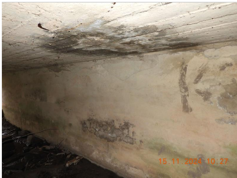
007_Opěra OP1 detail - degradace sanační omítky lokální stopy po zatékání .jpg
