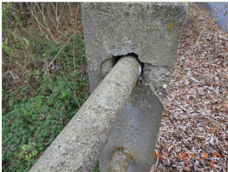
033_Levé zábradlí detail - uvolněné madlo .jpg
