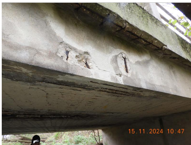
017_Pohled na pravou stranu NK detail - degradace krycí vrstvy koroze výztuže stopy po zatékání.jpg
