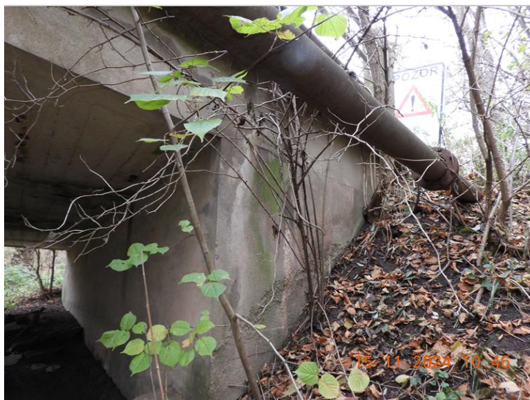
021_Pohled na pravé křídlo opěry OP2 .jpg
