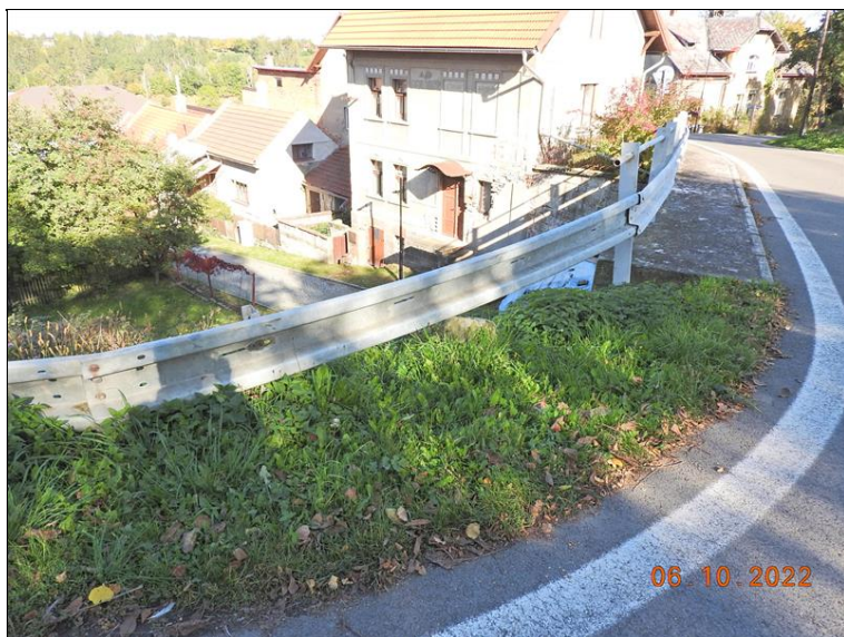
Pravé svodidlo vykloněné.
