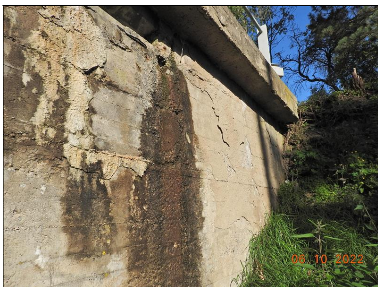
Levé křídlo OP1, intenzivní zatékání.
