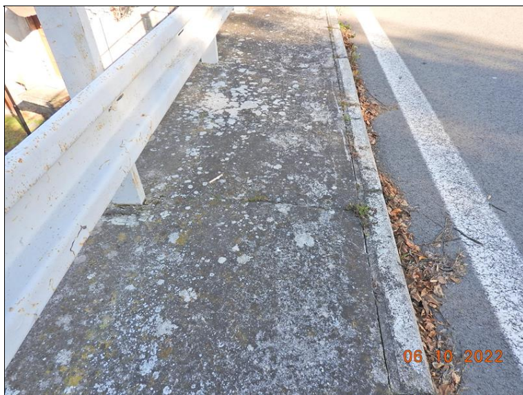
Pravý chodník - trhlina střed.
