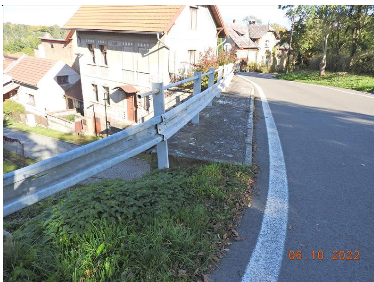
Pravé svodidlo vykloněné.
