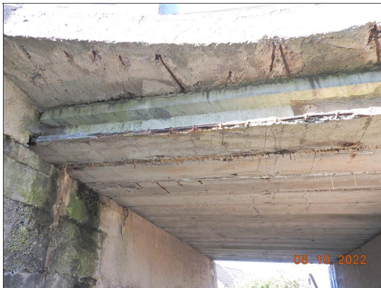
Nosná konstrukce - levý bok. Výztuž v hraně L nosníku obnažena v téměř celé délce.
