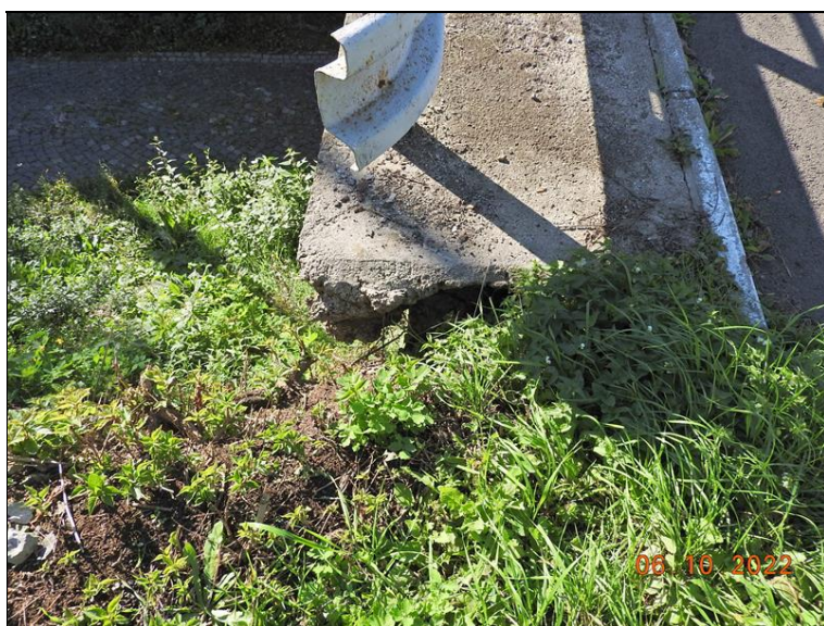
Levý chodník - eroze střed.
