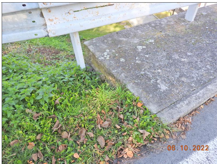
Pravý chodník eroze svahu.
