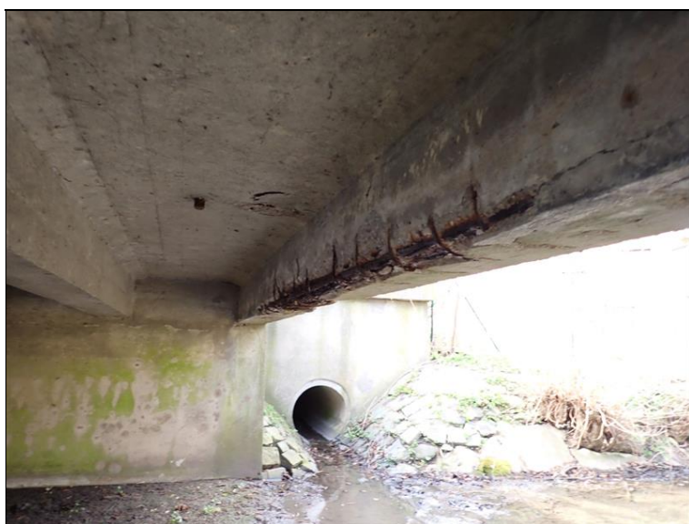
Podhled pravého krajního nosníku - zcela odpadá krycí vrstva, silně korodující výztuž (některé pruty zcela bez spolupůsobení s betonem).
