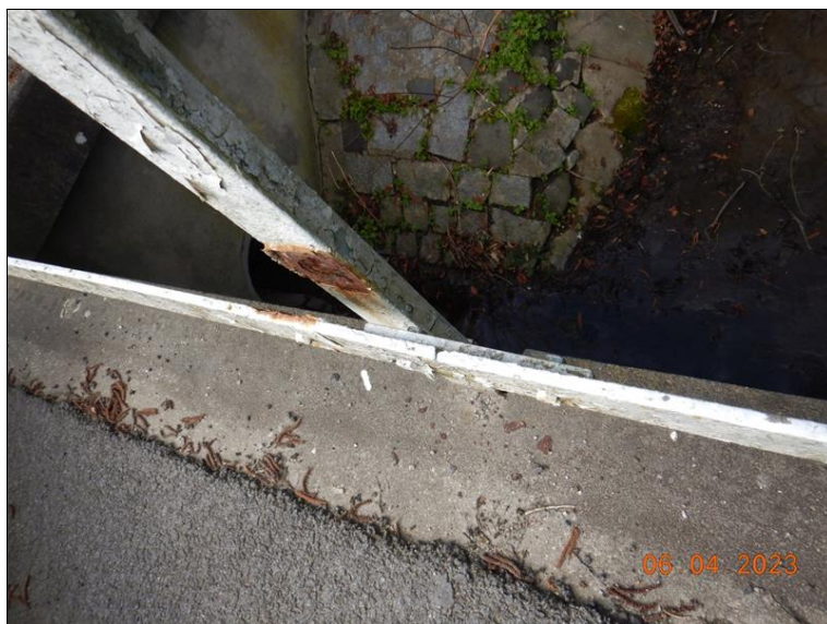
Detaily poruchy zábradlí - vodorovný kovový prvek oddělený od sloupku. 2/2
