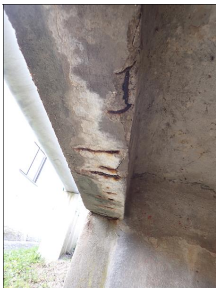
Podhled levého krajního nosníku - zatékání, odhalená korodující výztuž.
