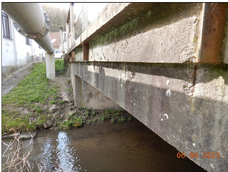
Pohled na konstrukci zleva pod římsou - povrchová degradace betonu římsy.
