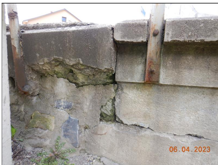
Detail odpadlé části římsy na levém křídle na O2.
