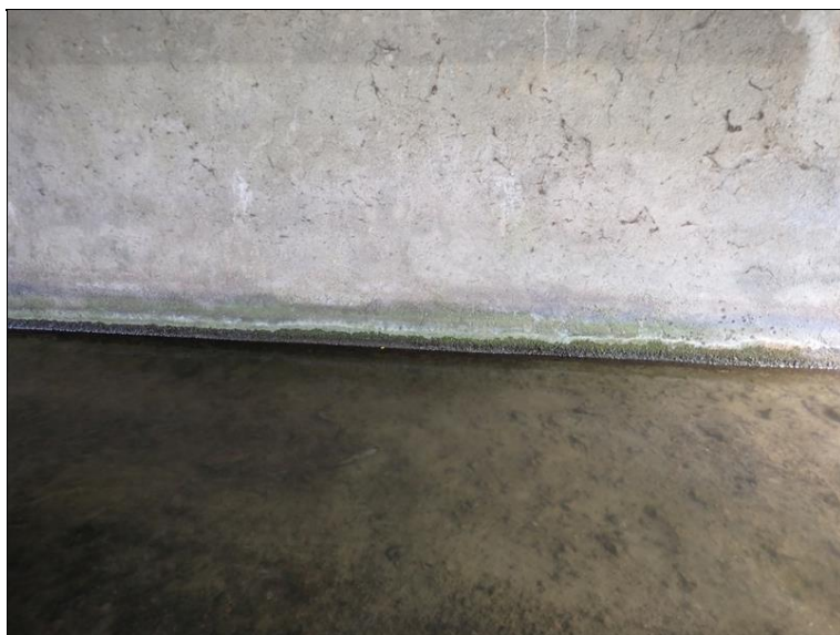
Pohled na opěru v úrovni hladiny - růst mechtů na opěrách.
