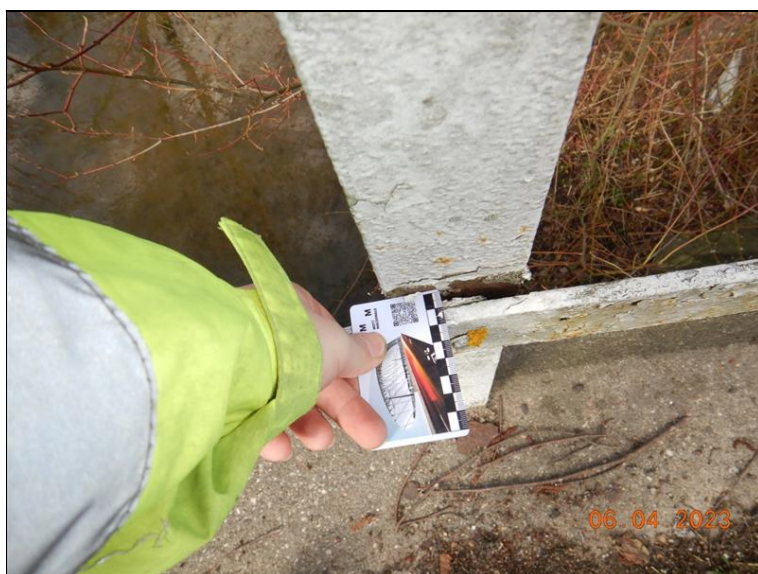
Detaily poruchy zábradlí - vodorovný kovový prvek oddělený od sloupku. 1/2
