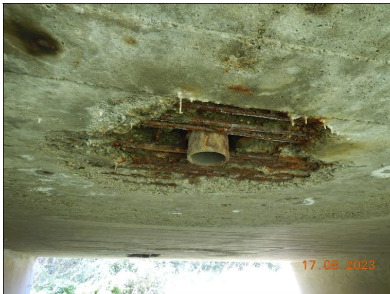
033_Podhled nosné konstrukce vpravo. Degradace betonu a koroze výztuže na ploše cca 1 m2. Zatékání odvodnění a tvorba krápníků..jpg
