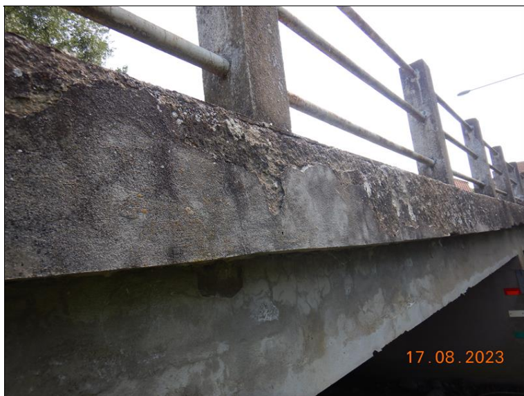
019_Levá římsa 2. pole. Degradace betonu a bionapadení..jpg
