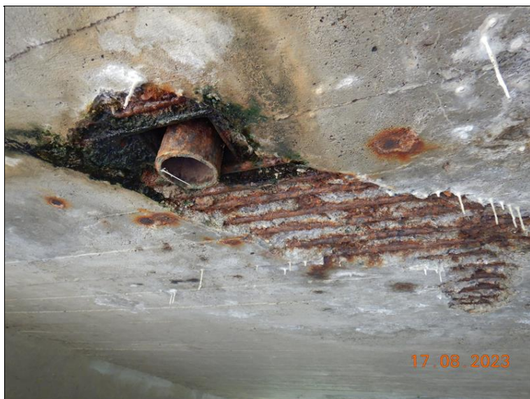
024_Podhled nosné konstrukce vlevo 2. pole. Degradace betonu a koroze výztuže na ploše cca 1.5 m2. Zatékání odvodněním a tvorba krápníků..jpg
