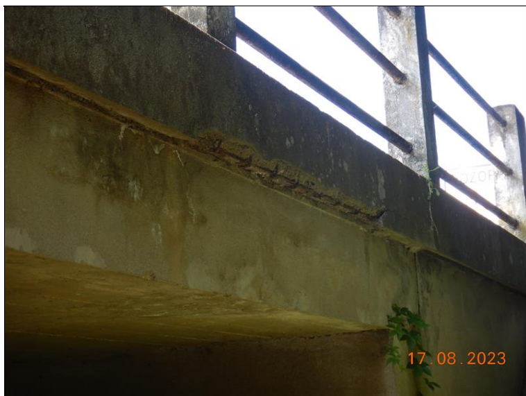
028_Pravá římsa u OP3. Degradace betonu a koroze výztuže..jpg
