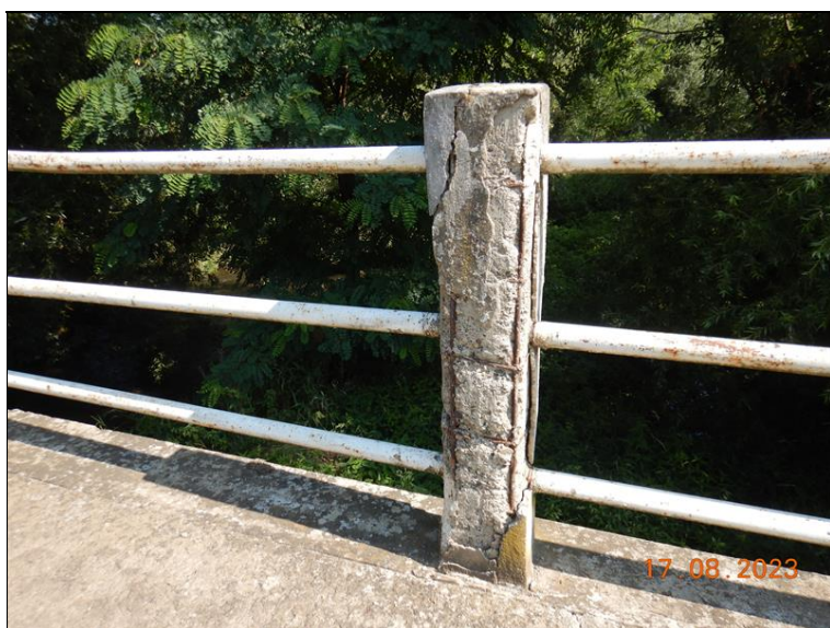
017_Pravé zábradlí 2. až 7. sloupek. Degradace betonu a koroze výztuže..jpg
