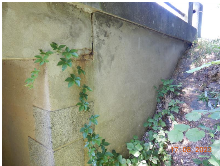
027_Pravé křídlo OP3. Zatékání spárou..jpg
