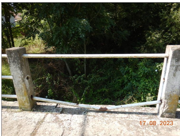
014_Levé zábradlí 2. segment. Chybějící vodorovná výplň..jpg
