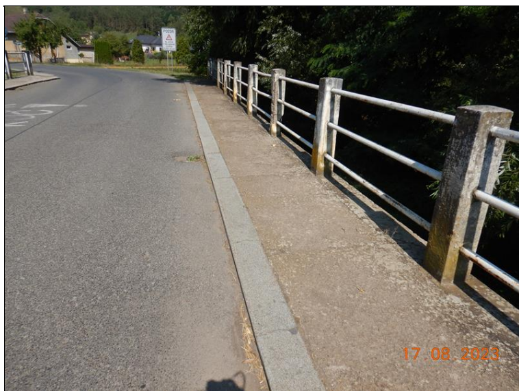
016_Pravý chodník Celoplošná degradace chodníku..jpg
