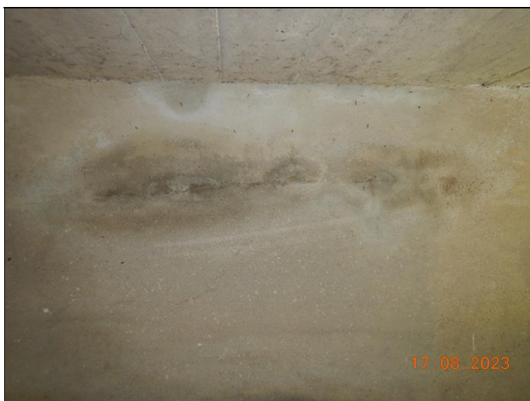
026_OP3 vpravo. Vodorovná trhlina. .jpg
