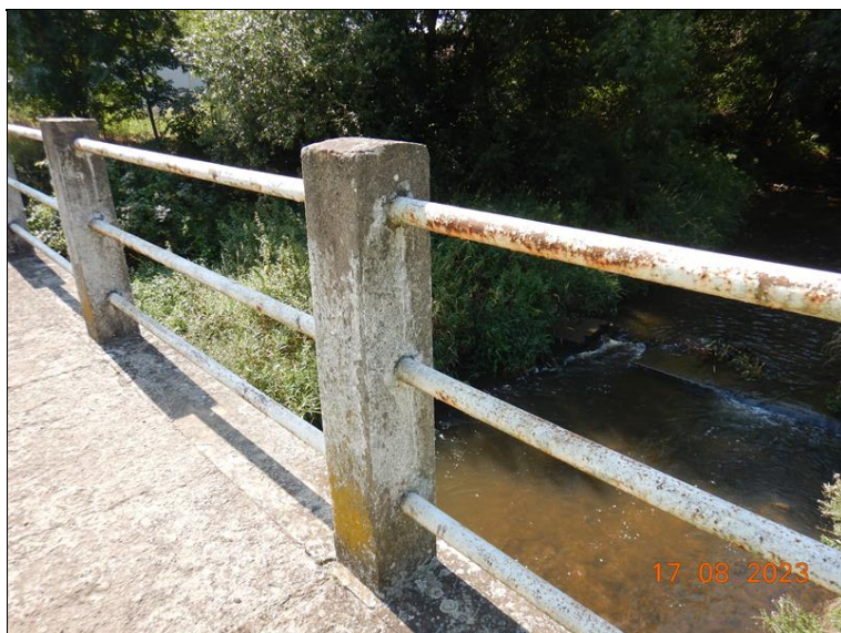
013_Zábradlí vlevo. Degradace betonu sloupků. Koroze a degradace nátěru vodorovné výplně..jpg
