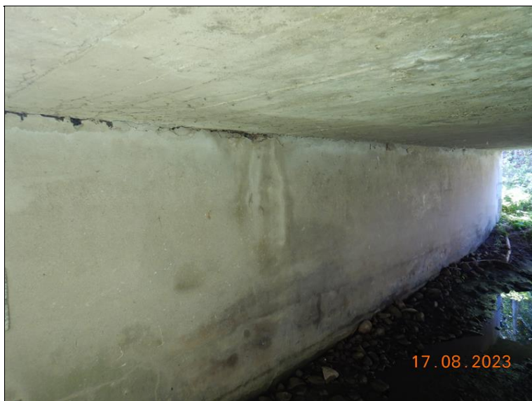
004_OP1. Zatékání úložnou spárou..jpg
