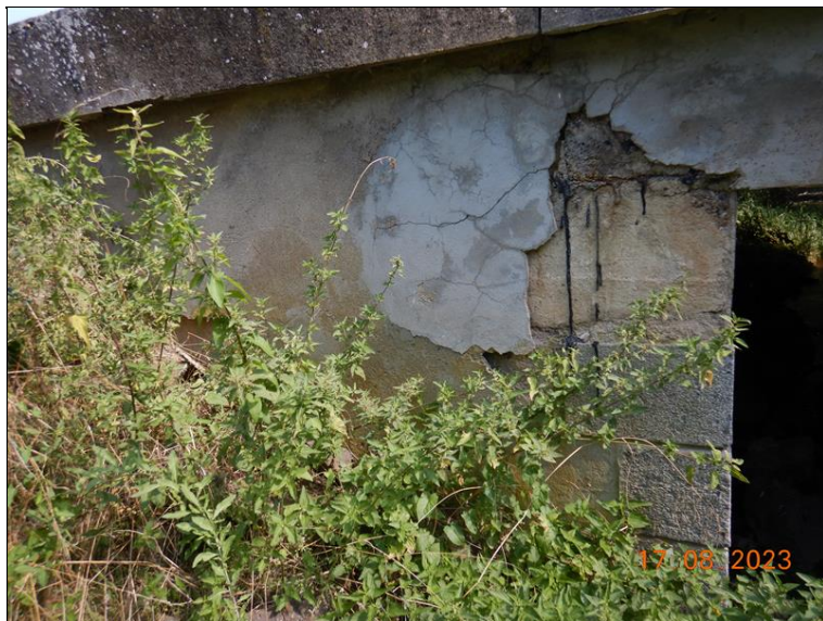
018_Levé křídlo OP3. Separace a rozpad omítky na ploše cca 2 m2..jpg
