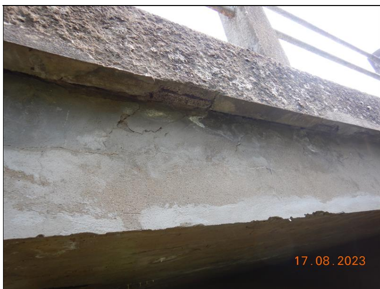
020_Levý bok NK 2. pole. Trhliny s výluhy v omítce . Stopy po zatékání..jpg
