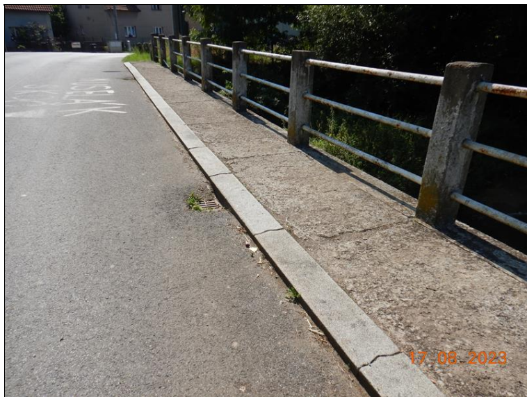
009_Krajnice vlevo. Přebalení vozovky snižující účinnost odrazných obrubníků..jpg
