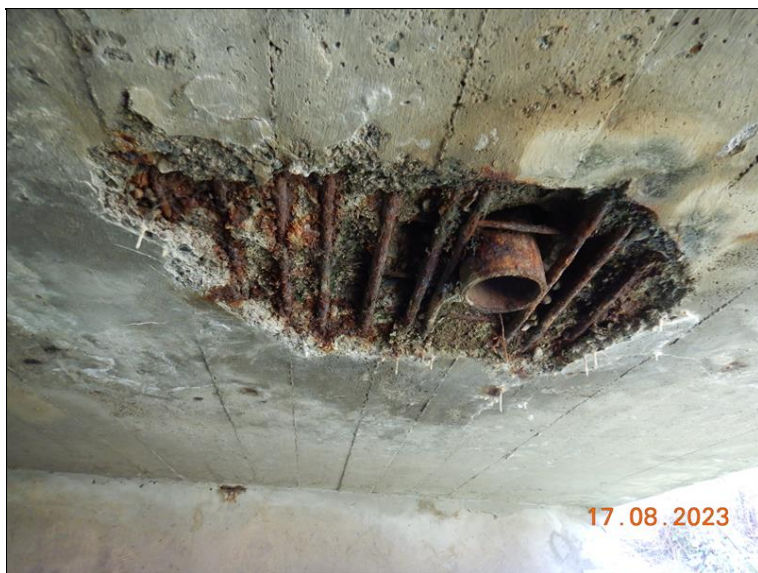
034_Podhled nosné konstrukce vlevo. Degradace betonu a koroze výztuže na ploše cca 1 m2. Zatékání odvodnění a tvorba krápníků..jpg
