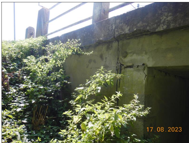
006_Pravé křídlo OP1. Degradace spáry..jpg
