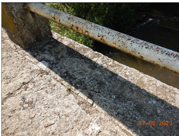
008_Levá římsa. Povrchová degradace betonu a koroze..jpg
