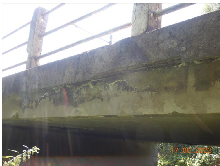
029_Pravý bok NK 1. pole. Stopy po zatékání na bok NK. Degradace betonu a koroze římsy..jpg
