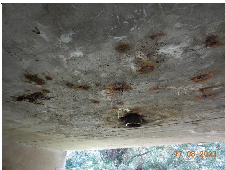
025_Podhled nosné konstrukce vpravo 2. pole. Degradace betonu a koroze výztuže. Zatékání odvodněním a tvorba krápníků..jpg
