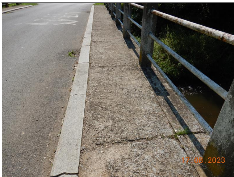
012_Levý chodník. Plošná degradace povrchu chodníku..jpg
