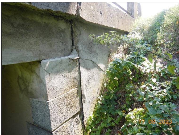
005_Levé křídlo OP1. Degradace spáry..jpg
