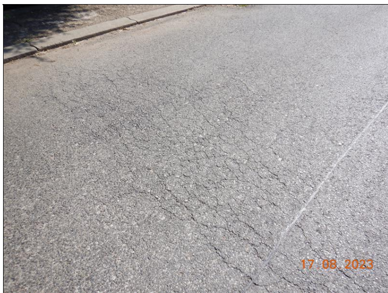
010_Vozovka detail. Příčné trhliny u OP3..jpg
