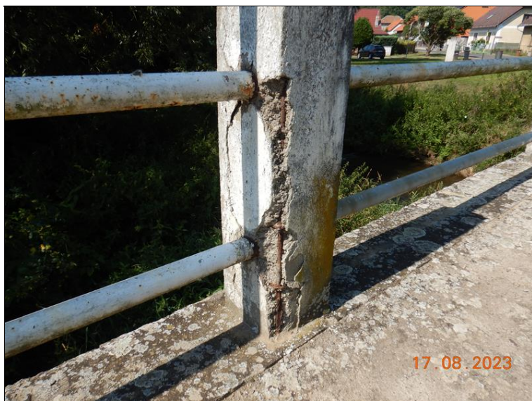
015_Levé zábradlí 2. až 4. sloupek. Degradace betonu a koroze výztuže..jpg
