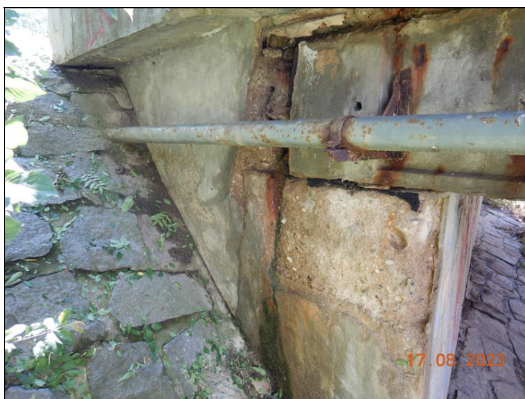
008_Pravé křídlo OP1. Rozpad betonu do hloubky 100 mm a zatékání spárou..jpg
