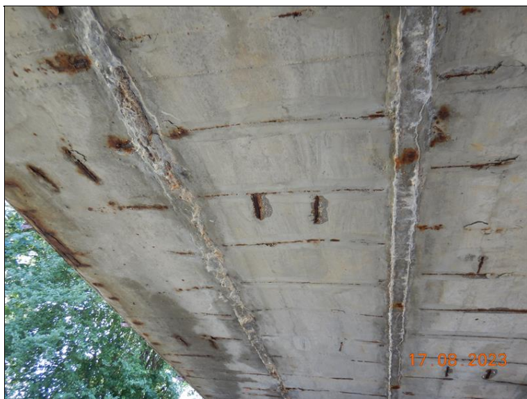
019_Podhled nosné konstrukce vpravo detail. Zatékání spárami a tvorba krápníků..jpg
