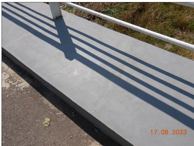
016_Levá římsa detail. Smršťovací trhliny..jpg
