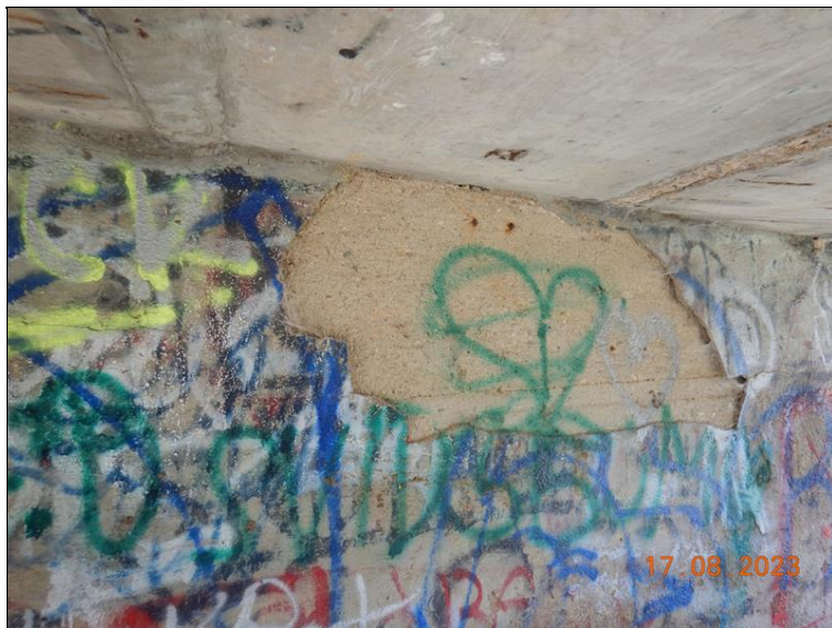
021_OP2 vpravo detail. Rozpad omítky na ploše cca 2.5 m2..jpg
