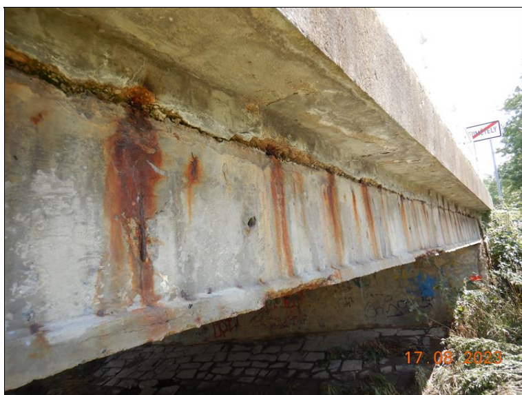
013_Levý bok NK. Nedostatečná krycí vrstva a zatékání zpod římsy..jpg
