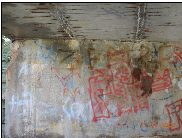
020_OP1 detail vpravo. Zatékání úložnou spárou. .jpg
