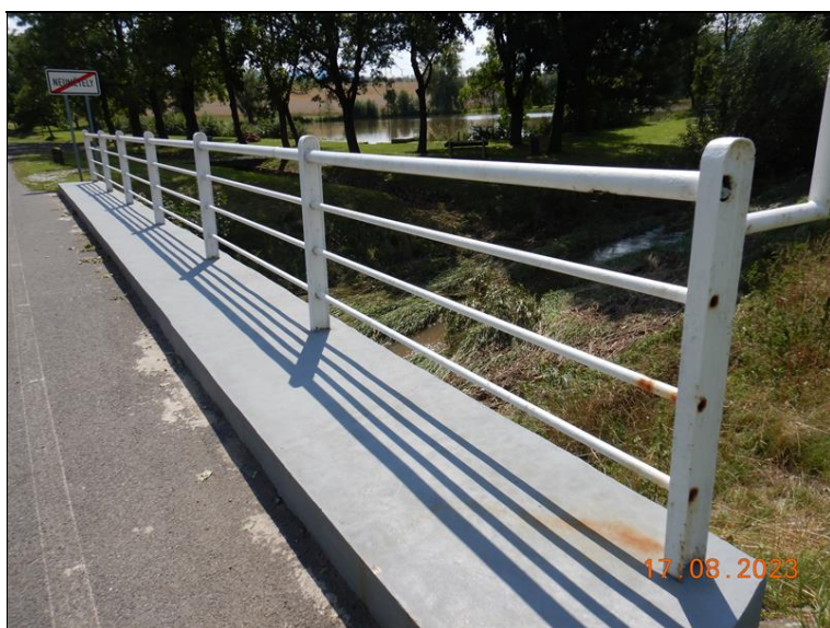
014_Levé zábradlí. Lokální koroze..jpg
