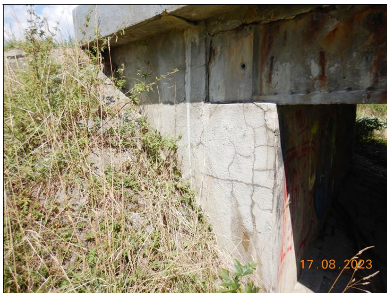
007_Levé křídlo OP2. Síť všesměrných trhlin v omítce..jpg
