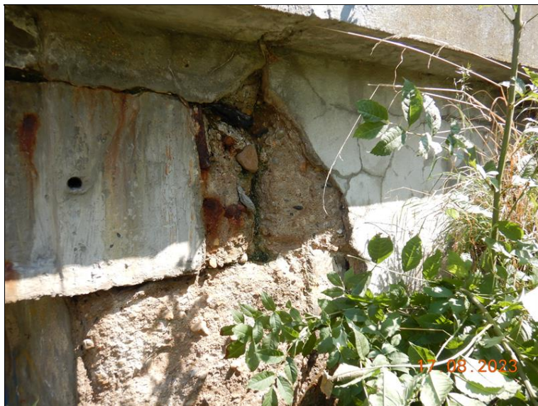
006_Levé křídlo OP1. Rozpad betonu do hloubky 100 mm a zatékání spárou..jpg
