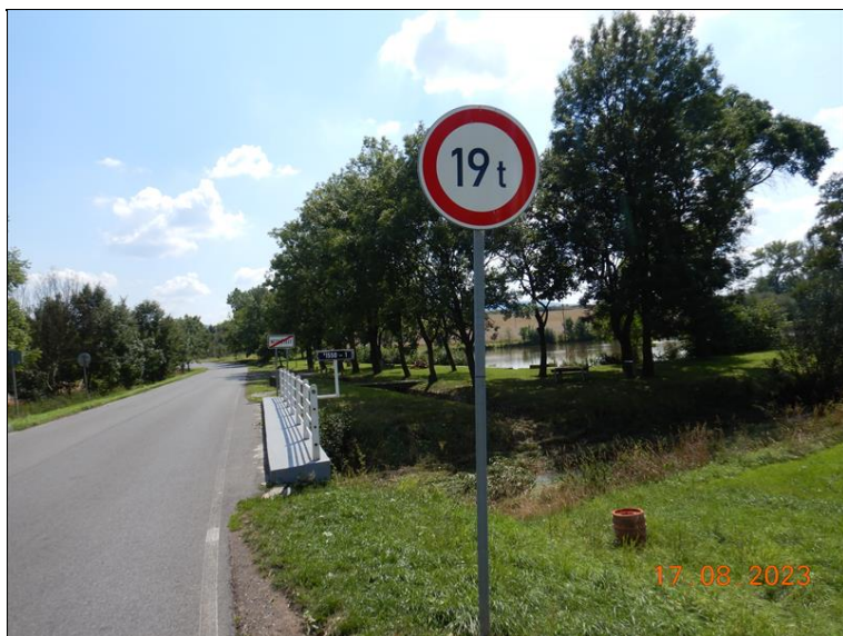
015_SDZ za mostem. Chybí dopravní značení E13 a B14..jpg
