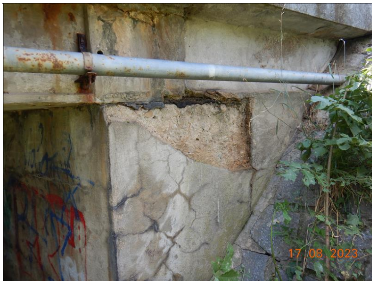
009_Pravé křídlo OP2. Rozpad omítky a zatékání spárou..jpg
