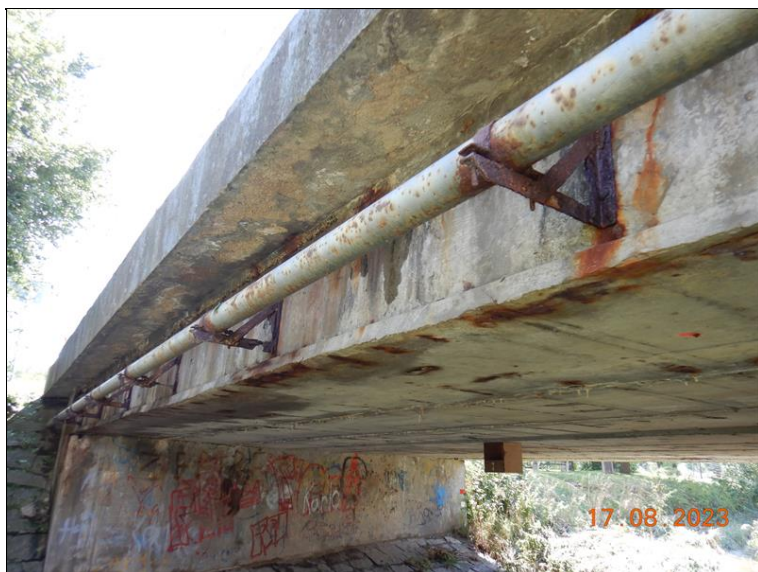
012_Pravý bok NK. Nedostatečná krycí vrstva a zatékání zpod římsy..jpg
