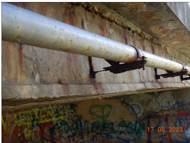
022_Cizí zařízení vpravo. Zkorodované konzoly..jpg
