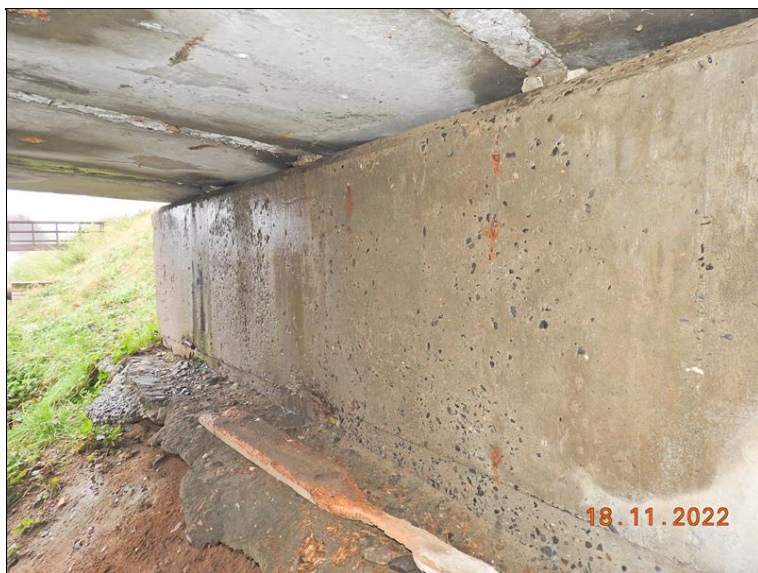
OP2 vlevo - svislá trhlina.
