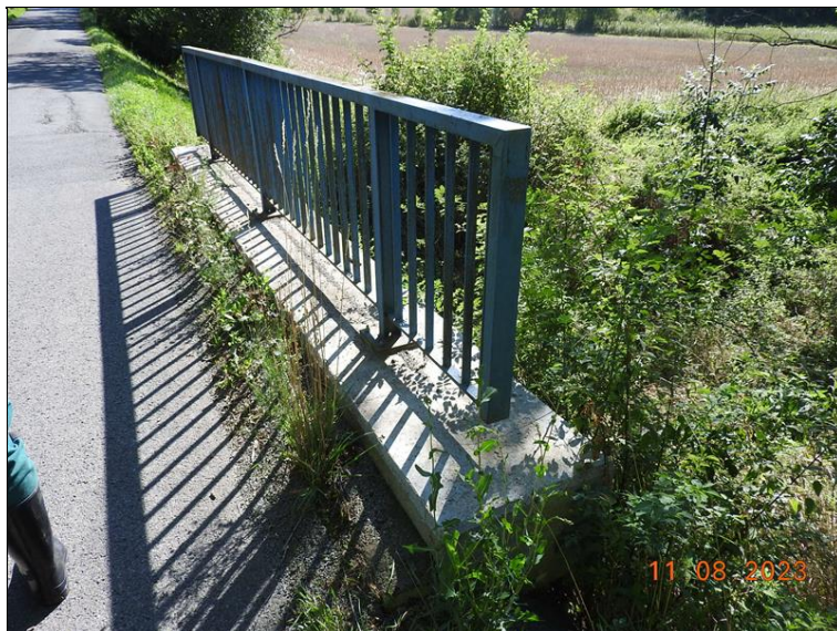
015_pravá římsa_bionapadení, povrchová degradace.JPG
