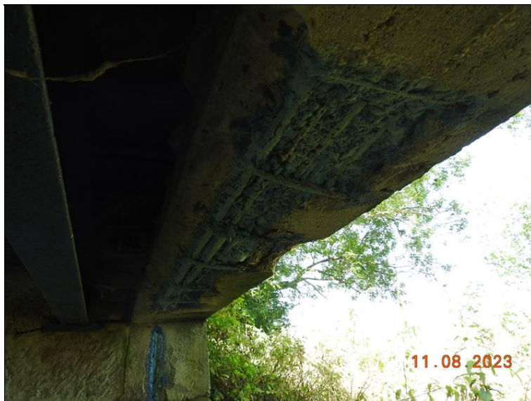
024_podhled NK vlevo_koroze, stopy po sanaci.JPG
