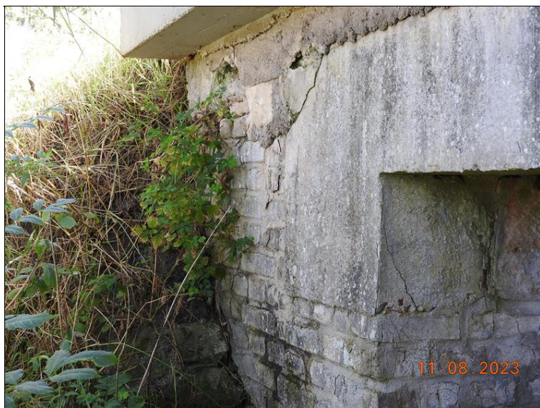
007_levé křídlo OP2_sít' trhlín.JPG
