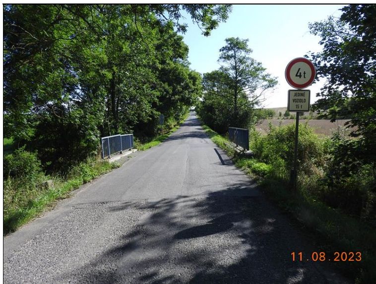
001_po směru_chybí evidenční číslo chybí SDZ B14.JPG
