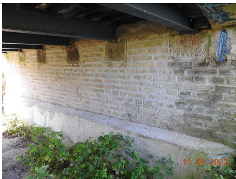
005_OP1_degradace zdiva. zatékání.JPG
