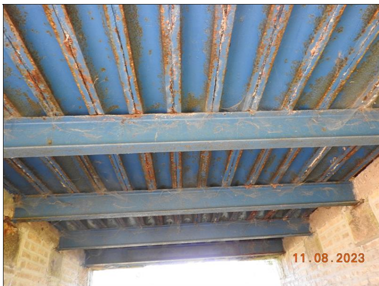
010_podhled NK_koroze, degradace nátěru.JPG
