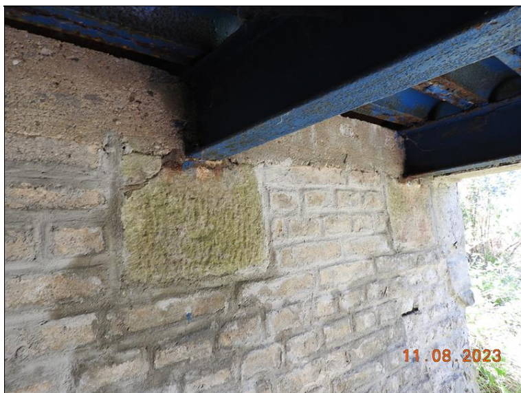
013-uložení NK na OP2_koroze.JPG
