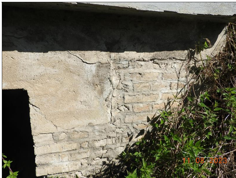
009_pravé křídlo OP2_degradace spárování, svislá trhлина.JPG
