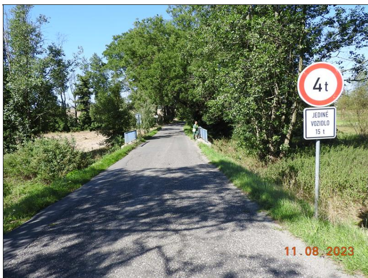
002_proti směru_chybí evidenční č. chybí SDZ B14.JPG
