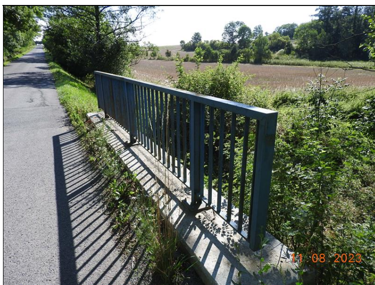
017_pravé zábradlí_koroze, nevyhovuje ČSN.JPG
