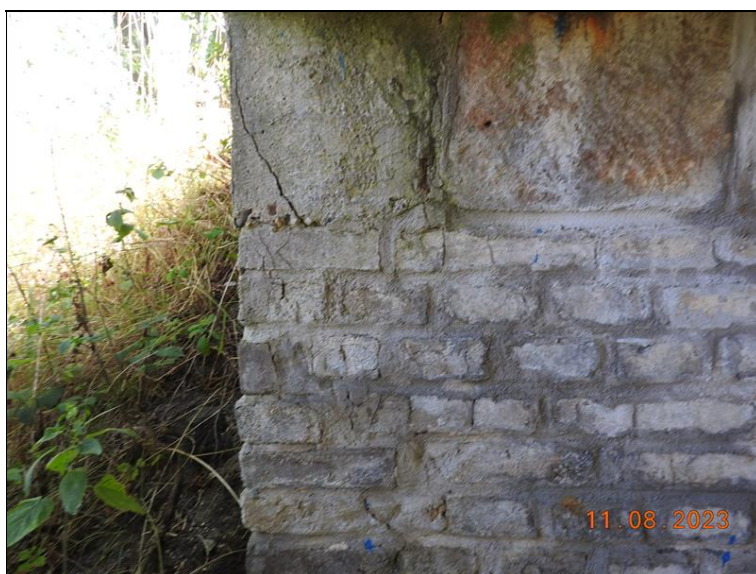
023_OP2 zleva_šikmé trhliny.JPG
