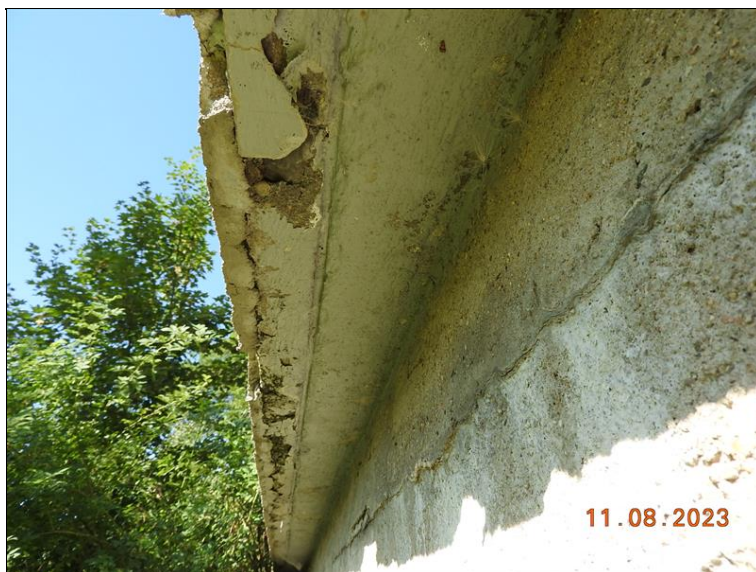
021_pravá římsa podhled_degradace betonu, odštíplé hrany.JPG
