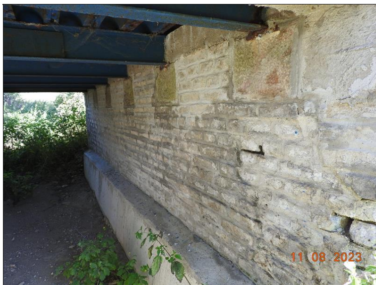
006_OP2_degradace zdiva, zatékání.JPG
