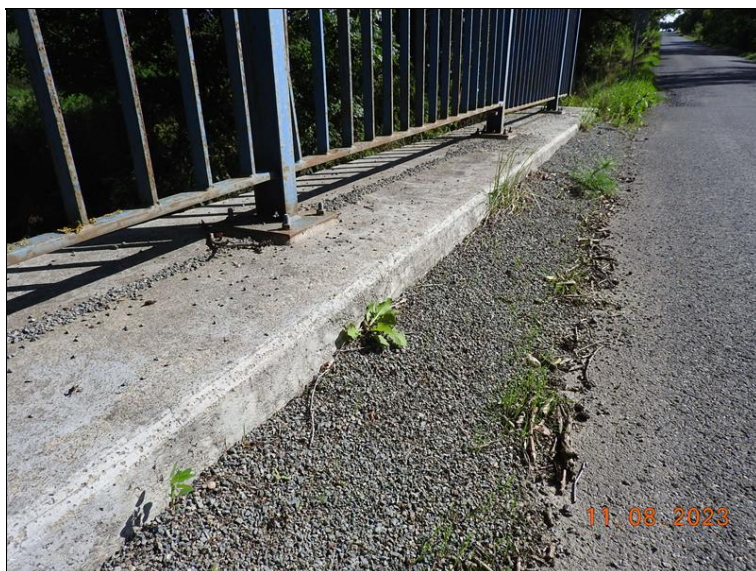
016_levá římsa_degradace betonu, výskyt smršťovacích trhlin.JPG
