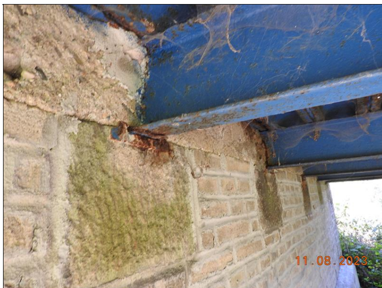
012_uložení NK na OP1_koroze.JPG
