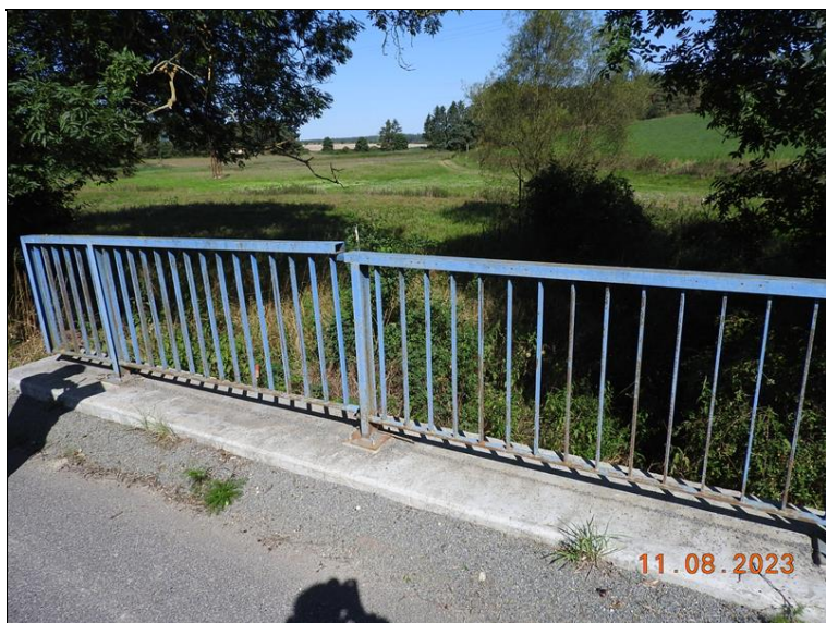
018_levé zábradlí_nevyhovuje ČSN, uvolněné dílce.JPG
