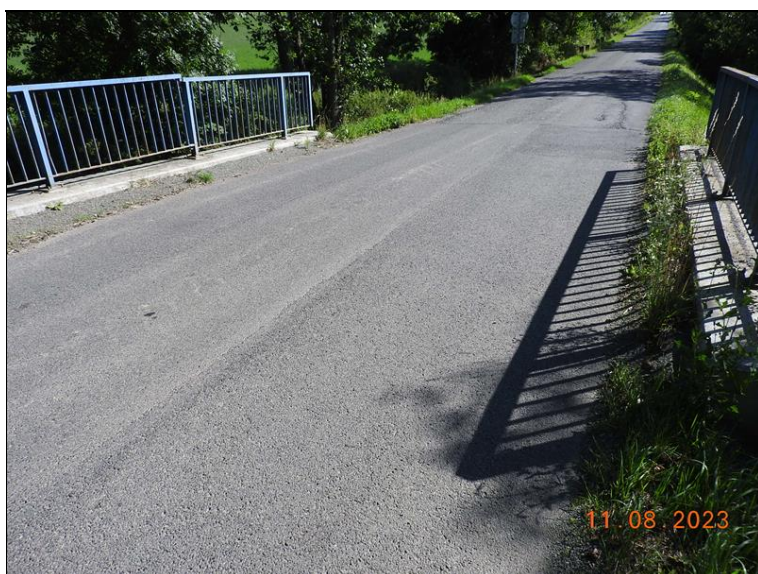
014_vozovka_zvlnění vegetace u krajnic.JPG
