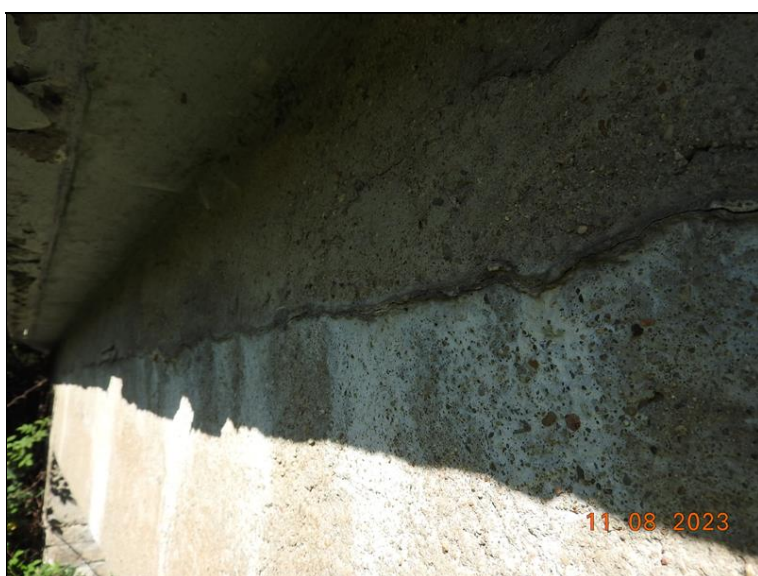
020_čelo NK zprava_detail_trhlina.JPG
