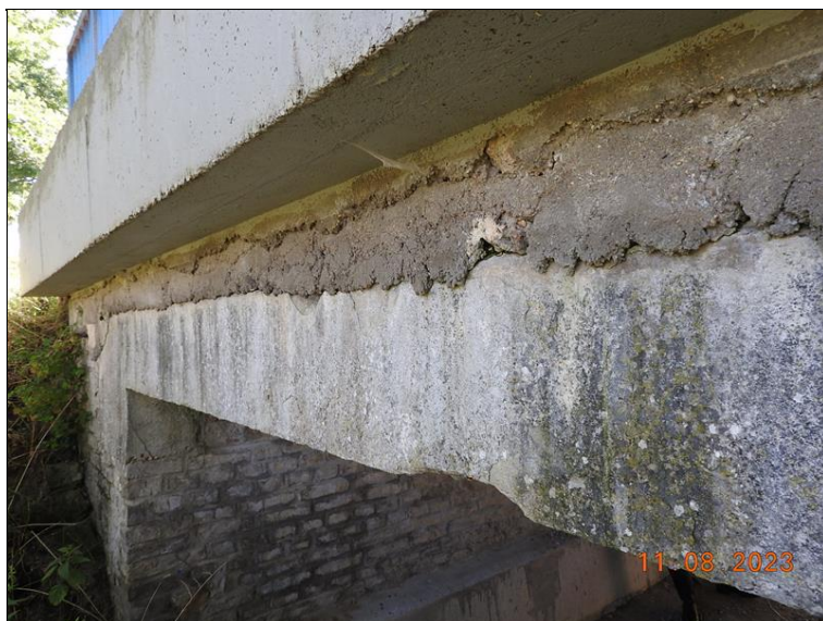
025_čelo NK vlevo_trhlina, stopy po zatékání.JPG
