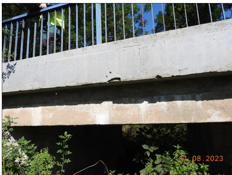
019_čelo NK zprava_vodorovná trhlina, stopy po zatékání.JPG
