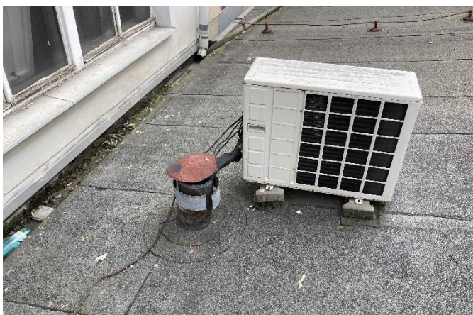
Foto /11/ Nesystémově řešený průstup střešním pláštěm
