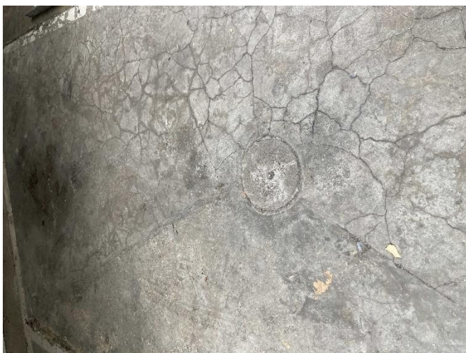
Foto /25/ Zabetonovaná podlahová vpust' v místě parkovacích stání
