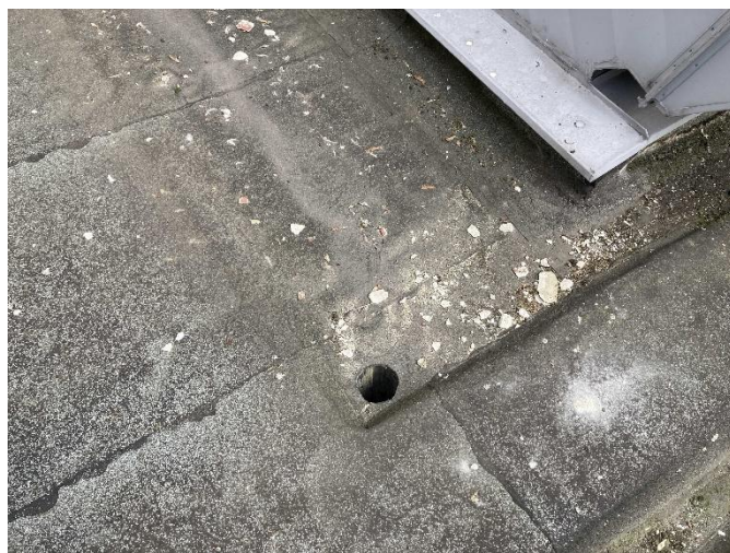
Foto /14/ Žádný vtok není opatřen krycím košem. Hrozí riziko ucpání odpadních potrubí.
