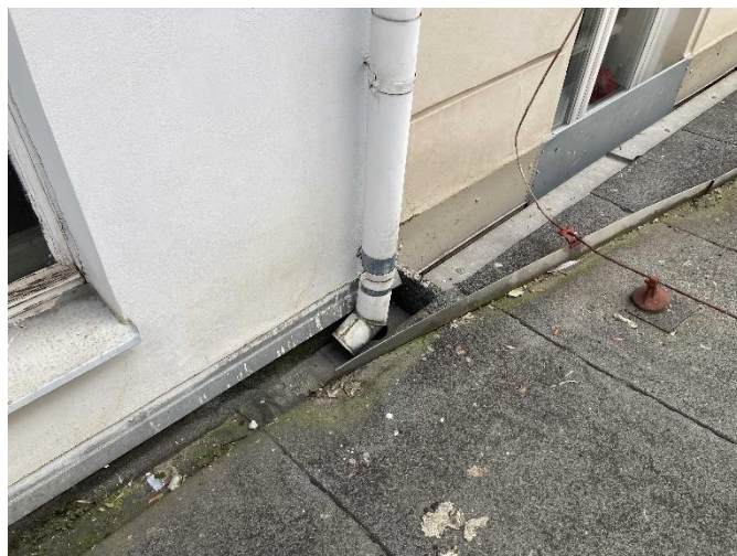
Foto /12/ Na předmětnou střechu jsou odvodněny i vyšší střechy navazujících objektů
