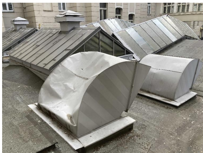
Foto /16/ Poškozené výdechy vzduchotechniky od padajícího sněhu a ledu z navazujících vyšších střech.
