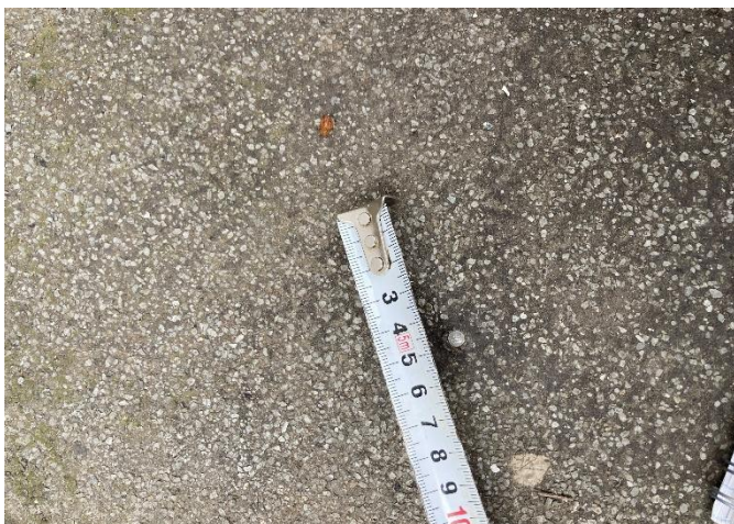
Foto /7/ Perforace hydroizolační vrstvy hřebíkem
