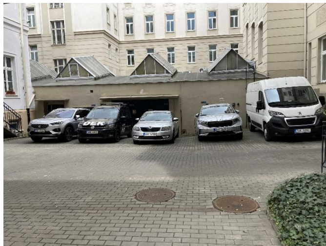
Foto /24/ Revizní šachty před objektem garáží kde dochází k napojení dešťových kanalizací do splaškové kanalizace.
