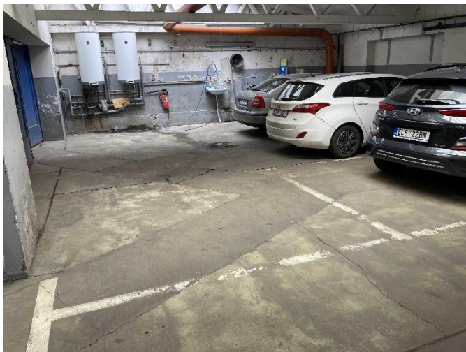
Foto /23/ Vizuálně jiný povrch betonové mazaniny po realizaci nového ležatého potrubí.
