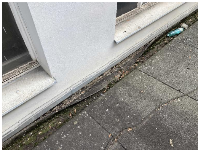
Foto /10/ Održená hydroizolace, možný zdroj zatékání do navazujícího objektu
