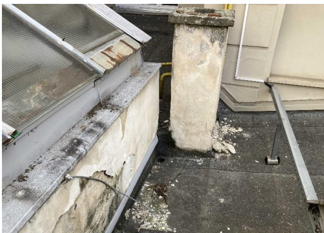
Foto /15/ Opadávající části omítky z navazujících konstrukcí
