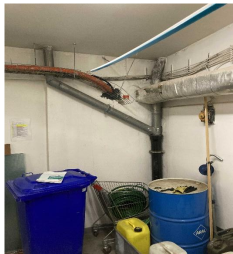
Foto /20/ Svodné potrubí pro vtoky V6 a V7.
