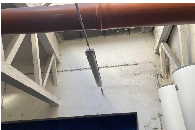
Foto /3/ Trhliny v nenosné cihelné přičce.
