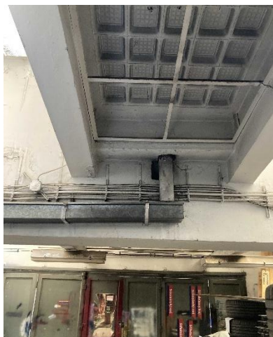
Foto /21/ Svodné potrubí pro vtok V9.
