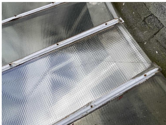
Foto /18/ Výplně z drátoskla jsou lokálně popraskané.
