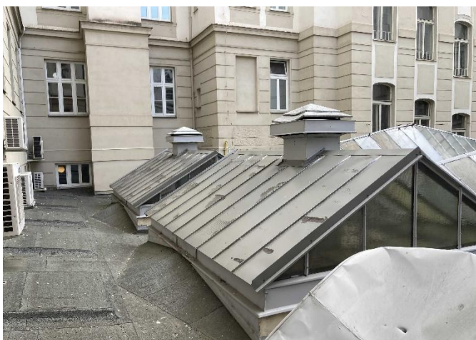
Foto /17/ V minulosti vyspravené světlíky. Drátosklo nahrazeno falcovanou plechovou krytinou.
