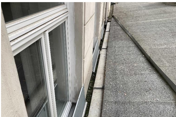
Foto /13/ Nevhodně řešený žlab u navazujícího objektu. Značné riziko zatečení do navazujících oken.
