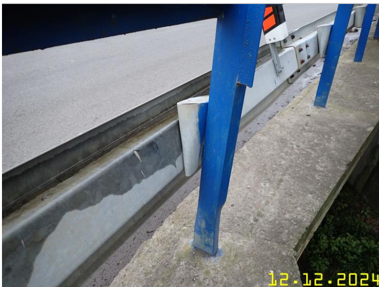
020 - poškozené deformační prvky svodidla na levé římse.jpg
