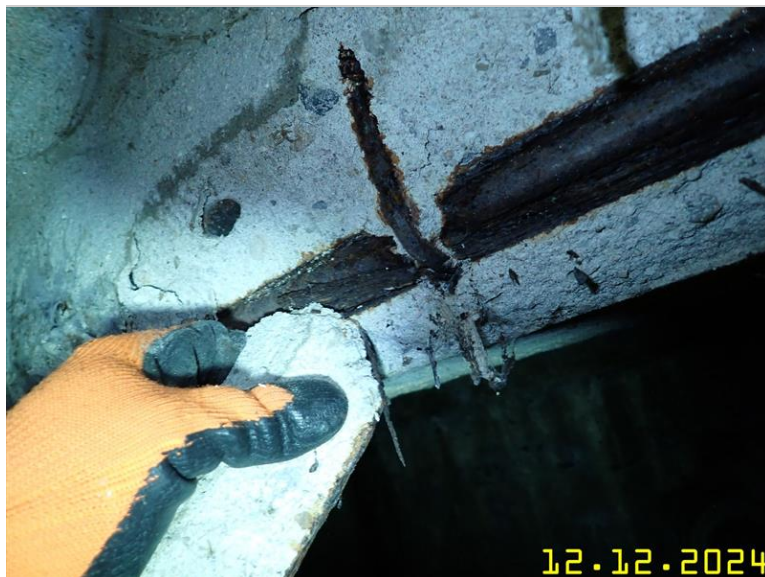
051 odpadávající beton kdyví vrstvy.jpg
