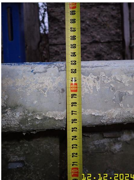
077 - výška svodnice na levé straně.jpg
