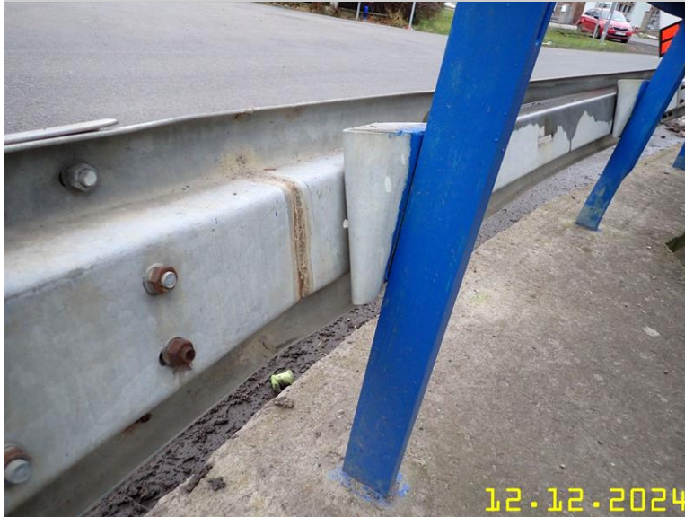
018 - poškozené deformační prvky svodidla na levé římse.jpg
