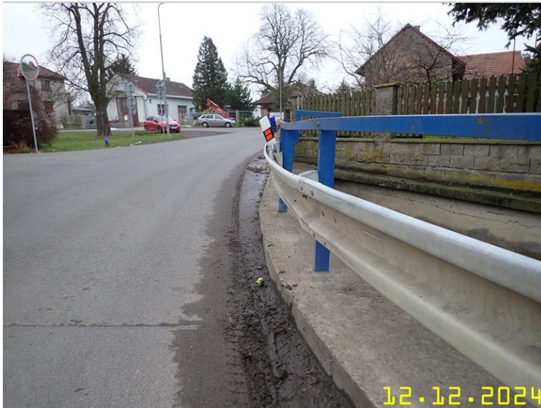
025 - krajnice u levé římsy deformovaná svodnice natočená.jpg
