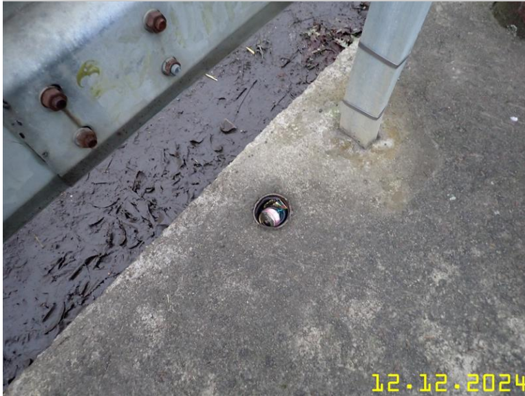
015 - horní povrch levé římsy a pozůstatky po DZ.jpg
