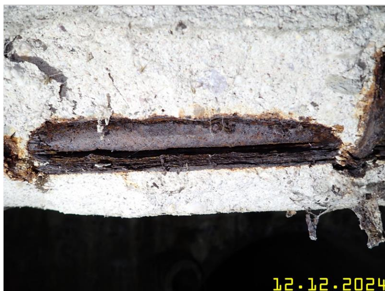
050 detail trémové konstrukce - detail koroze.jpg
