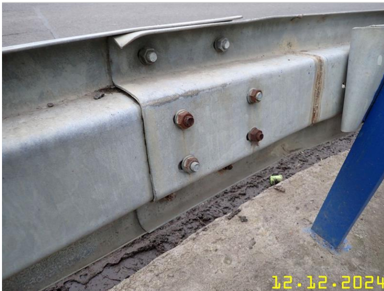
019 - spojovací materiál svodidla na levé římse.jpg
