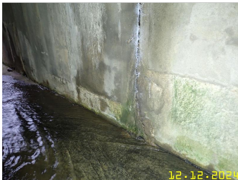
072 spára v opěrách O2.jpg
