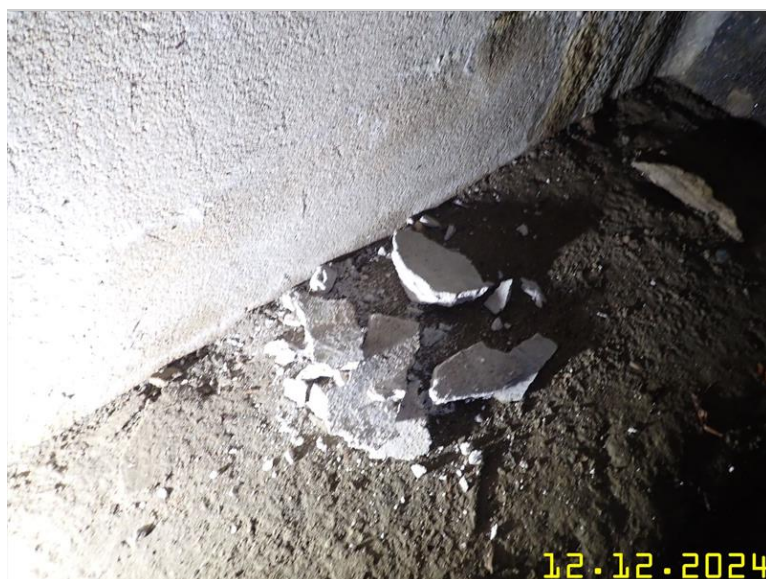
059 sdpadávající kusy betonu.jpg
