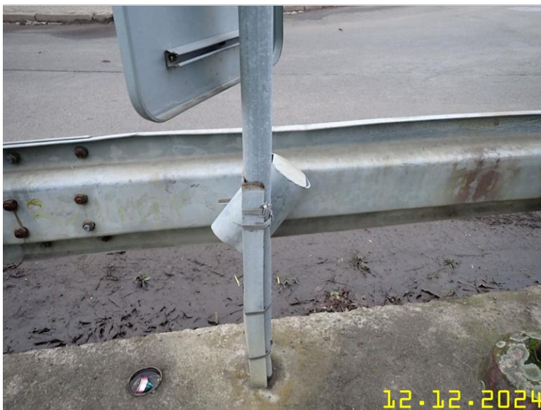
017 LŘ deformované prvky svodidla.jpg
