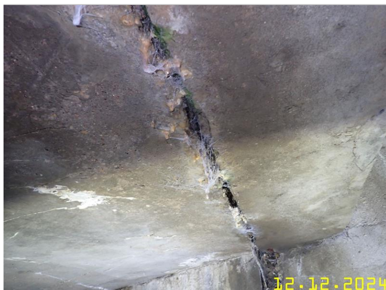
073 spára v podhledu desky.jpg
