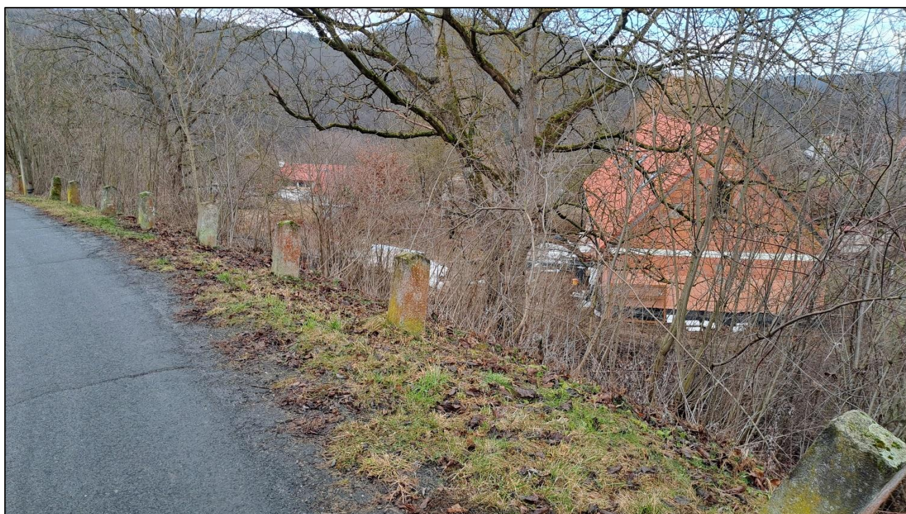
Foto 7: Silnice III/1044 - chybějící svodidlo
