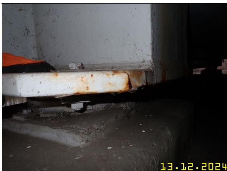
159 KOROZE A PKO NA O1L.JPG
