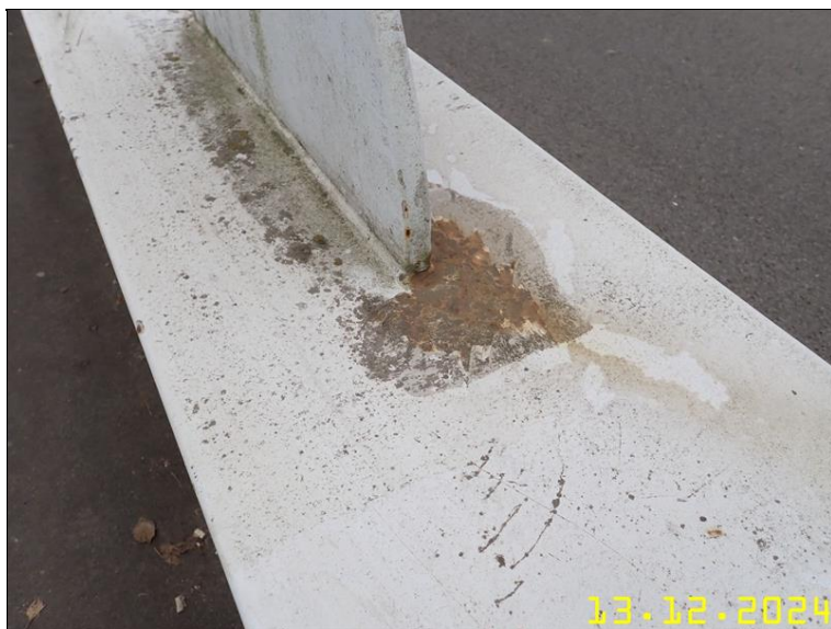
082 KOROZE ZÁVĚSU VLEVO.JPG
