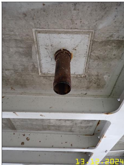
139 ODOVODNĚNÍ V PODHLEDU.JPG
