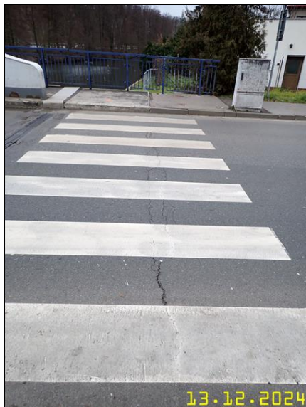
127 TRHLINA PŘÍČNÁ ZA O1.JPG
