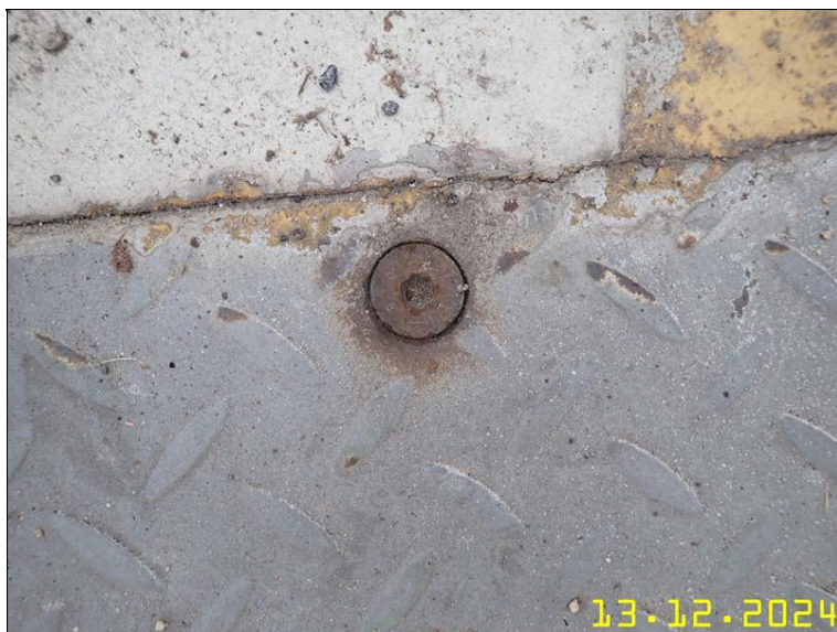
101 MDZ O2 KOROZE SPOJOVACÍHO MATERIÁLU.JPG
