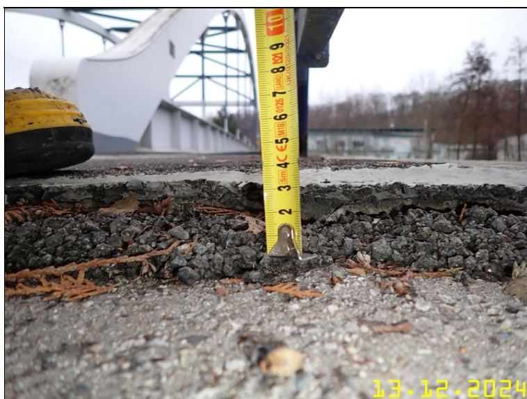
009 PŘ VÝŠKOVÝ ROZDÍL ŘÍMSA VS. PŘÍLEHLÝ CHODNÍK.JPG
