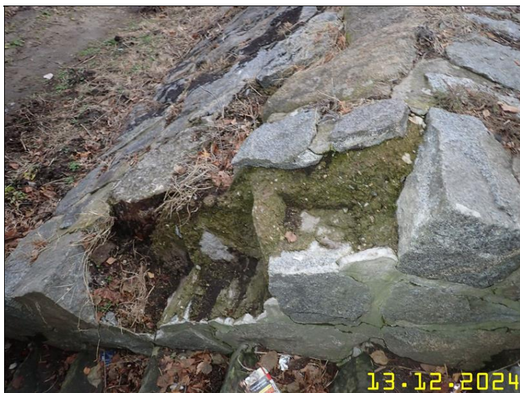
163 OPEVNĚNÍ KORYTA V BLÍZKOSTI.JPG
