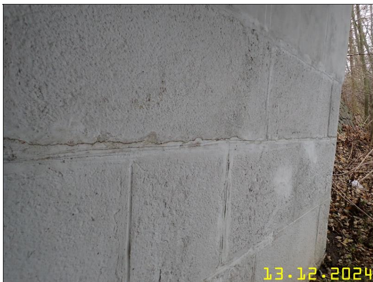
182 TRHLINY V O2.JPG
