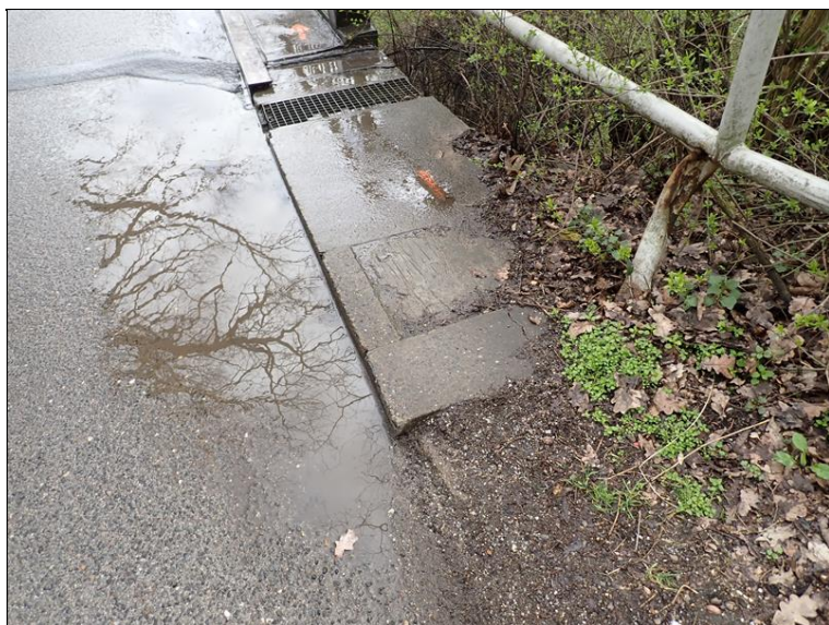
Okraj vozovky na začátku mostu vpravo.
