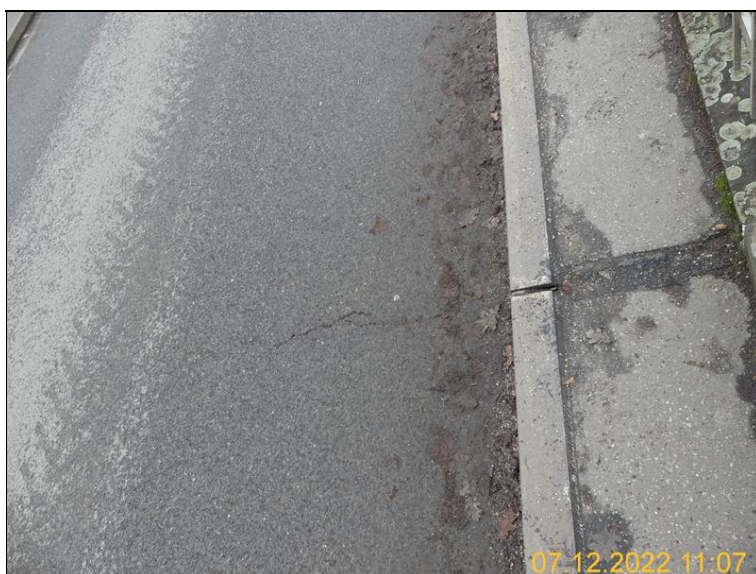
Trhlina ve vozovce na závěru ve 4. poli u P5
