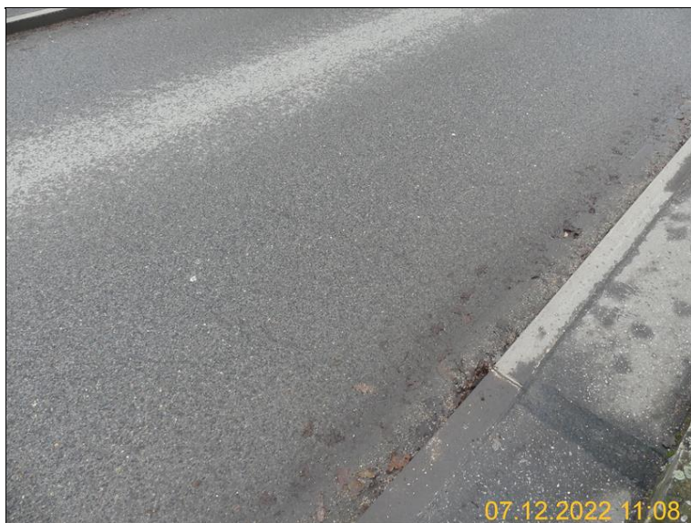
Trhliny ve vozovce na závěru ve 4. poli u P4
