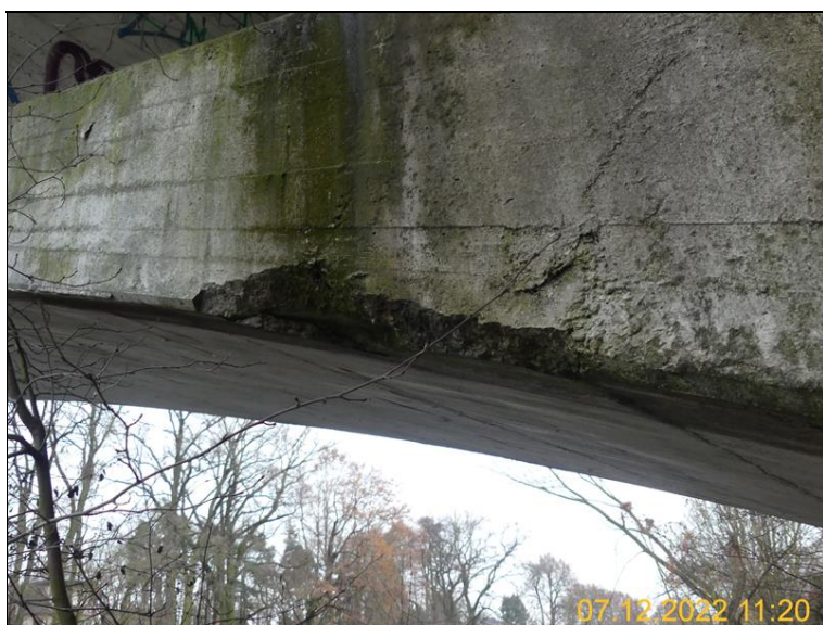
Průsaky a odkrytá korodující výstuž na nosné konstrukci 4. pole
