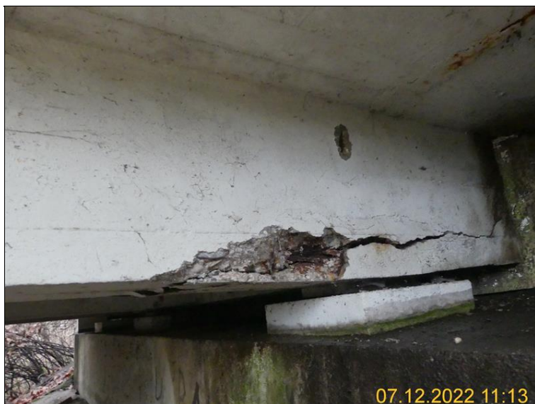
Trhlina v rámu nad ložiskem OP1
