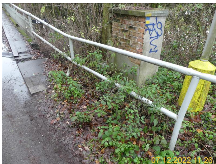
Zdeformované zábradlí vpravo před mostem
