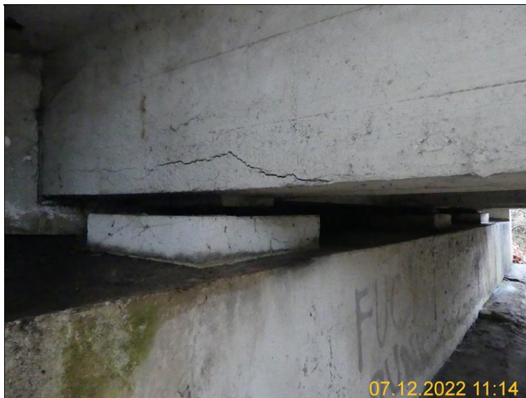
Trhlina v trámu na nadzvedlém ložiskem na OP1
