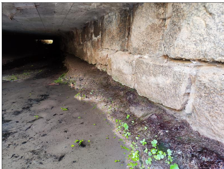
O2 - plošně poruchy spárování, lokálně vadrolené, trhliny
