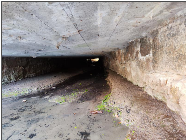
Podhled NK - lokálně stopy po korozi výztuže
