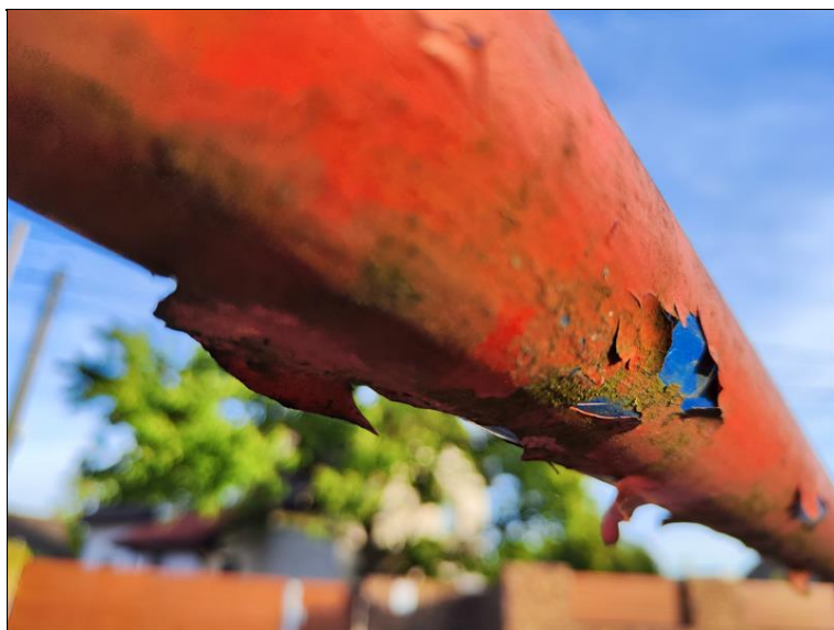
Zábradlí PKO - na konci životnosti, separace vrchní vrstvy
