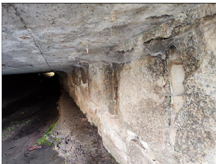
O2 - plošně poruchy spárování, lokálně vadrolené, trhliny
