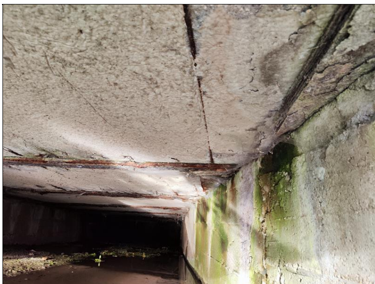
Podhled NK - koroze ocelových nosníků a odhalené výztuže, plošně povrchová degradace betonu,
