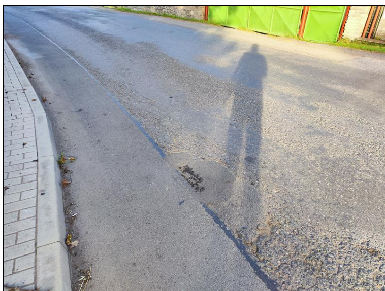
vozovka na mostě - lokálně vysparovaná, trhliny a počínající výtluky
