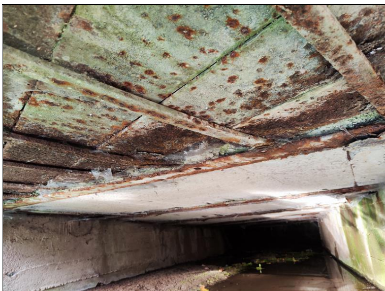
Podhled NK vlevo - koroze kovových částí NK
