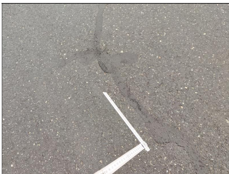
vozovka na mostě - poruchy
