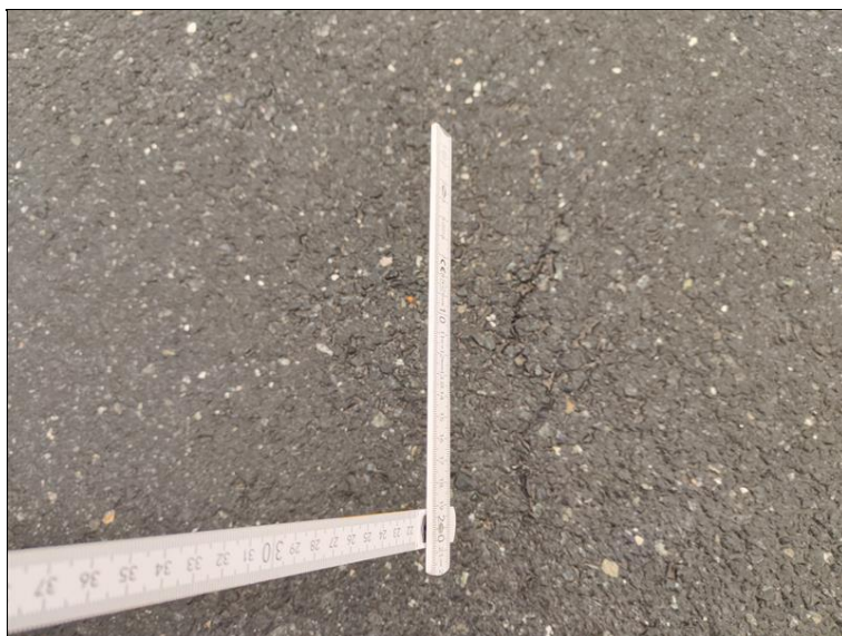
vozovka na mostě - poruchy
