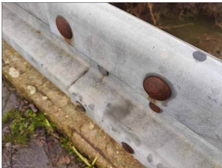
Zádržný systém vpravo - koroze spojovacího materiálu
