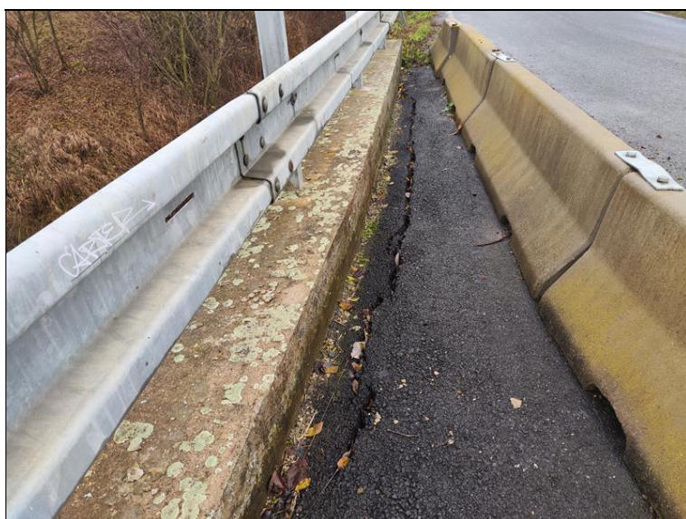
Trhlina ve vozovce vlevo
