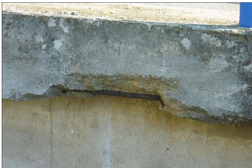
Odpadlý beton na římse L.
