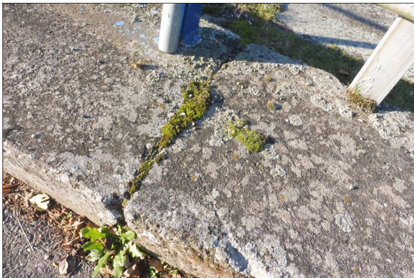
Trhlina v římse.
