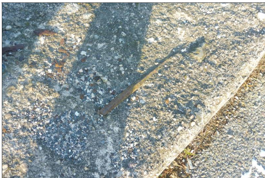
malá krycí vrstva + odhalená korodující výztuž na horním povrchu římsy.
