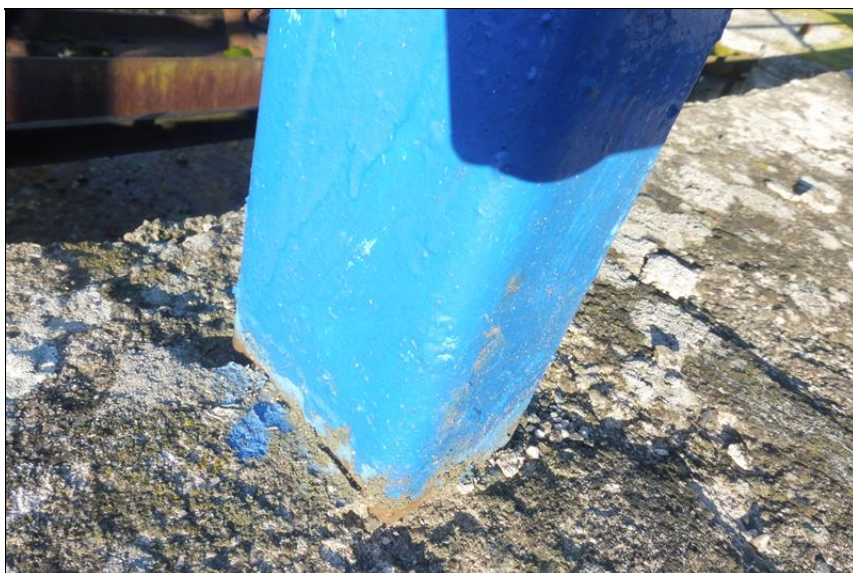
Koroze v patě sloupku.
