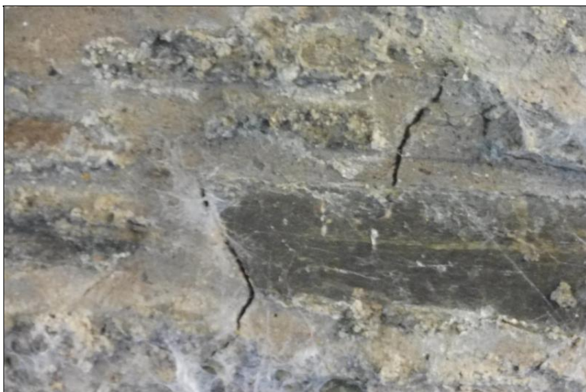
Trhliny v KZ opěry.
