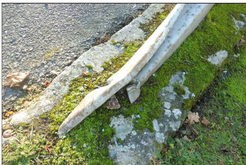
Poškozená svodnice L.
