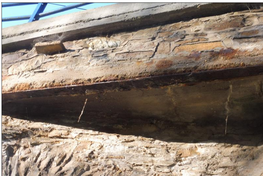
Koroze oc. nosníků rozšíření P.
