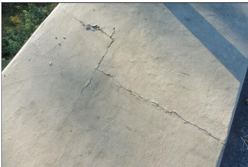
Trhlina v římse.
