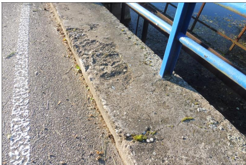
degradace betonu horního povrchu římsy.
