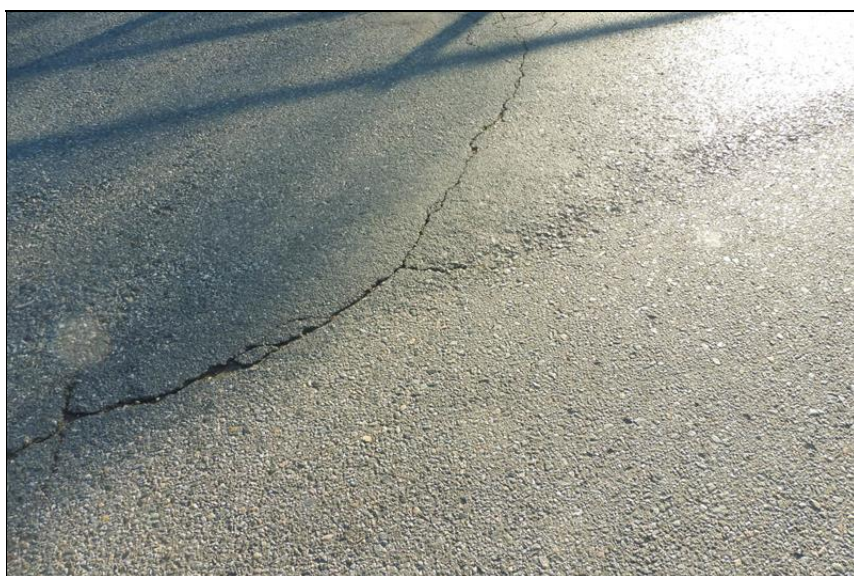
Trhliny ve vozovce.
