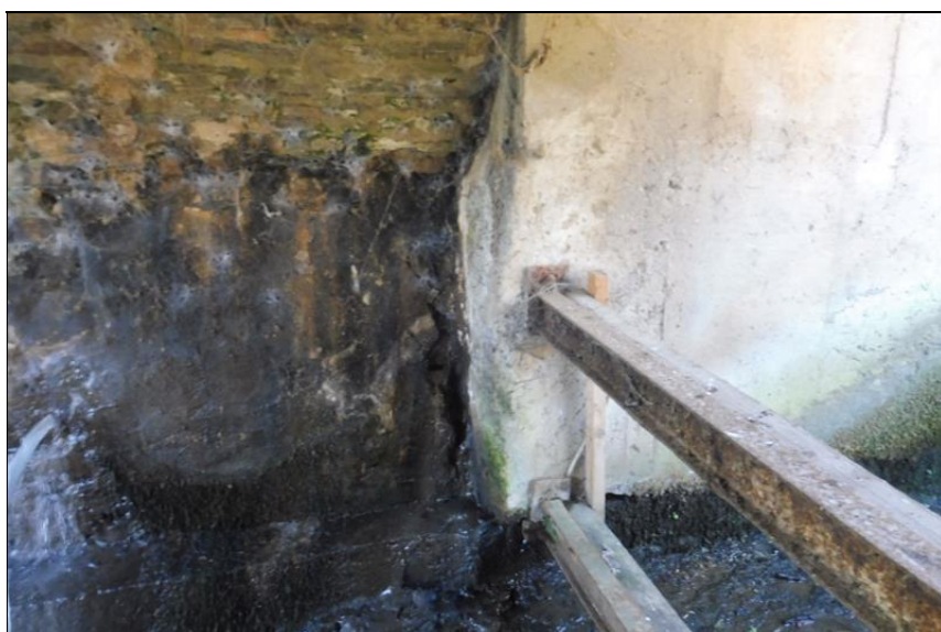
Spára v opěře na styku klenby a rozšíření.
