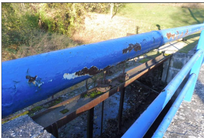
Poškozená PKO zábradlí.
