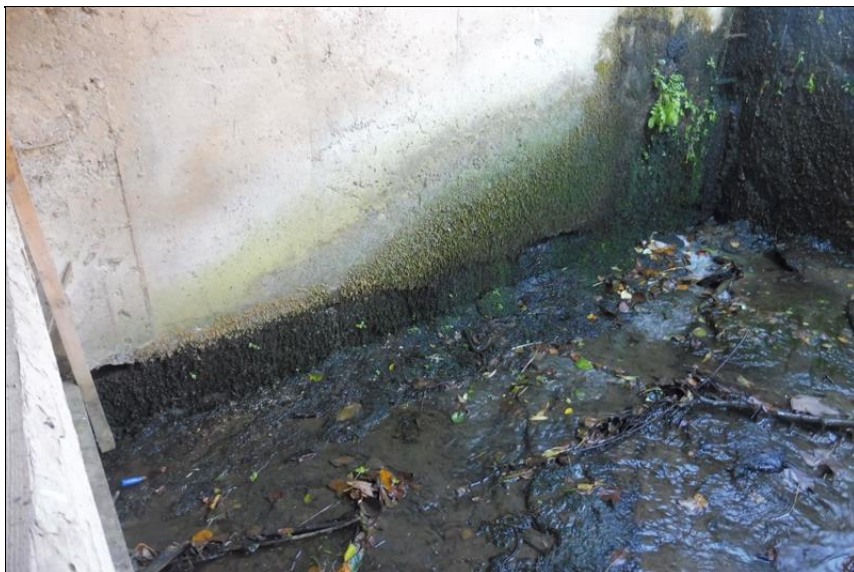
degradace betonu v úr. hladiny v patě op.
