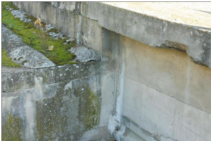
Odpadlý beton na římse L, výlhy na boku NK.
