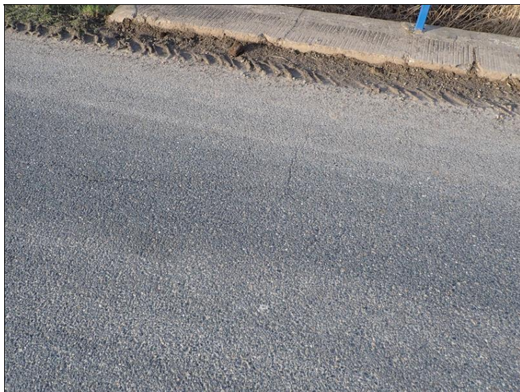
PC270670-2023.12.27_T15.06.jpg Trhliny nad opěrou 2 - podélná a příčná.
