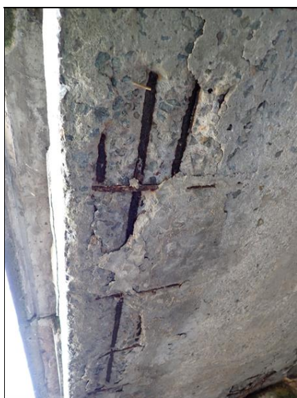
PC270709-2023.12.27_T15.12.jpg Separace krycí vrstvy na levé straně mostu.
