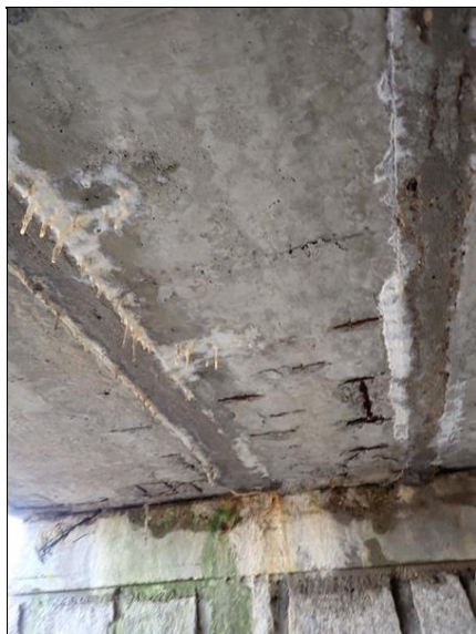
PC270701-2023.12.27_T15.11.jpg Výluhy pojiva ze spár mezi nosníky, separace krycí vrstvy.
