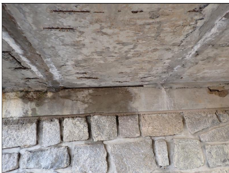
PC270699-2023.12.27_T15.11.jpg Zatékání na úložný práh, výluhy pojiva, separace krycí vrstvy výztuže. Výluhy pojiva ze spár mezi nosníky.
