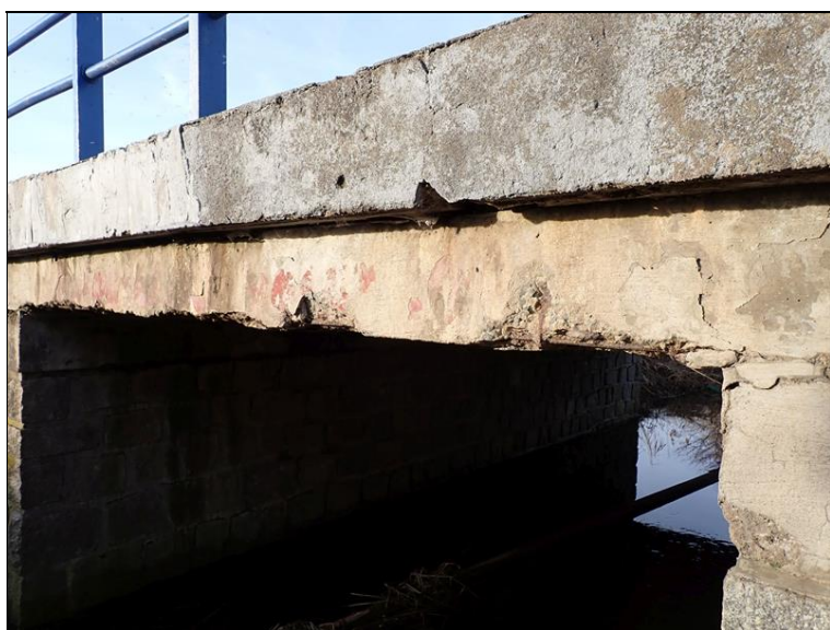
PC270677-2023.12.27_T15.07.jpg Separace krycí vrstvy výztuže na boku nosné konstrukce.
