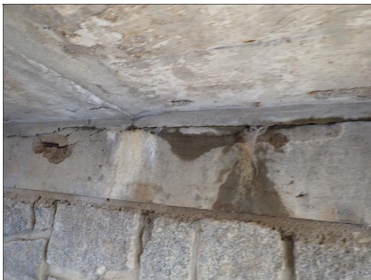
PC270696-2023.12.27_T15.11.jpg Zatékání na úložný práh, výluhy pojiva, separace krycí vrstvy výztuže.
