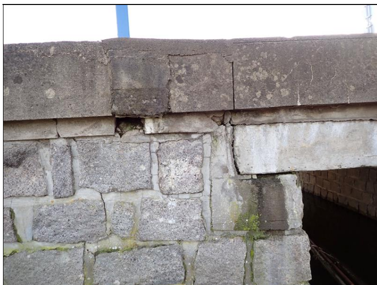
PC270681-2023.12.27_T15.07.jpg Zatékání na úložný práh opěry 2 vlevo. Degradace spádového betonu na nosné konstrukci.
