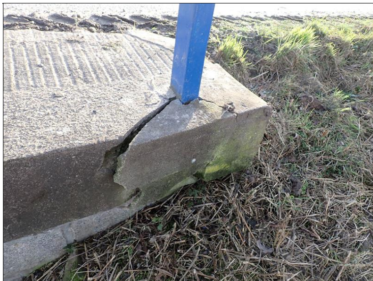
PC270710-2023.12.27_T15.12.jpg Odražená hrana římsy snižuje únosnost zábradlí.
