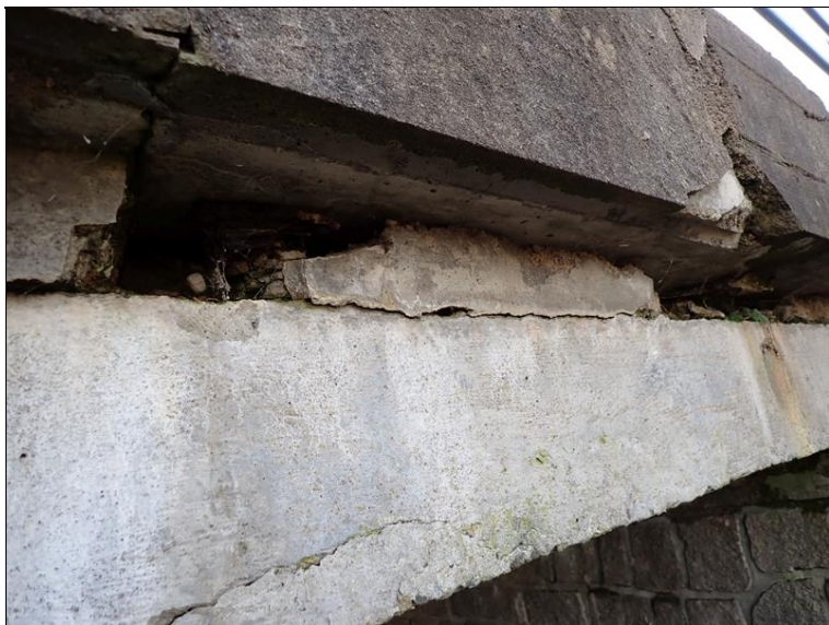
PC270682-2023.12.27_T15.08.jpg Degradace a vypadávání spádové vrstvy betonu na nosnících. Levá strana mostu.
