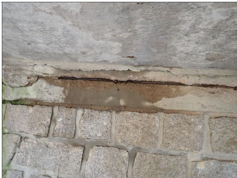
PC270694-2023.12.27_T15.11.jpg Zatékání na úložný práh, separace krycí vrstvy výztuže.
