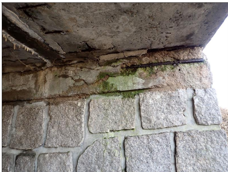
PC270705-2023.12.27_T15.12.jpg Zatékání na úložný práh, výluhy pojiva, separace krycí vrstvy výztuže. Výluhy pojiva ze spár mezi nosníky, separace krycí vrstvy.
