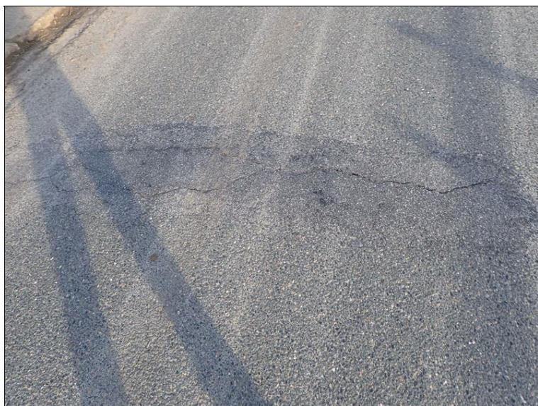
PC270671-2023.12.27_T15.06.jpg Příčná trhlina nad opěrou 2 - v místě očekávaných dilatačních pohybů.
