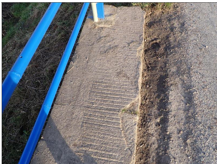
PC270714-2023.12.27_T15.13.jpg Příčná trhlinka v levé římse.
