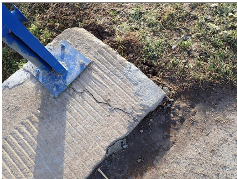
PC270686-2023.12.27_T15.08.jpg Příčná trhlina v levé římsě.
