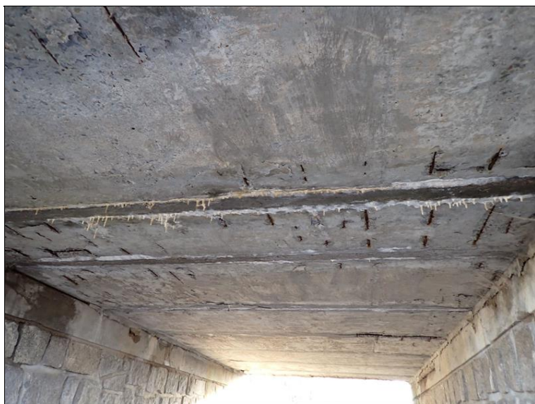
PC270707-2023.12.27_T15.12.jpg Podhled nosné konstrukce - výluhy ve spárách mezi prefabrikáty, separace krycí vrstvy.
