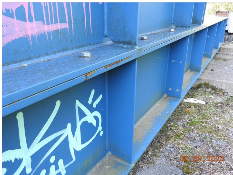
006_Pravý bok NK. Degradace nátěru, lokální koroze a bionapadení.jpg
