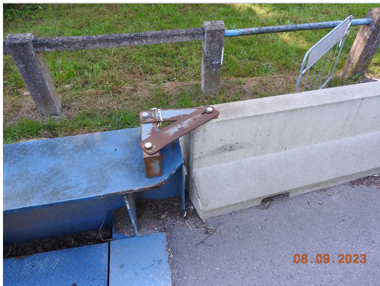
017_Zakončení levého nosníku u OP2. Plošná koroze.jpg
