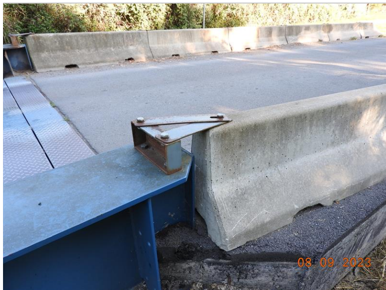
014_Zakončení levého nosníku u OP1. Plošná koroze.jpg
