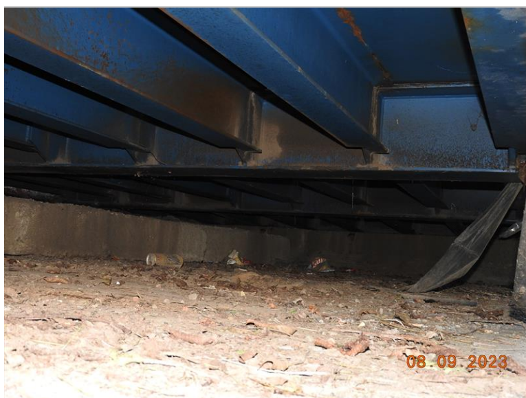
028_Podhled NK protisměr. Lokální plošná korozie.jpg
