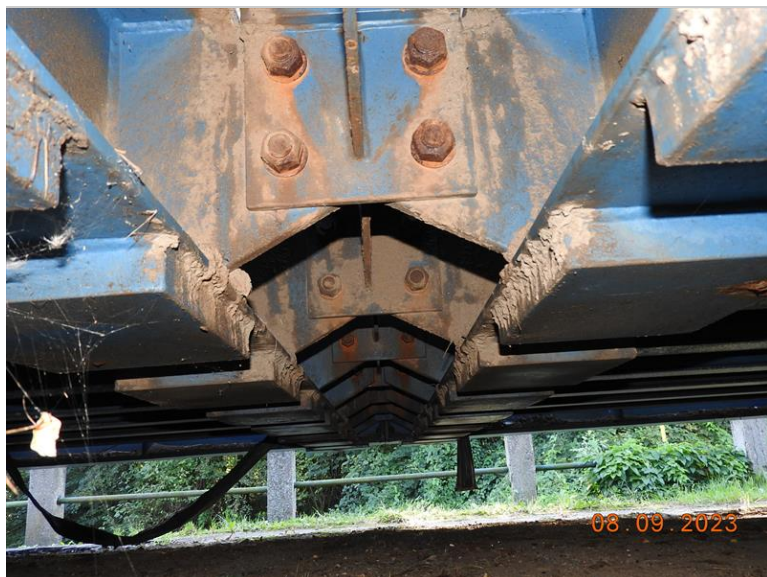
009_Podhled uprostřed rozpětí. Koroze spojovacích prvků.jpg
