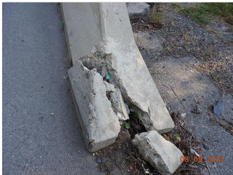
021_Svodidlo vlevo u OP2 detail. Rozpad betonu.jpg
