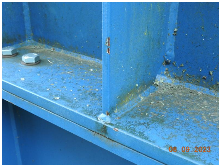
025_Levý bok NK detail. Začínající koroze.jpg
