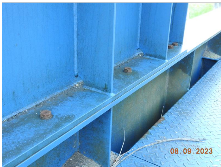
008_Levý bok NK. Koroze spojovacích prvků.jpg
