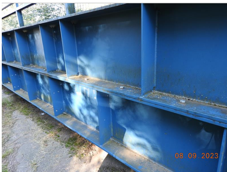
007_Levý bok NK. Degradace nátěru a bionapadení.jpg
