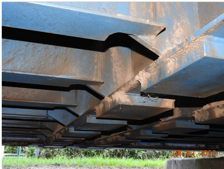
026_Podhled NK. Lokální povrchová korozie.jpg
