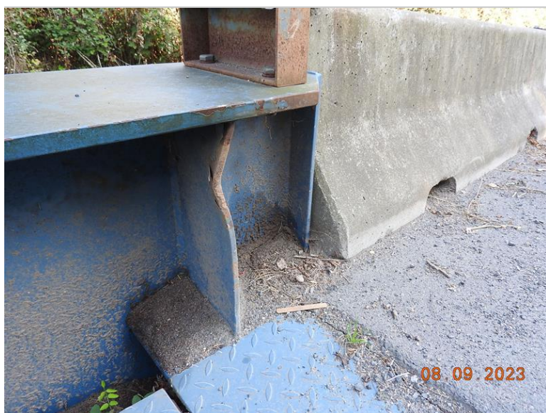
016_Zakončení pravého nosníku u OP1. Deformace stojiny.jpg
