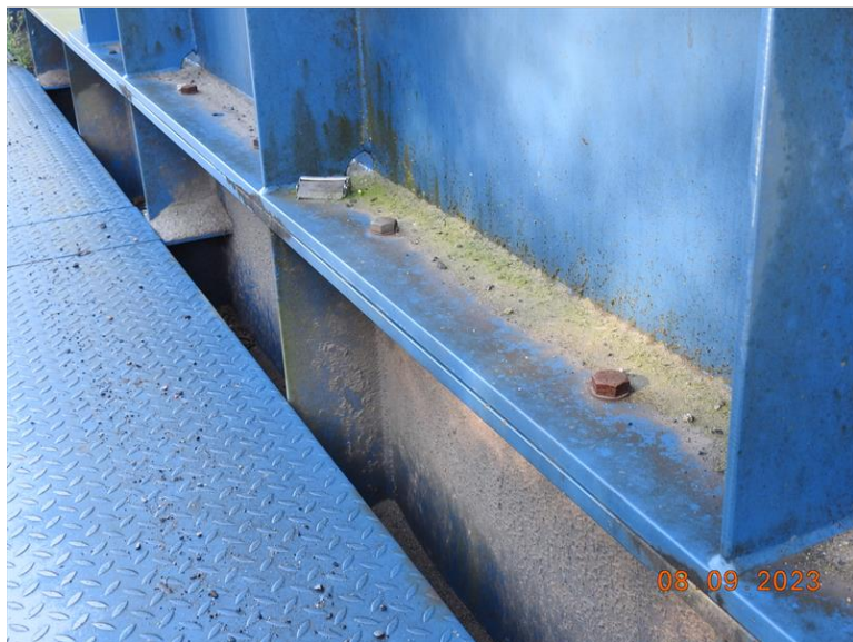
005_Pravý bok NK. Koroze spojovacích prvků, zanesení a bionapadení.jpg
