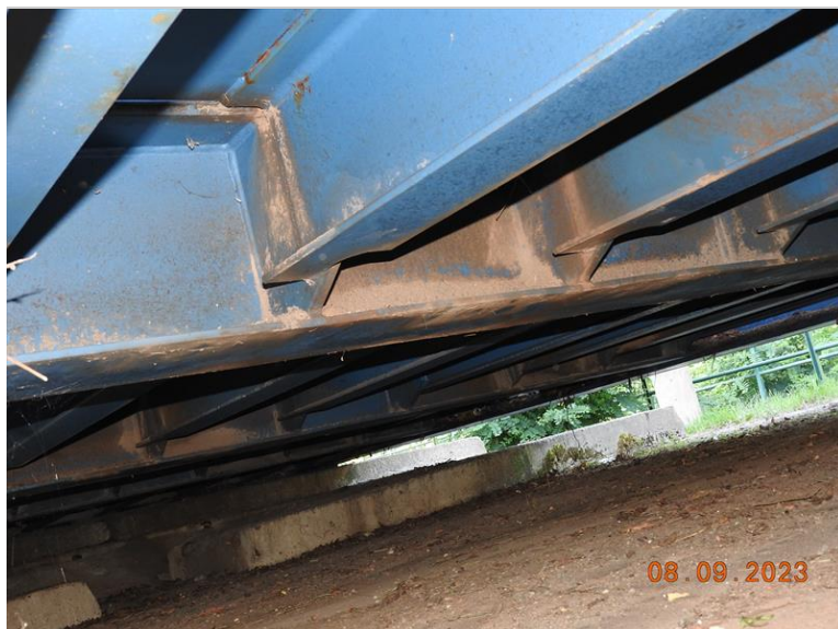
027_Podhled NK po směru. Lokální povrchová korozie.jpg
