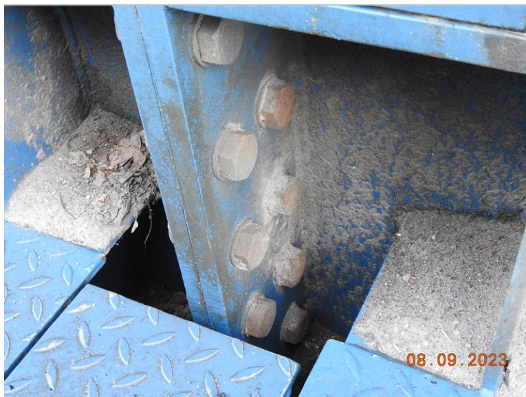
030_Pravý bok spojovací prvky. Koroze šroubů.jpg
