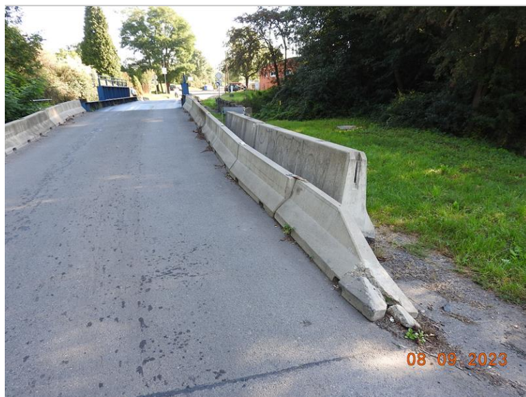
020_Svodidlo vlevo u OP2. Vychýlení svodidla, degradace betonu.jpg
