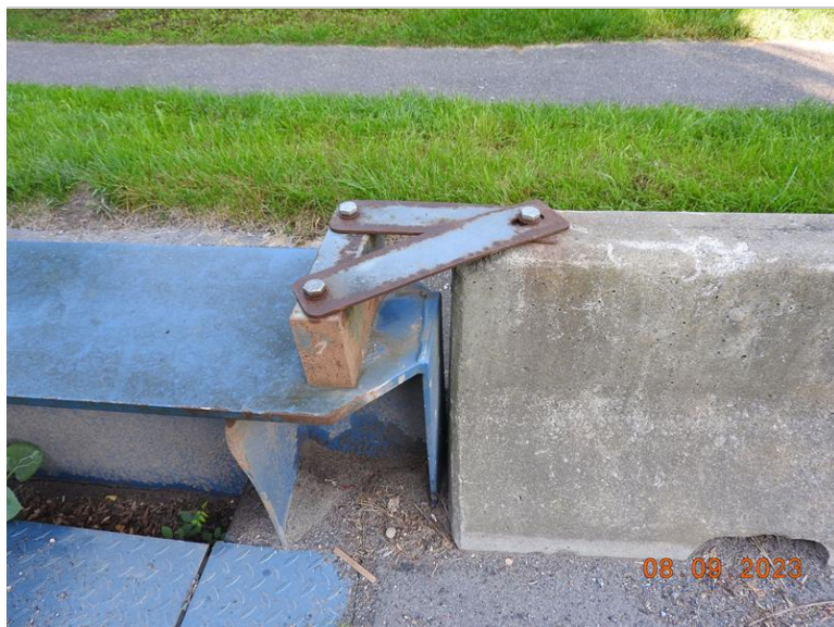
015_Zakončení pravého nosníku u OP1. Plošná koroze.jpg
