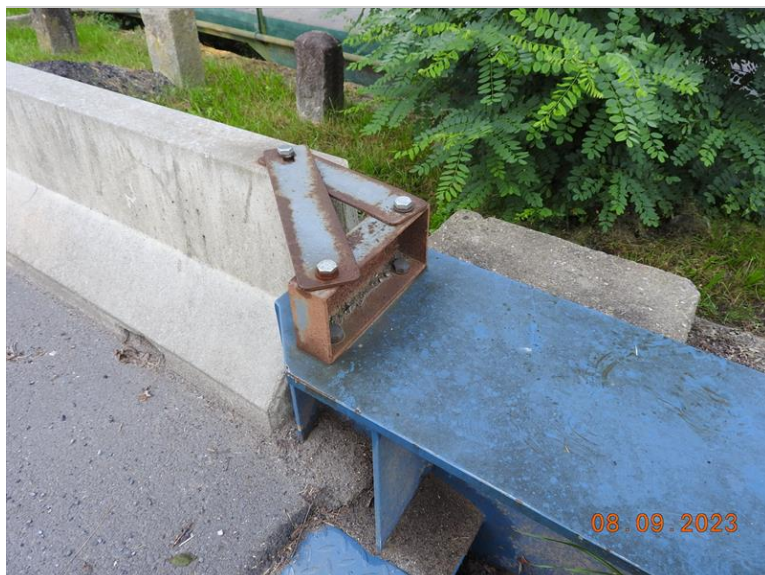
018_Zakončení pravého nosníku u OP2. Plošná koroze.jpg
