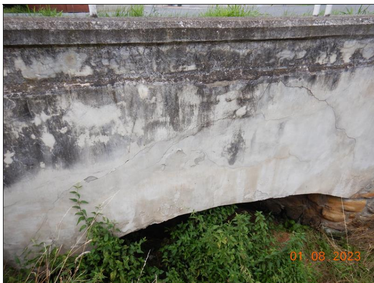
009_Čelo NK zleva. Výskyt trhlin..jpg
