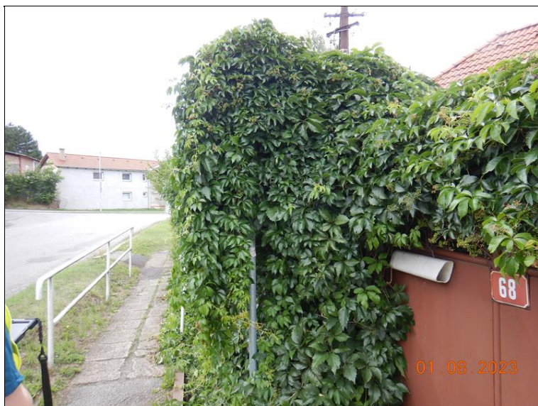
006_SDZ vpravo. Zarostlé SDZ omezující zatížitelnost na mostě a evidenční číslo..jpg
