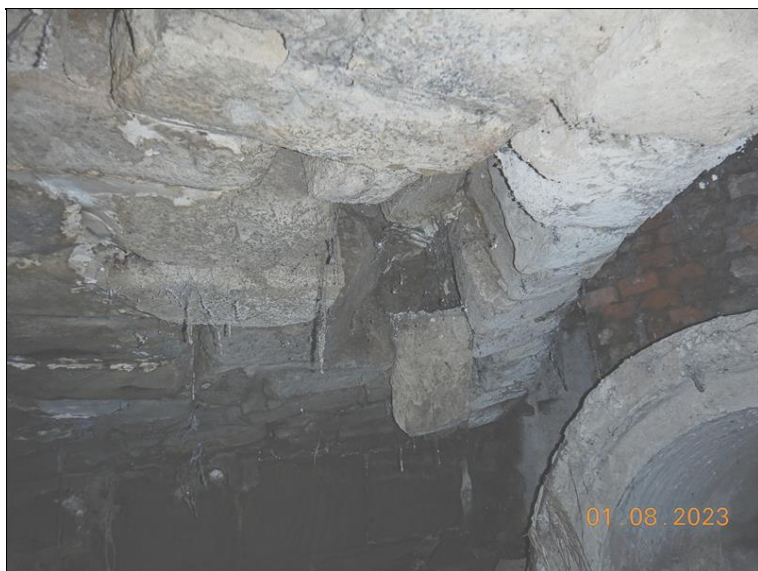
016_Podhled NK u OP2 zprava. Chybějící zdivo klenby..jpg
