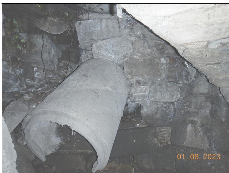
014_OP2 zprava - detail. degradace zdiva vyvalené zdivo..jpg
