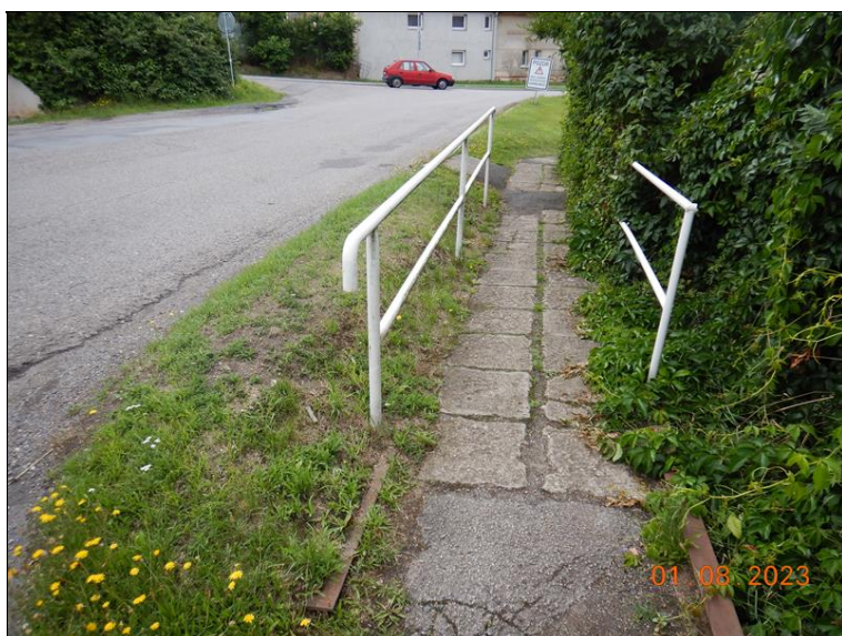
007_Chodník vpravo. Degradace pochozí plochy..jpg
