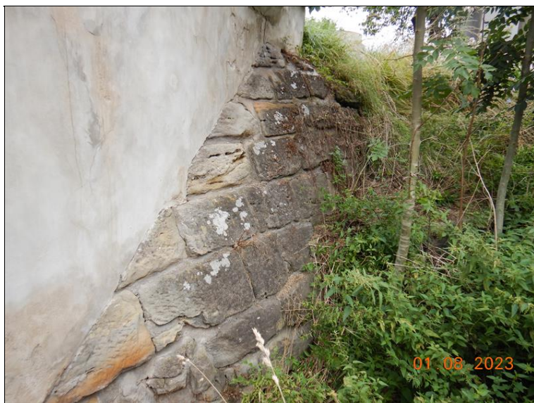
004_Levé křídlo OP1. Povrchová degradace zdiva výskyt vegetace..jpg
