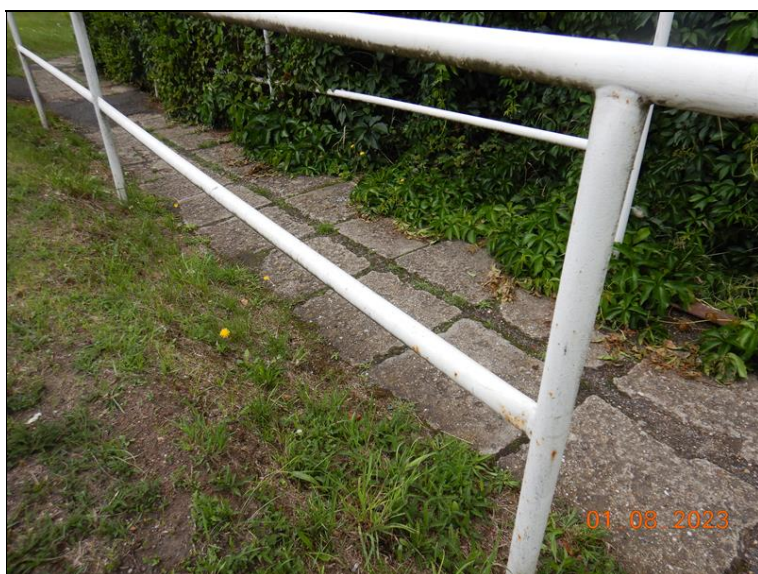
008_Zábradlí vpravo. Lokální degradace nátěru koroze. .jpg
