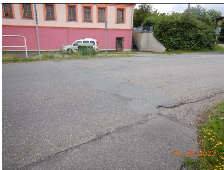
005_Vozovka. Lokálně trhliny a výtlučky..jpg
