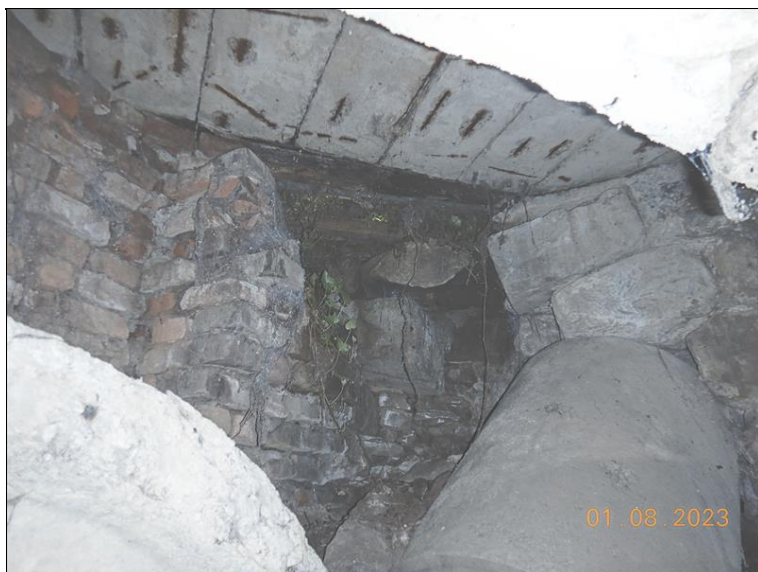
015_OP2 zprava - detail. Degradace zdiva zatékání..jpg
