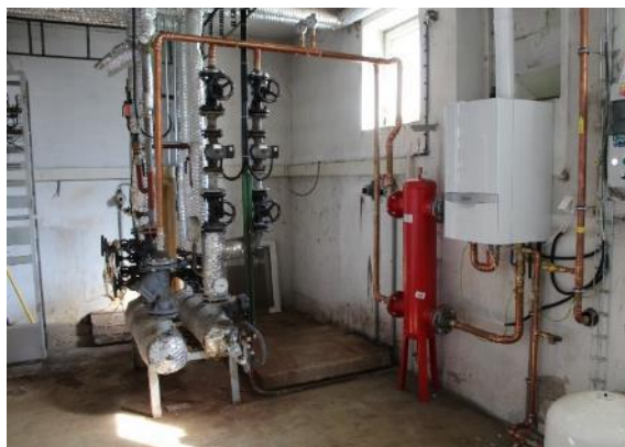
Obr. 8: Zdroj tepla a R+S pro tělocvičnu
