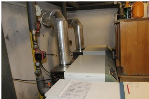
Obr. 17: Zdroj tepla – budova A
