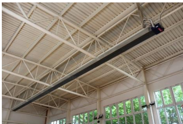
Plynový zářič - tělocvična
