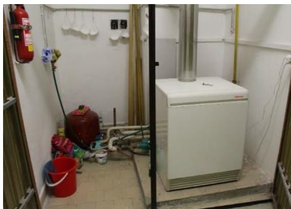
Obr. 19: Zdroj tepla – budova B
